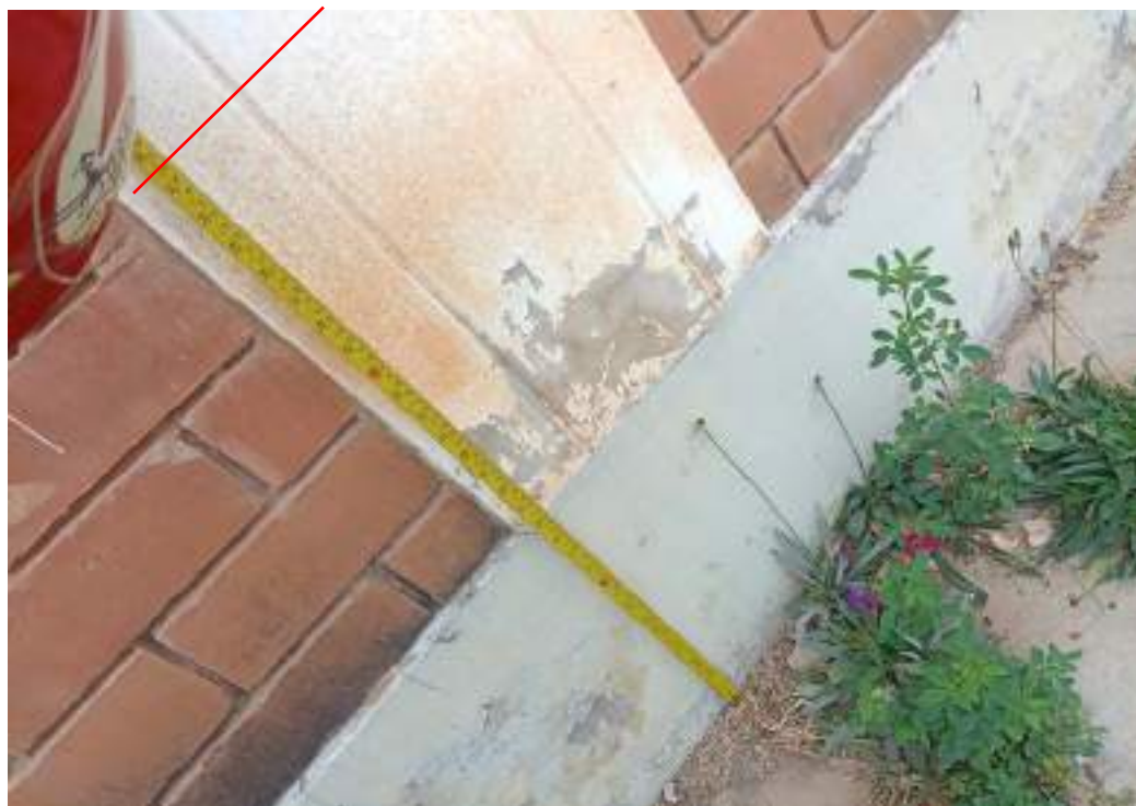
Figura 75.-La huella hídrica es de 0.80 metros en la calle Mutuy.
