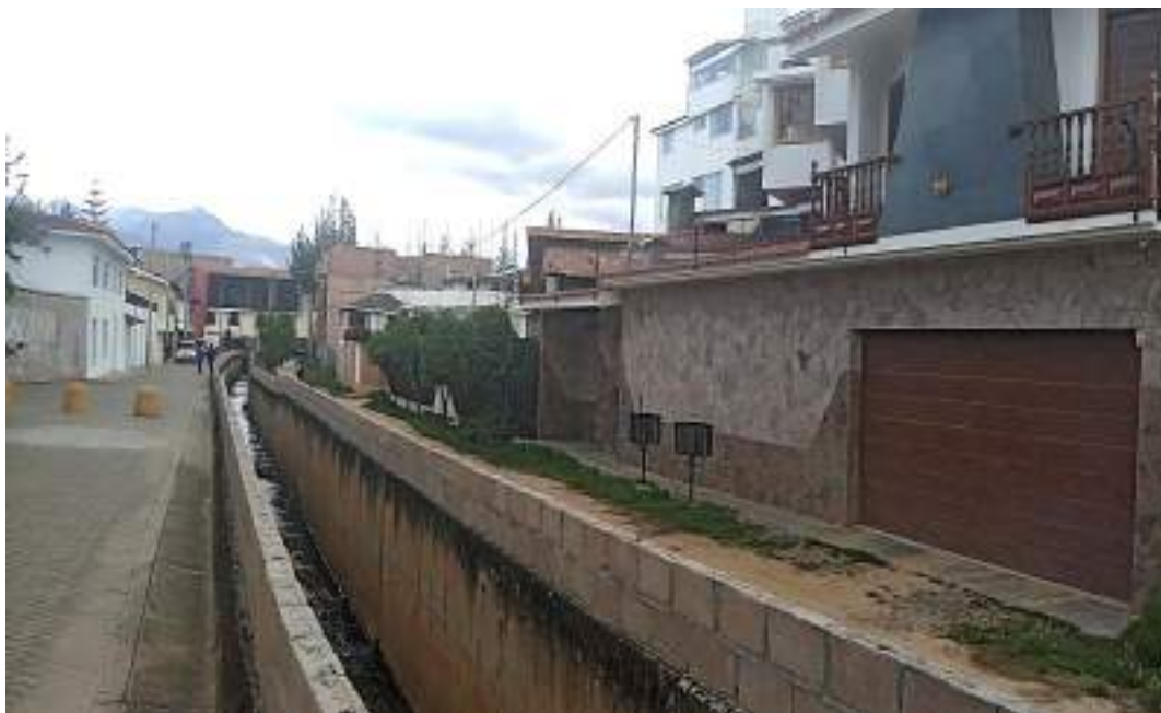
Figura 25.- Se detalla la casa en la parte urbana (zona residencial), se observa colocaron 2 hiladas de ladrillo para evitar desbordamiento de la quebrada.
