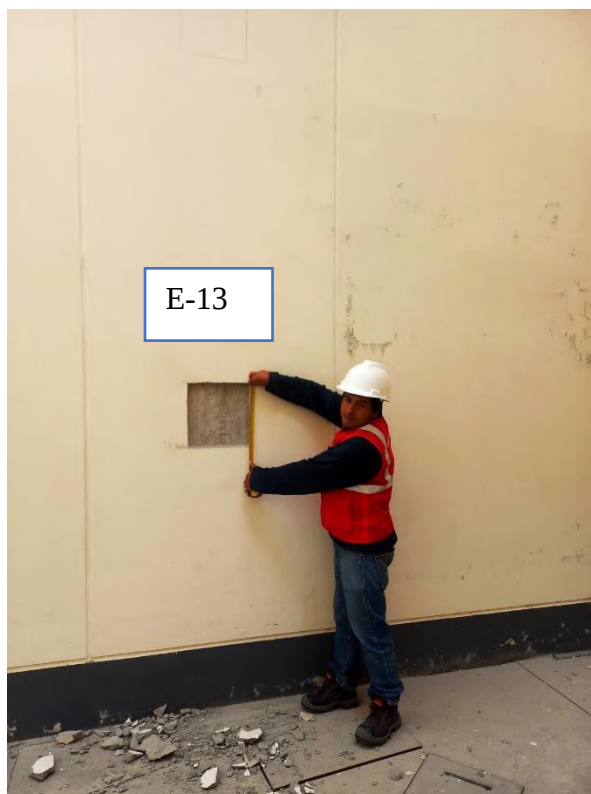
Ensayo de esclerometría en columna muestra E-13
