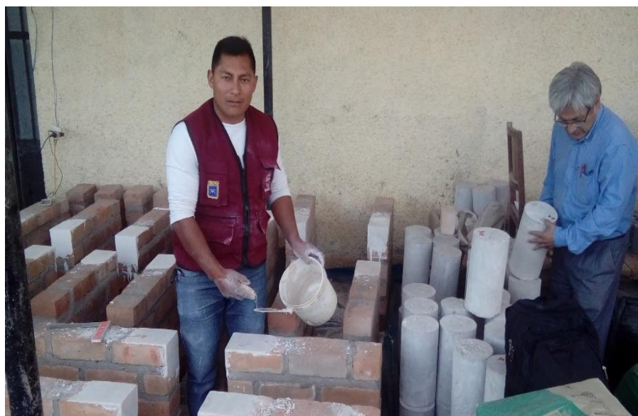
Fig. 45: Vista de la colocación de yeso en las esquinas de los muretes de ladrillo artesanal de Bambamarca
