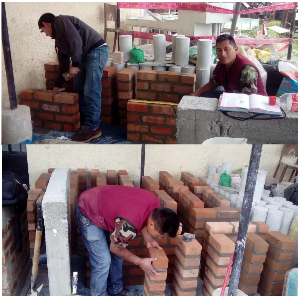
Fig. 43: Vista de la construcción de pilas y muretes de ladrillo artesanal de Bambamarca.
