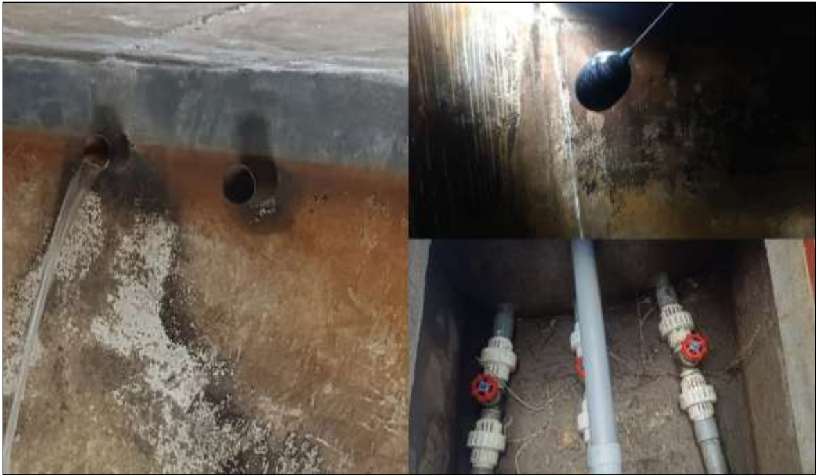
Figura 44 Elementos de reservorio de agua La Guabilla
