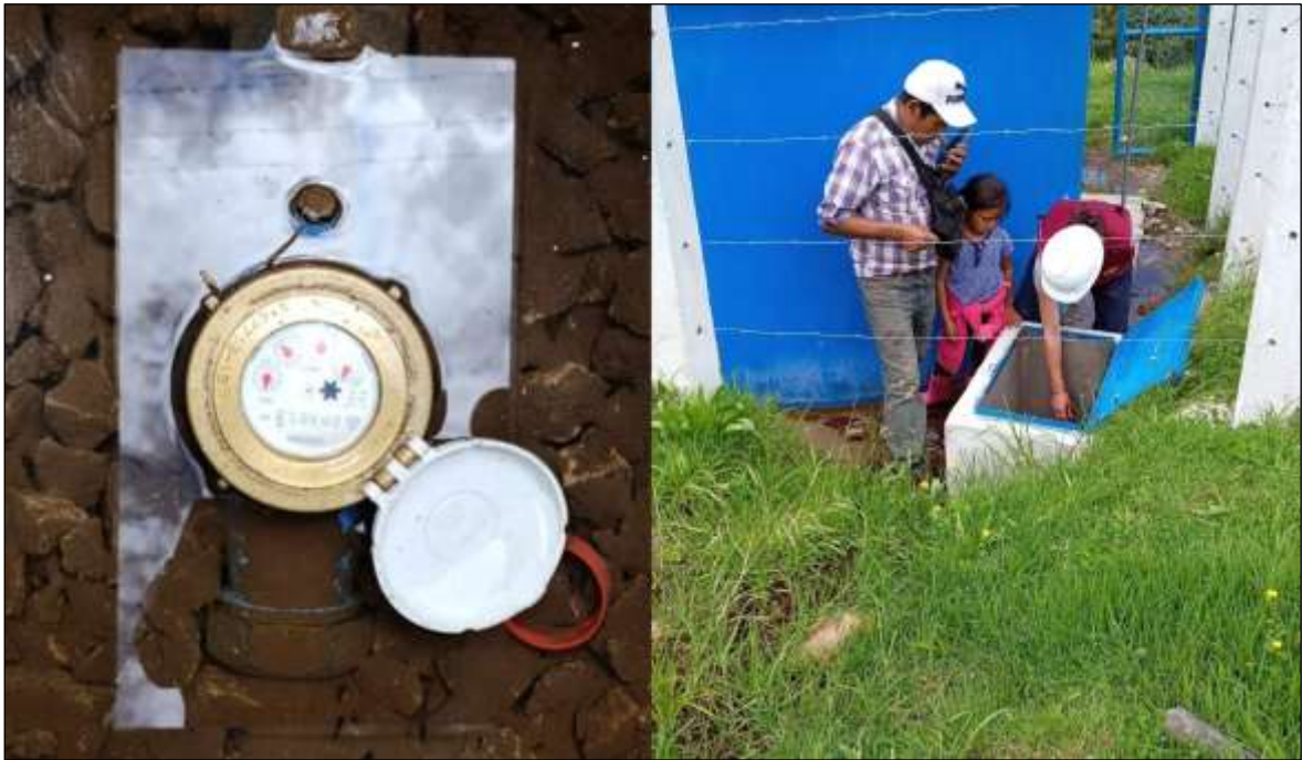
Figura 26 Medidor de caudal Alto Pingullo
