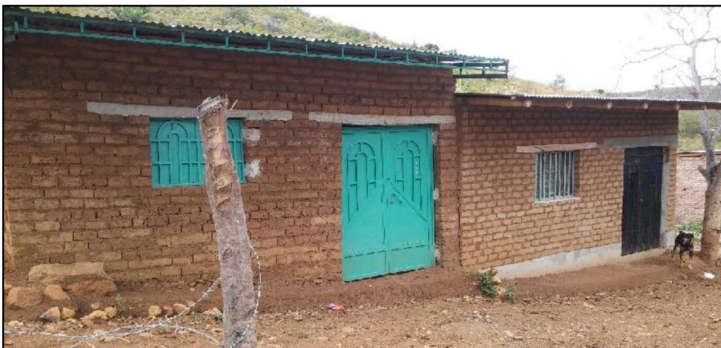
Figura 23. Vanos de puertas muy grandes y mal ubicados
