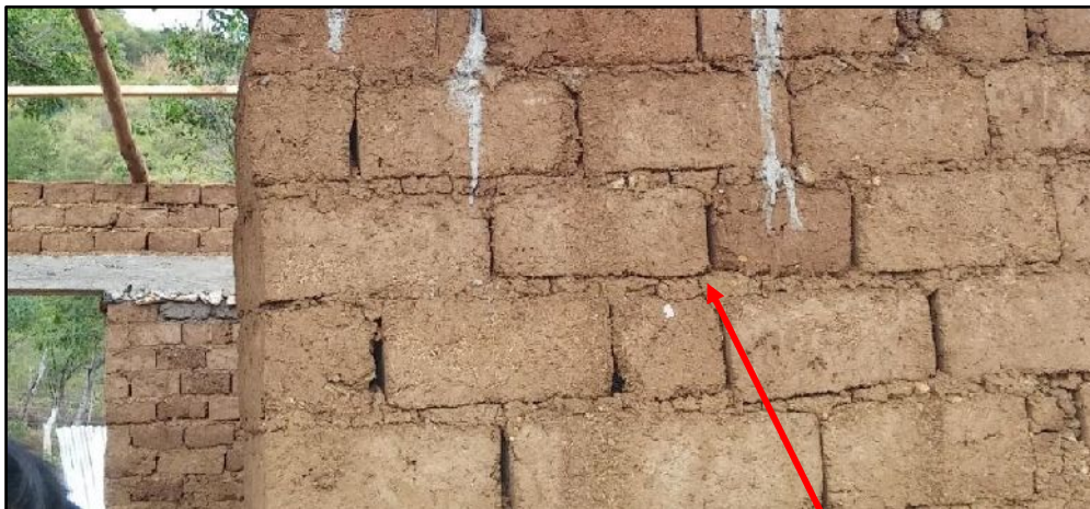
Figura 20. Mortero en juntas de adobes
