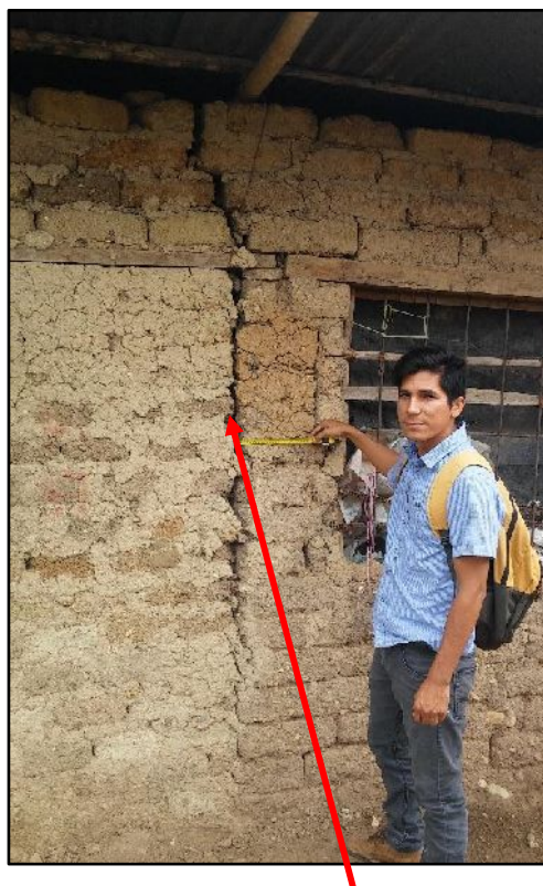
Figura 29. Grieta vertical en muro de adobe
