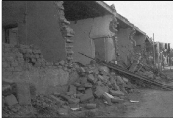
Figura 4. Colapso de fachada al quedar libre en voladizo (Kuroiwa, 2002).
