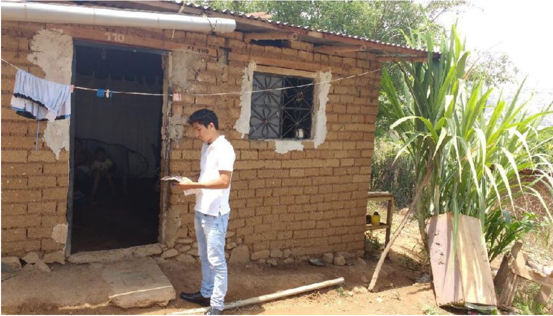
Fotografía 07: Se aprecia encuestando al propietario de la vivienda N°28, cuya cimentación está deteriorada.
