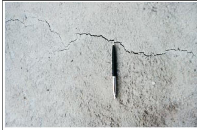
Figura N°13: Las fisuras por contracción plástica se aparecen con rasgaduras en el concreto fresco (Kosmatka, y otros, 2004)
