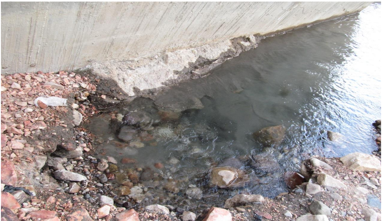
Figura 5: Socavación en la cimentación de la parte inicial del muro de encause
