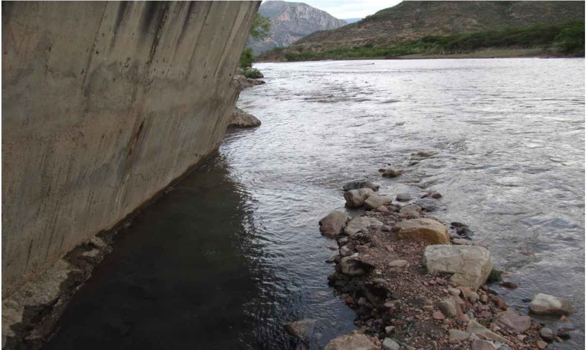
Figura 6: Socavación en la cimentación de la zona media del muro de encause
