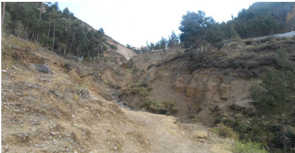
Figura D.26: Vista general de la zona del deslizamiento.
