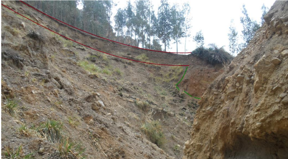
Figura D.22: Vista desde el pie del deslizamiento.
