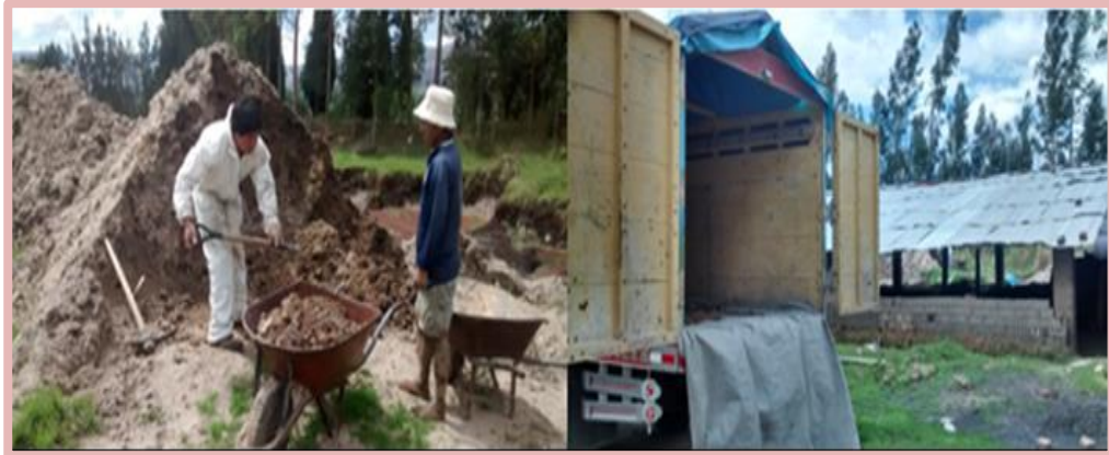
Figura 21. Transporte de suelo apto para construcción de ladrillo alternativo de suelo-cemento compactado.
