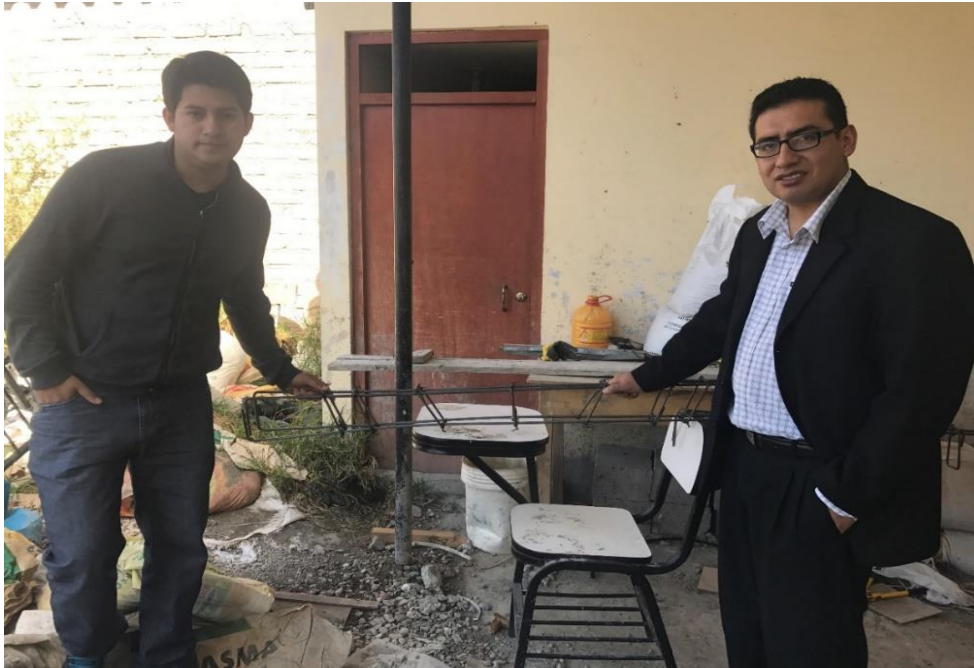
Fotografía 3. Supervisión del Dr. en I. Miguel Mosqueira Moreno, verificación del acero transversal inclinado para cada una de las vigas.
