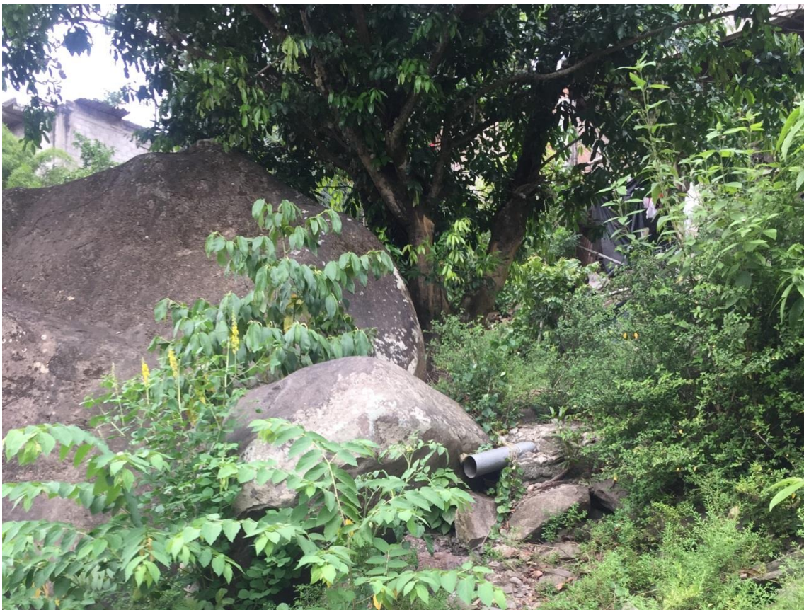
Figura 11: Descarga directa de desagüe al río
