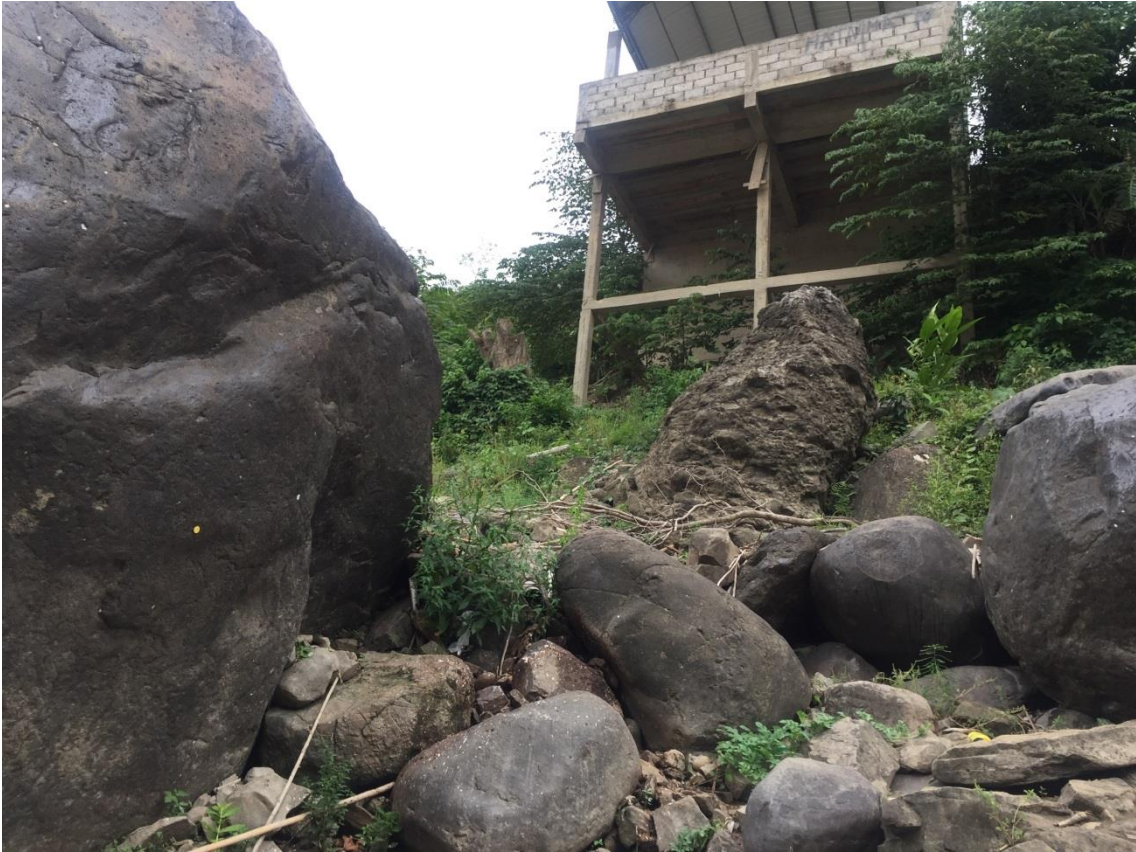
Figura 10: Descarga directa de desagüe al río
