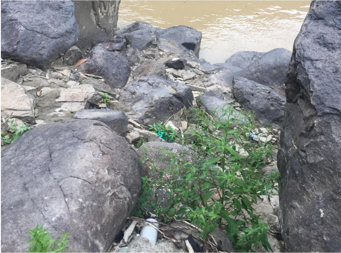
Figura 12: Descarga directa de desagüe al río
