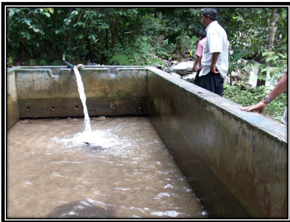
Figura 21. Estado actual del Sedimentador del Centro Poblado Churuyacu
