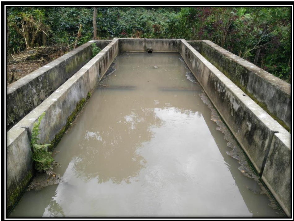
Figura 23. Estado actual del Tanque Imhoff del Centro Poblado Churuyacu
