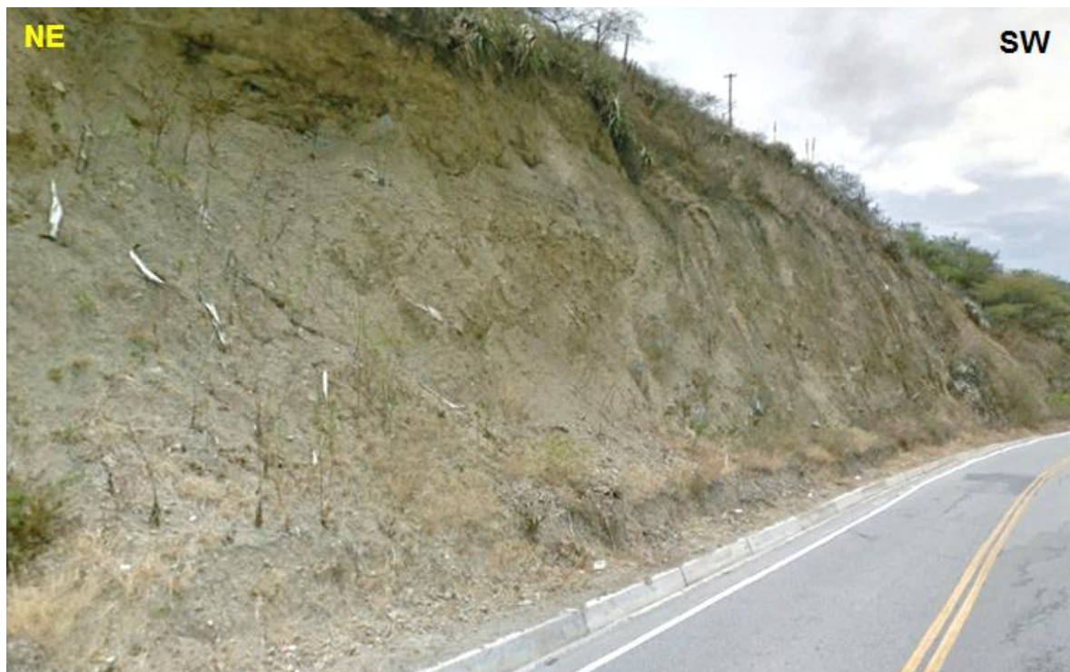
Figura 36: Talud 11, constituidos por depósitos coluvio-aluviales.
