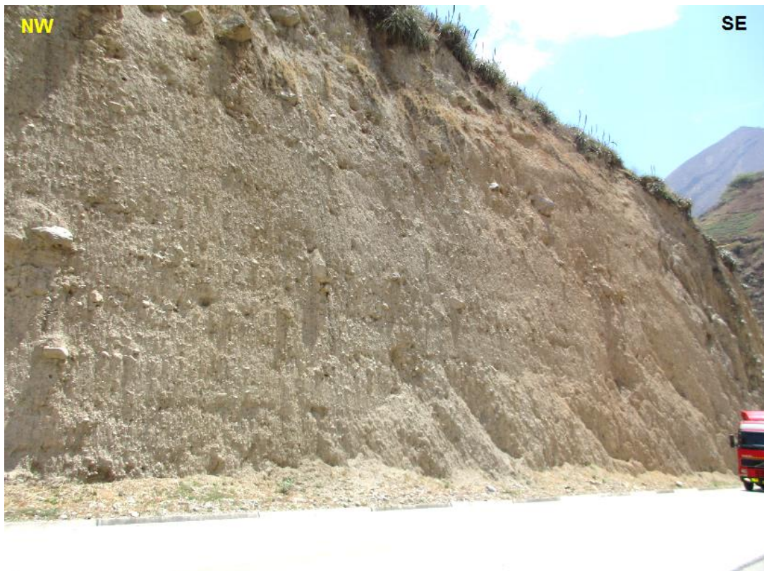
Figura 37: Talud 12, constituido por calizas de la Formación Pariatambo, altamente meteorizadas.
