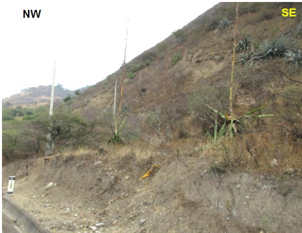
Figura 41: Talud 15, formado por depósitos aluviales inestables.
