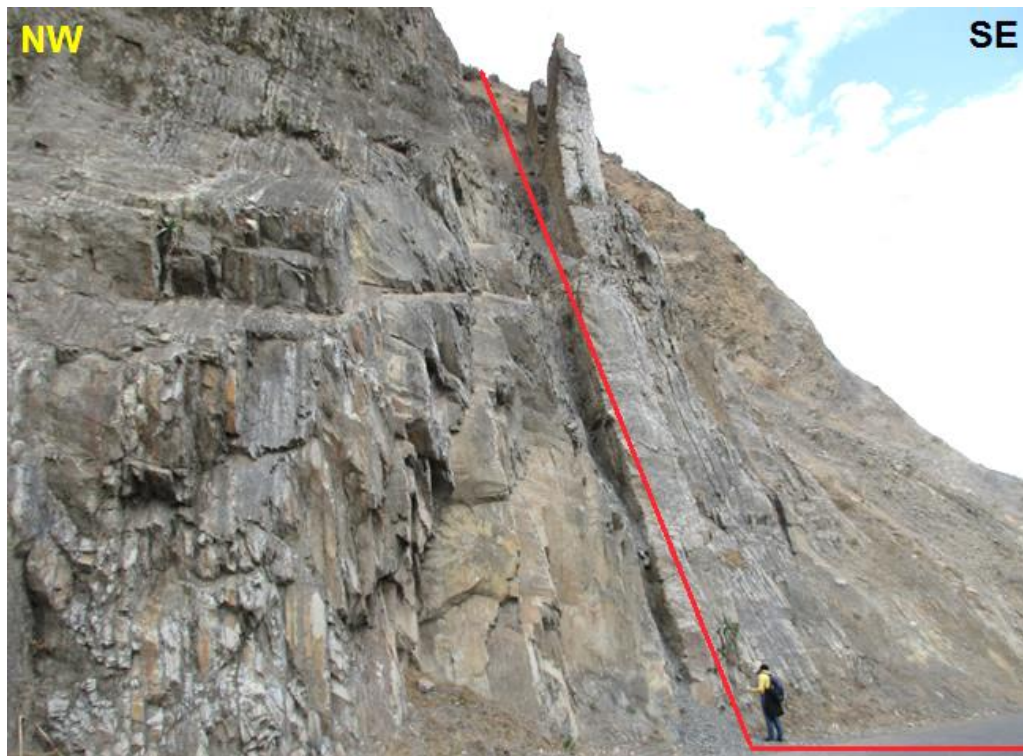
Figura 26: Talud 02, constituido por calizas de la Formación Paritambo, se observan bloques rocosos muy inestables.
