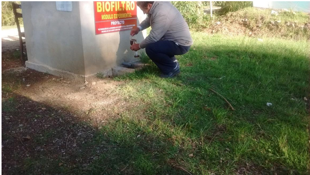
Foto 13: Toma de muestra del Biofiltro
