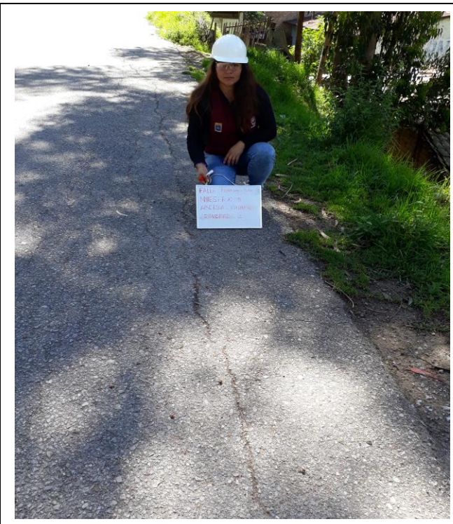
Foto N° 63: MUESTRA N°91 FISURA LONGITUDINAL POR FATIGA- GRAVEDAD: 2- ABCISA: 03+397.40
