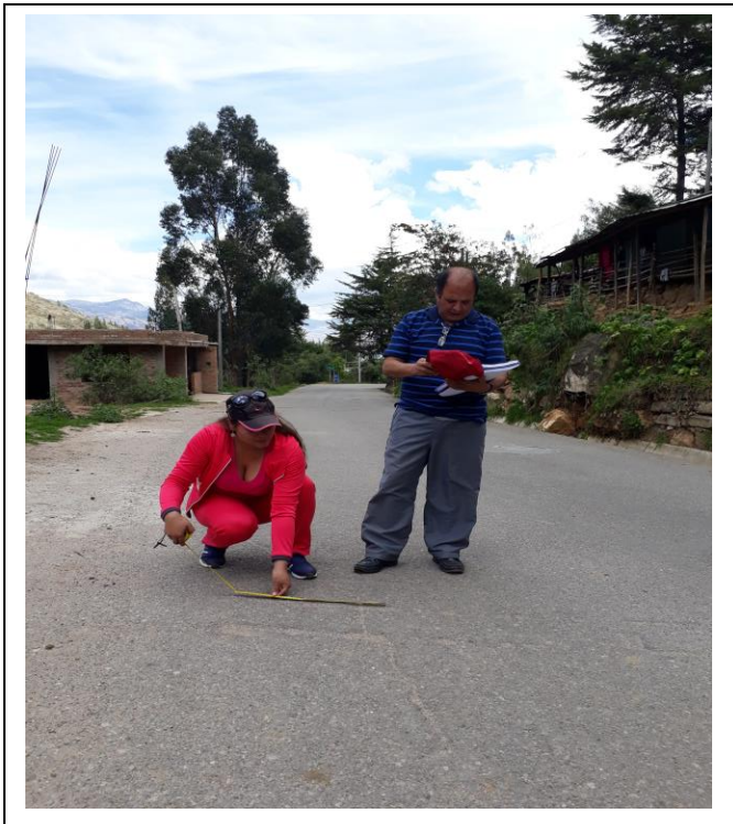
Foto N° 07: VERIFICACIÓN DE LAS FALLAS JUNTO CON EL ASESOR
