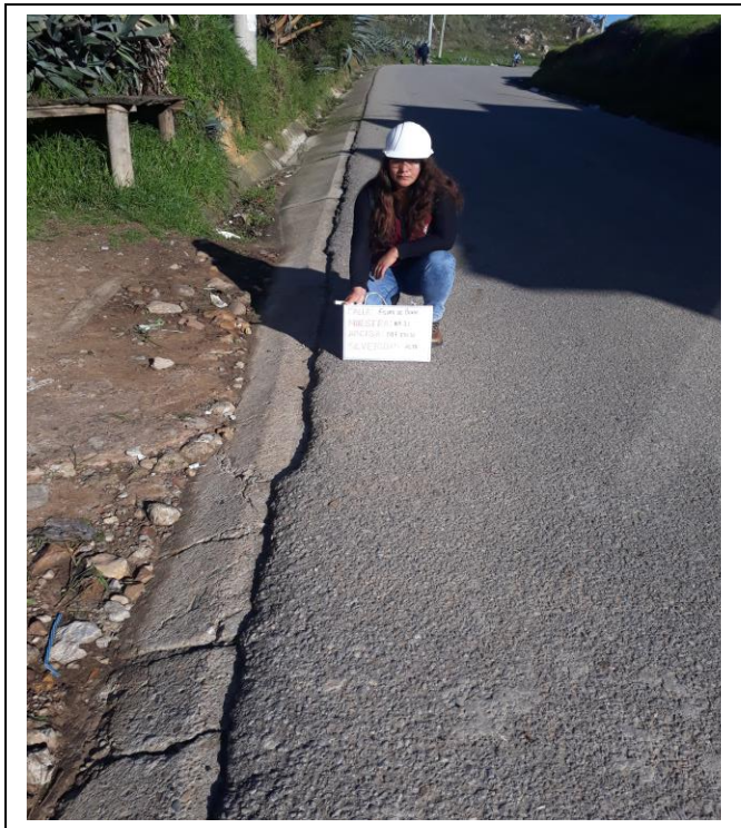
Foto N° 21: MUESTRA N°21 FISURA DE BORDE- SEVERIDAD: ALTA-ABCISA: 00+751.55
