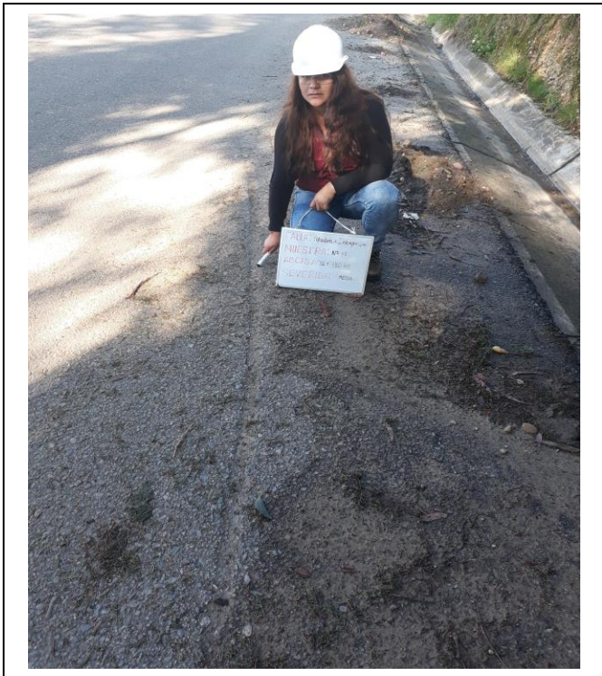
Foto N° 31: MUESTRA N°48 PELADURA POR INTEMPREISMO Y DESPRENDIMIENTO DE AGREGADOS-SEVERIDAD: MEDIA-ABCISA:
