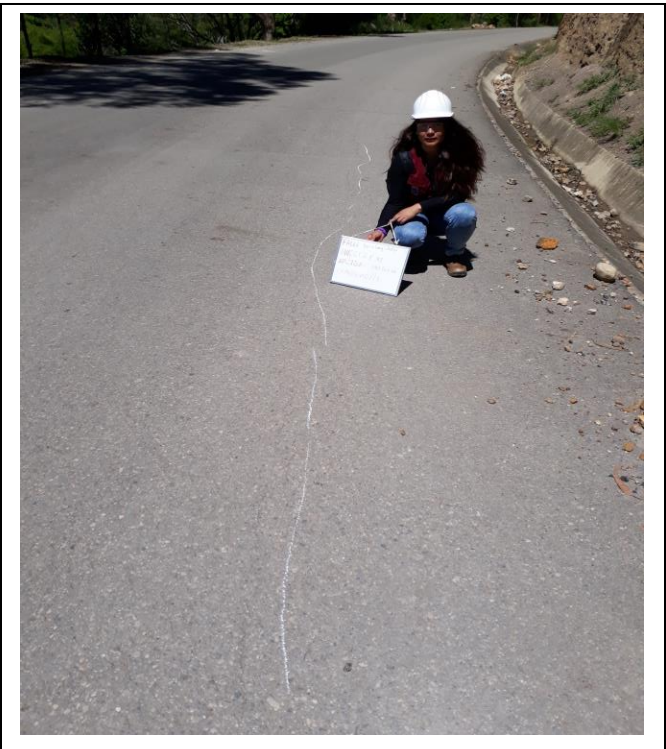
Foto N° 103: MUESTRA N°113 FISURA LONGITUDINAL POR FATIGA- GRAVEDAD: 1- ABCISA: 04+201.00
