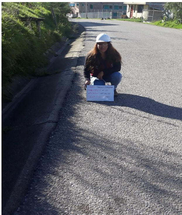
Foto N° 25: MUESTRA N°32 PELADURA POR INTEMPERISMO Y DESPRENDIMIENTO DE AGREGADOS- SEVERIDAD: BAJA-ABCISA: 01+162.50
