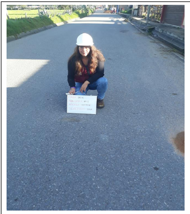
Foto N° 15: MUESTRA N°12 BACHE - SEVERIDAD: BAJA-ABCISA: 00+414.90
