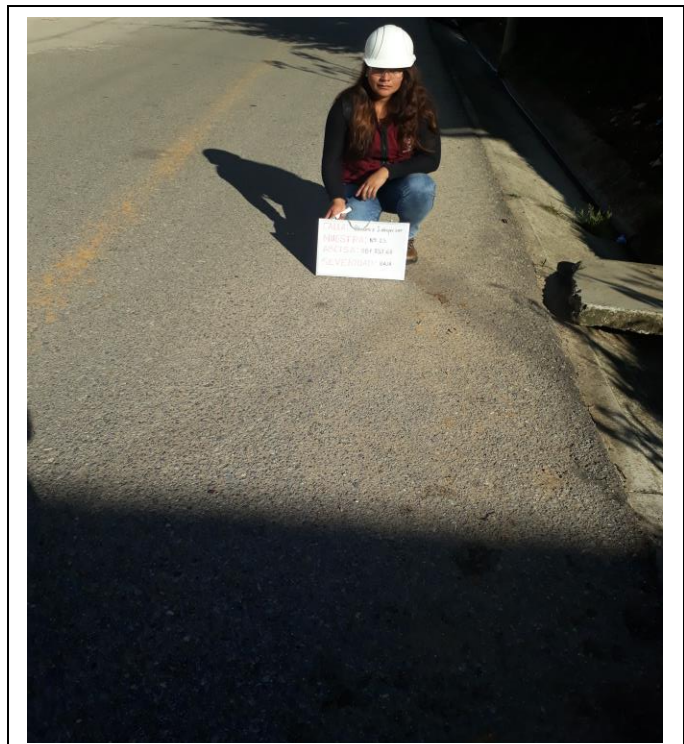
Foto N°22: MUESTRA N°23 PELADURA POR INTEMPERISMO Y DESPRENDIMIENTO DE AGREGADOS- SEVERIDAD: BAJA-ABCISA: 00+853.68
