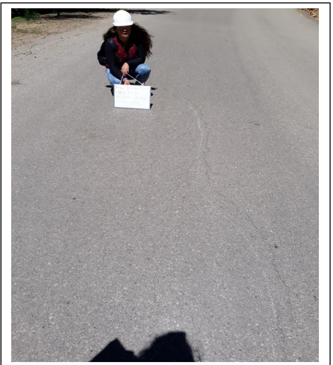
Foto N° 102: MUESTRA N°112 FISURA LONGITUDINAL POR FATIGA- GRAVEDAD: 1- ABCISA: 04+198.40
