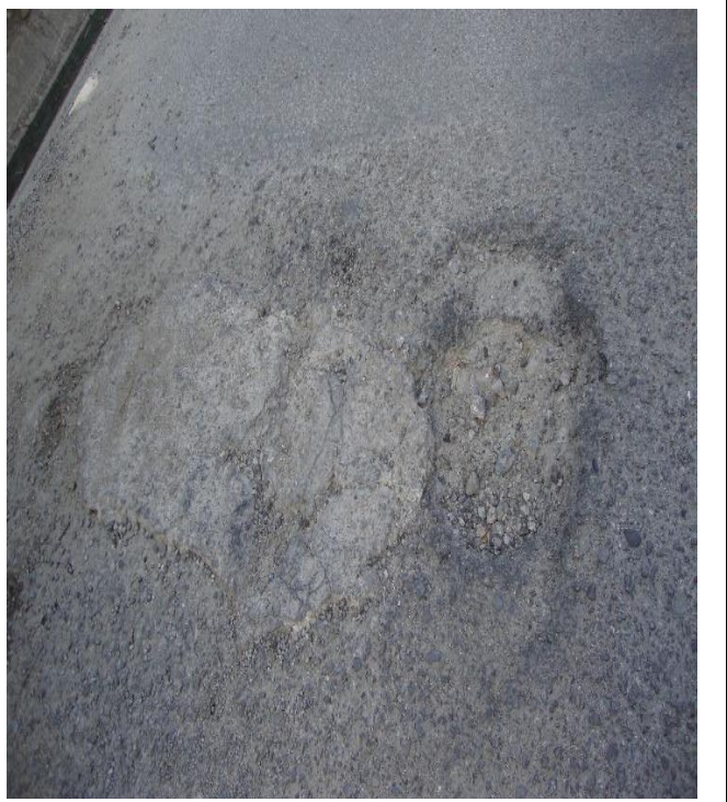
Foto N° 32: MUESTRA N°49 BACHE- SEVERIDAD: ALTA-ABCISA: 01+824.60
