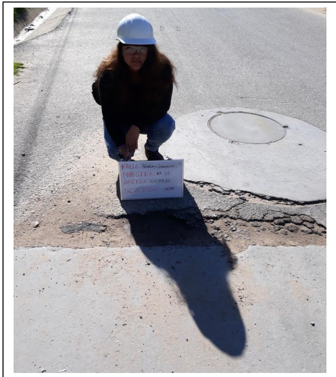
Foto N° 37: MUESTRA N°57 PELADURA POR INTEMPERISMO Y DESPRENDIMIENTO DE AGREGADOS- SEVERIDAD: ALTA-ABCISA: 02+109.35
