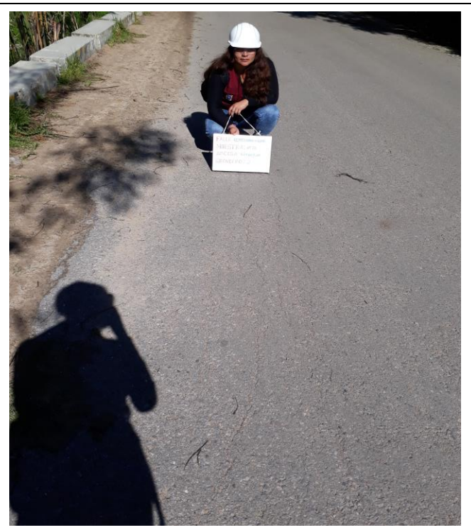
Foto N°44: MUESTRA N°70 DEPRESIONES O HUNDIMIENTOS GRAVEDAD: 2 -ABCISA: 02+607.00
