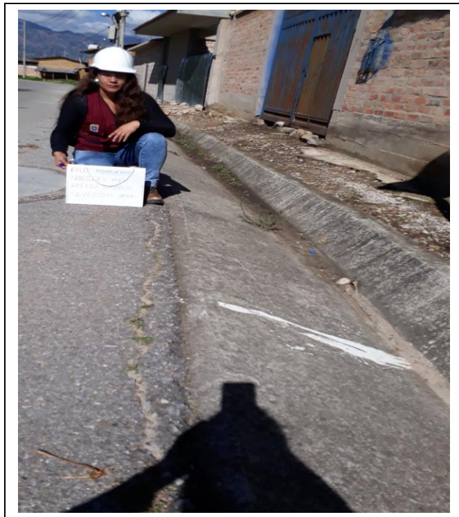
Foto N° 43: MUESTRA N°67 FISURA DE BORDE- SEVERIDAD: MEDIA-ABCISA: 02+487.40
