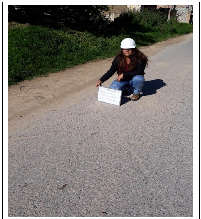
Foto N° 40: MUESTRA N°62 PELADURA POR INTEMPERISMO Y DESPRENDIMIENTO DE AGREGADOS- SEVERIDAD: BAJA-ABCISA: 02+279.35
