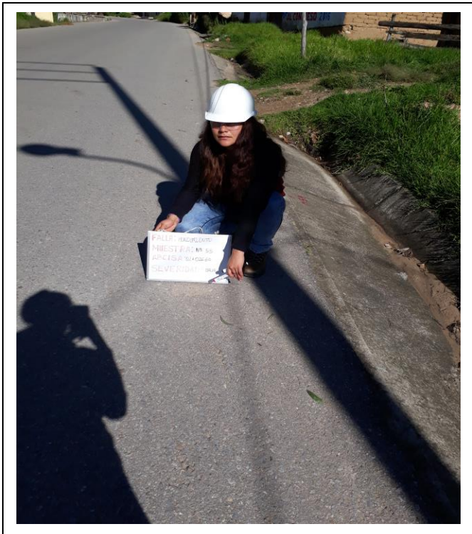
Foto N° 35: MUESTRA N°55 HUNDIMIENTO- SEVERIDAD: BAJA-ABCISA: 02+026.60
