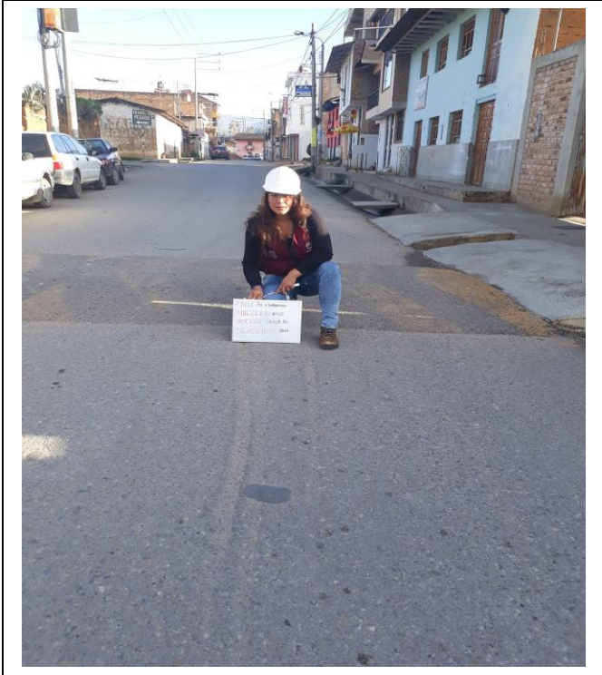
Foto N° 09: MUESTRA N°03 PELADURA POR INTEMPERISMO Y DESPRENDIMIENTO DE AGREGADOS- SEVERIDAD: BAJA-ABCISA: 00+112.50
