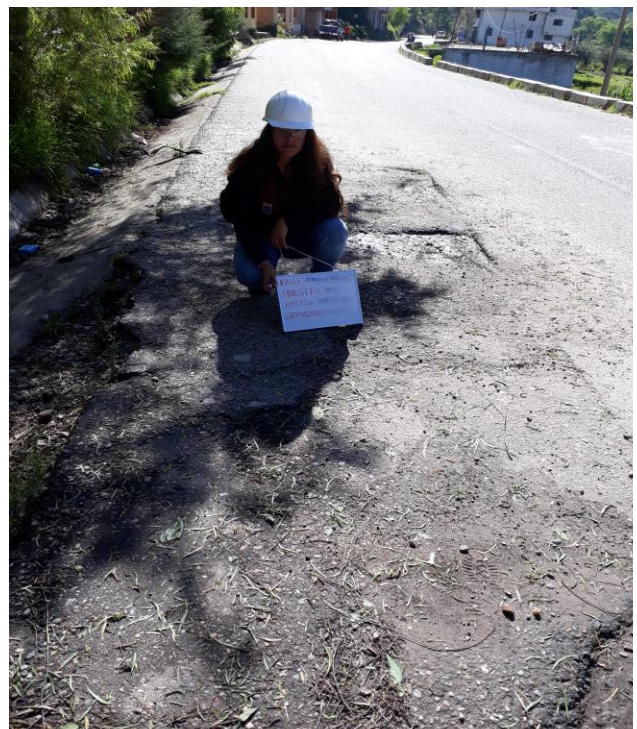
Foto N°46: MUESTRA N°72 PÉRDIDA DE AGREGADOS DE AGREGADOS- GRAVEDAD: 3- ABCISA: 02+675.30
