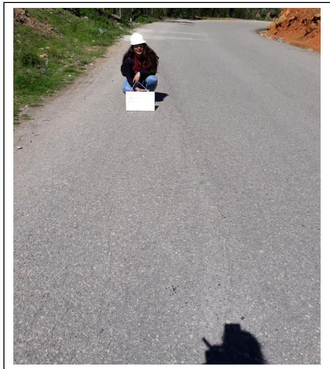
Foto N° 71: MUESTRA N°100 FISURA LONGITUDINAL POR FATIGA- GRAVEDAD: 1 - ABCISA: 03+712.50
