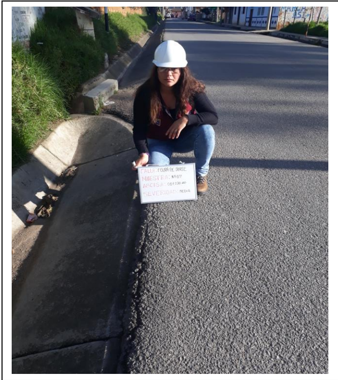
Foto N° 13: MUESTRA N°07 FISURA DE BORDE- SEVERIDAD: MEDIA-ABCISA: 00+230.00
