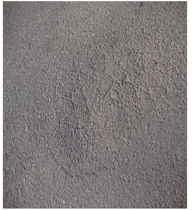
Foto N°30: MUESTRA N°47 DEPRESIÓN- SEVERIDAD: MEDIA-ABCISA: 01+725.00
