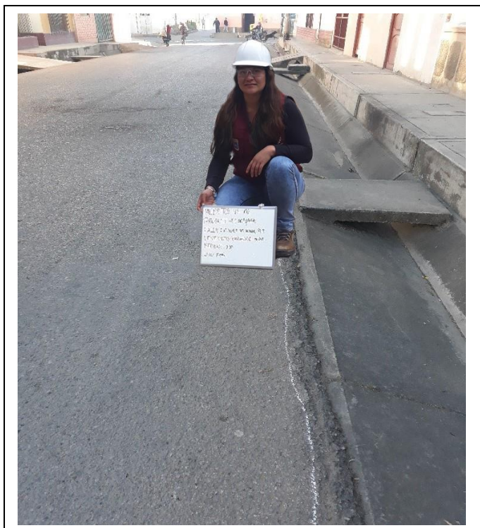
Foto N°08: MUESTRA N°02 FISURA DE BORDE-SEVERIDAD: MEDIA-ABCISA: 00+044.40
