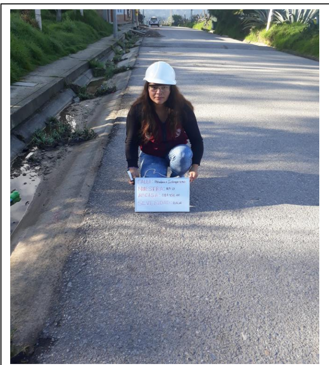
Foto N° 16: MUESTRA N°13 PELADURA POR INTEMPERISMO Y DESPRENDIMIENTO DE AGREGADOS- SEVERIDAD: BAJA-ABCISA: 00+450.00
