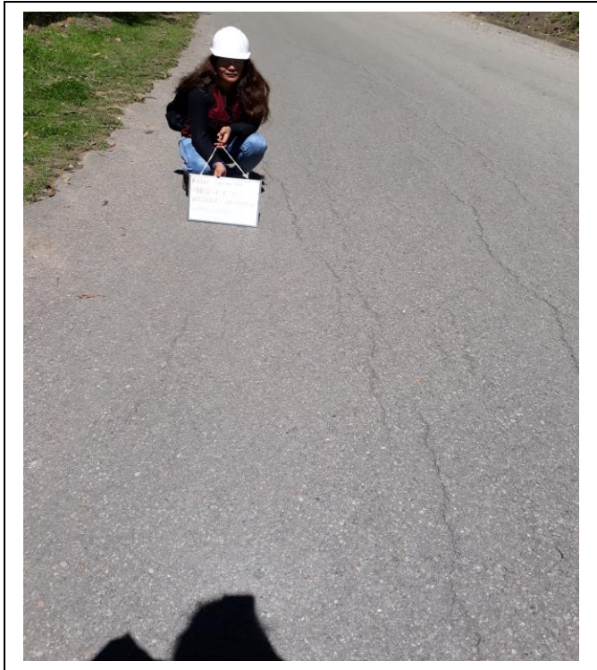
Foto N° 97: MUESTRA N°107 FISURA LONGITUDINAL POR FATIGA- GRAVEDAD:2 MEDIA-ABCISA: 03+975.40
