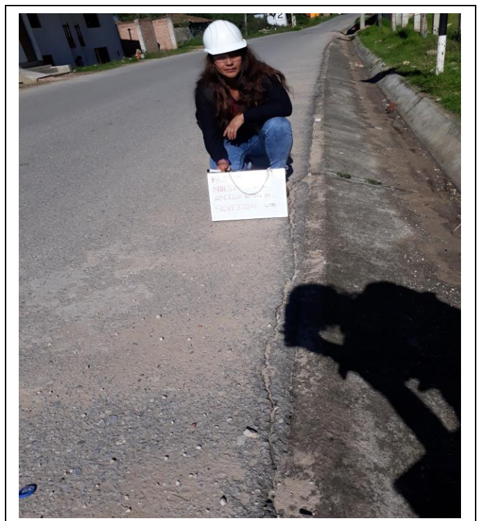
Foto N°38: MUESTRA N°58 FISURA DE BORDE- SEVERIDAD: ALTA-ABCISA: 02+148.50
