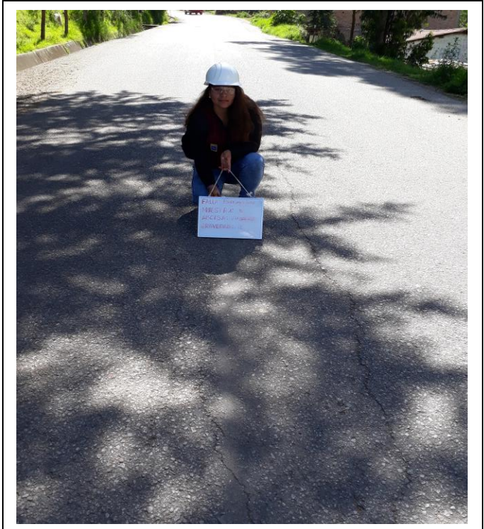
Foto N° 62- MUESTRA N°90 FISURA LONGITUDINAL POR FATIGA- GRAVEDAD: 2-- ABCISA: 03+366.00
