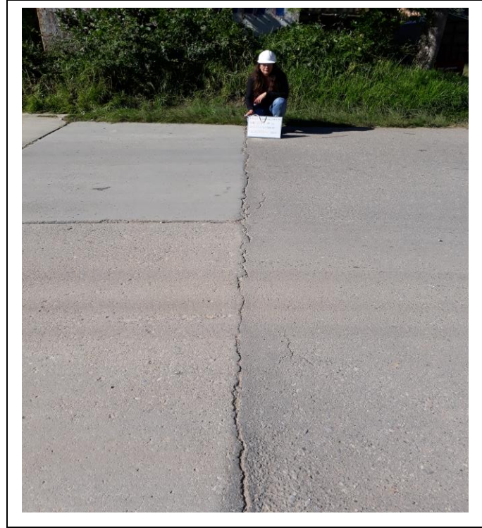
Foto N° 36: MUESTRA N°56 FISURA DE REFLEXIÓN DE JUNTA- SEVERIDAD: MEDIA- ABCISA: 02+089.45
