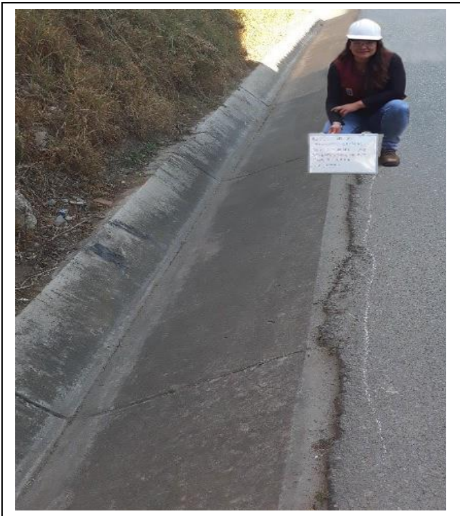
Foto N° 11: MUESTRA N°04 FISURA DE BORDE- SEVERIDAD: ALTA-ABCISA: 00+136.60
