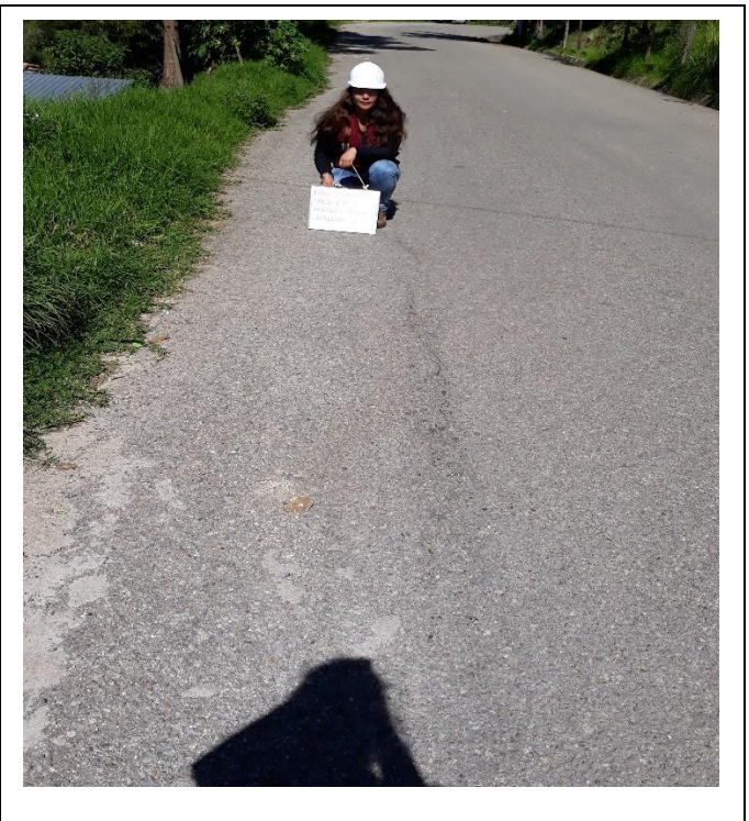
Foto N°64: MUESTRA N°92 FISURA LONGITUDINAL POR FATIGA- GRAVEDAD: 2- ABCISA: 03+441.90
