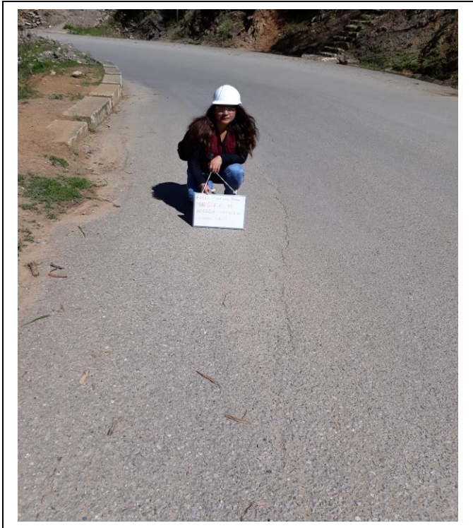
Foto N° 69: MUESTRA N°97 FISURA LONGITUDINAL POR FATIGA- GRAVEDAD: 1 - ABCISA: 03+623.10
