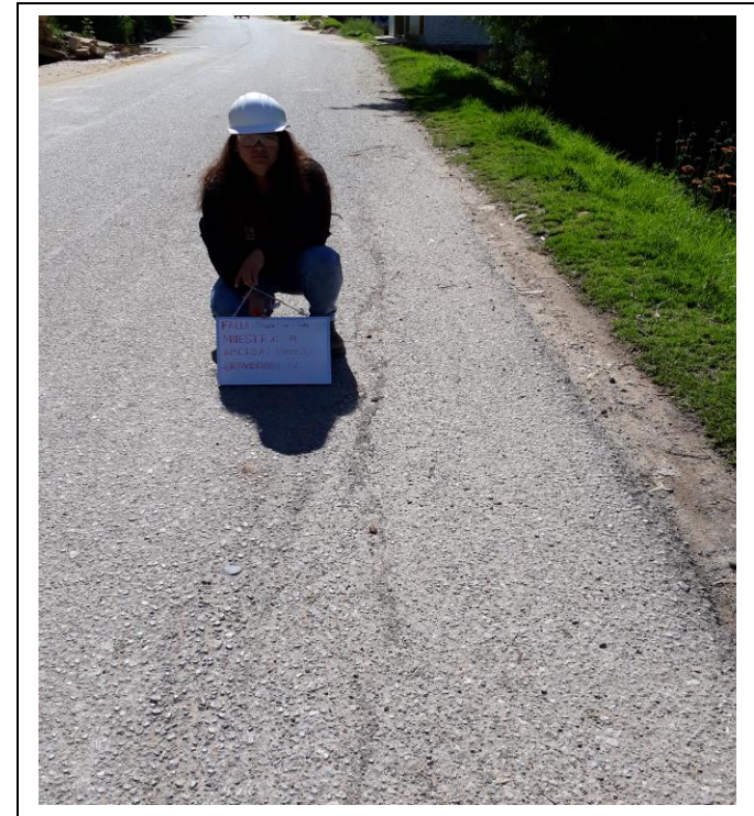
Foto N° 56: MUESTRA N°84 FISURA LONGITUDINAL POR FATIGA- GRAVEDAD: 2- ABCISA: 03+112.50
