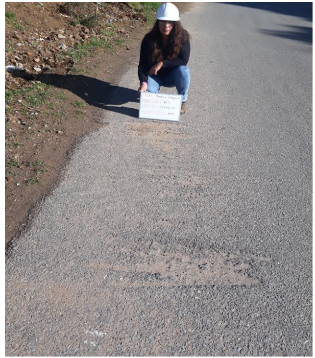
Foto N° 18: MUESTRA N°17 PELADURA POR INTEMPERISMO Y DESPRENDIMIENTO DE AGREGADOS- SEVERIDAD: MEDIA-ABCISA: 00+606
