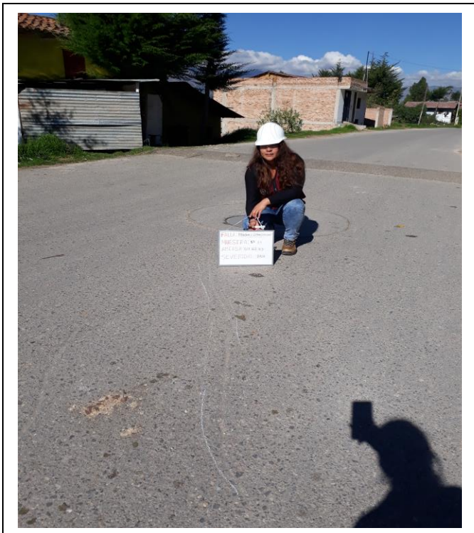
Foto N° 39: MUESTRA N°59 PELADURA POR INTEMPERISMO Y DESPRENDIMIENTO DE AGREGADOS- SEVERIDAD: BAJA-ABCISA: 02+162.53
