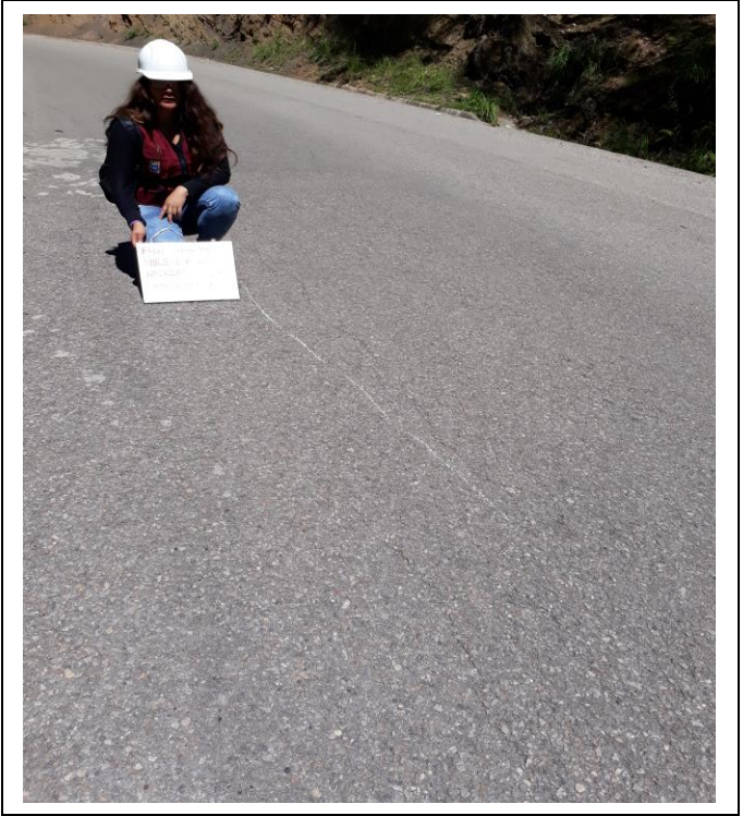
Foto N° 98: MUESTRA N°108 FISURA LONGITUDINAL POR FATIGA- GRAVEDAD:1 - ABCISA: 04+112.50
