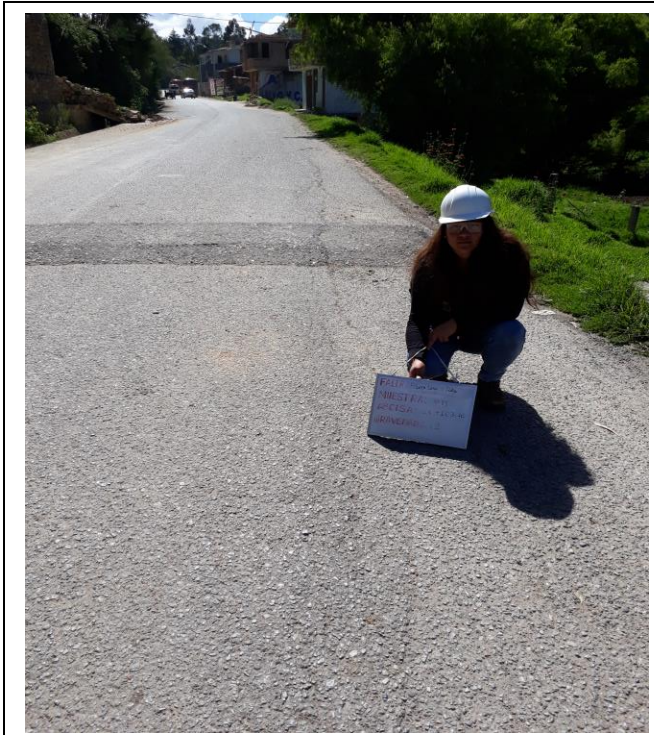
Foto N° 55: MUESTRA N°83 FISURA LONGITUDINAL POR FATIGA- GRAVEDAD: 2- ABCISA: 03+103.10
