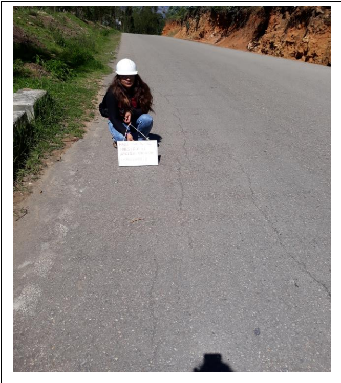
Foto N° 93: MUESTRA N°102 FISURA LONGITUDINAL POR FATIGA- GRAVEDAD: 2 - ABCISA: 03+787.50
