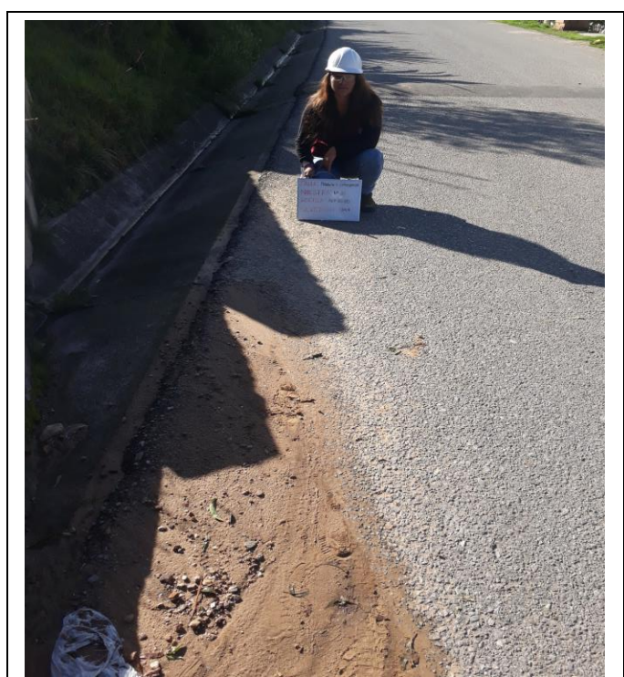
Foto N°24: MUESTRA N°31 PELADURA POR INTEMPERISMO Y DESPRENDIMIENTO DE AGREGADOS- SEVERIDAD: BAJA-ABCISA: 01+125.00
