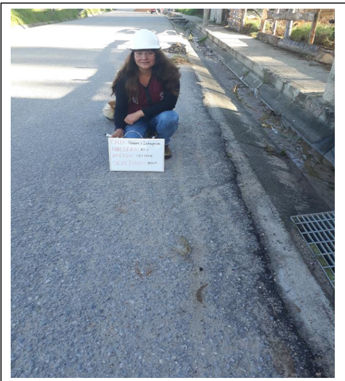
Foto N°14: MUESTRA N°11 PELEDURA POR INTEMPERISMO Y DESPRENDIMIENTO DE AGREGADOS- SEVERIDAD: MEDIA-ABCISA: 00+044.40
