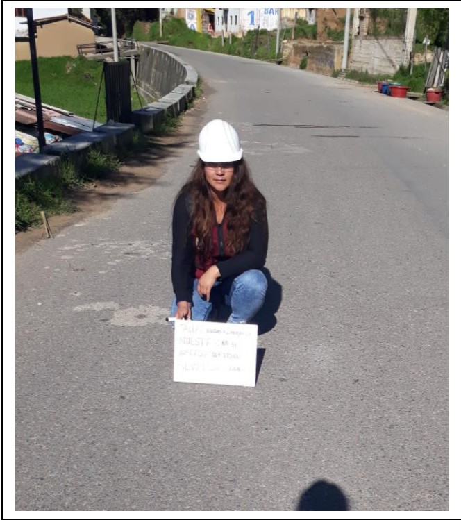
Foto N° 33: MUESTRA N°51 PELADURA POR INTEMPERISMO Y DESPRENDIMIENTO DE AGREGADOS- SEVERIDAD: BAJA-ABCISA: 01+875.00
