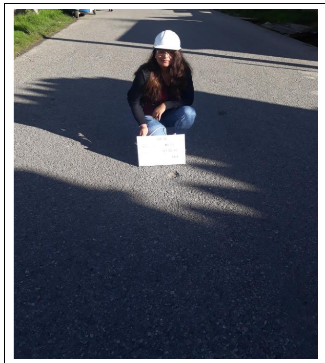
Foto N° 23: MUESTRA N°25 BACHE-SEVERIDAD: BAJA-ABCISA: 00+912.80
