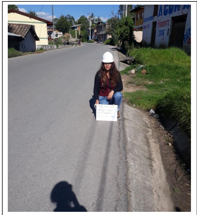
Foto N°34: MUESTRA N°54 FISURA DE BORDE- SEVERIDAD: MEDIA-ABCISA: 02+021.70
