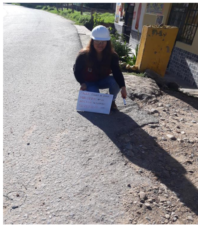
Foto N° 28: MUESTRA N°43 FISURA DE BORDE- SEVERIDAD: ALTA-ABCISA: 01+609.60
