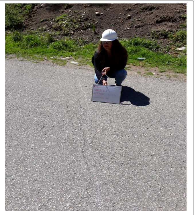
Foto N°72- MUESTRA N°101 FISURA TRANSVERSAL- SEVERIDAD: BAJA-ABCISA: 03+765.20
