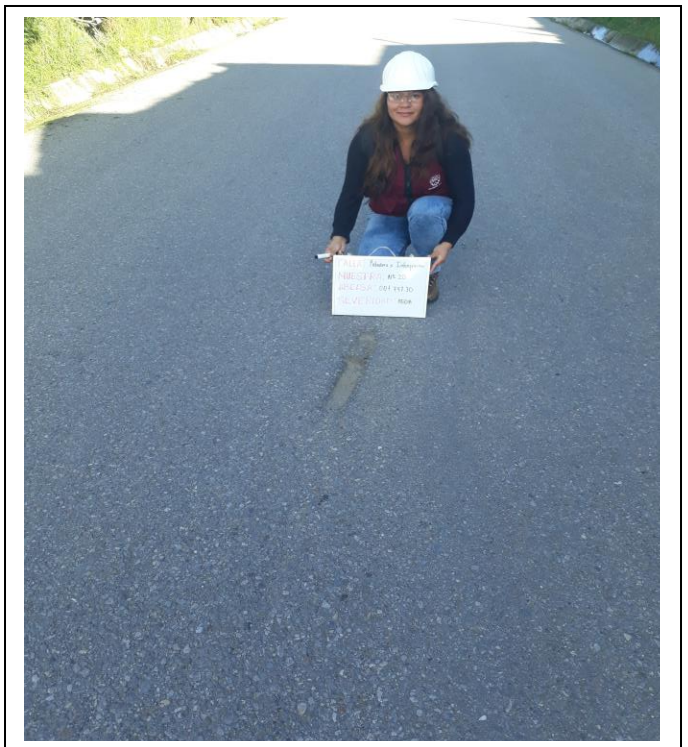
Foto N°20: MUESTRA N°20 PELADURA POR INTEMPERISMO Y DESPRENDIMIENTO DE AGREGADOS-SEVERIDAD: MEDIA-ABCISA: 00+747.30
