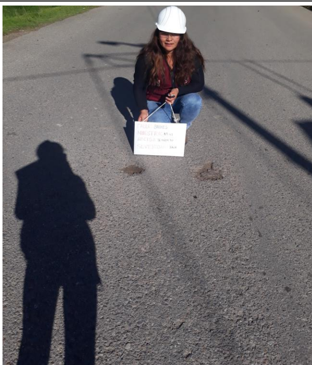
Foto N° 27: MUESTRA N°43 BACHE- SEVERIDAD: BAJA-ABCISA: 01+604.70
