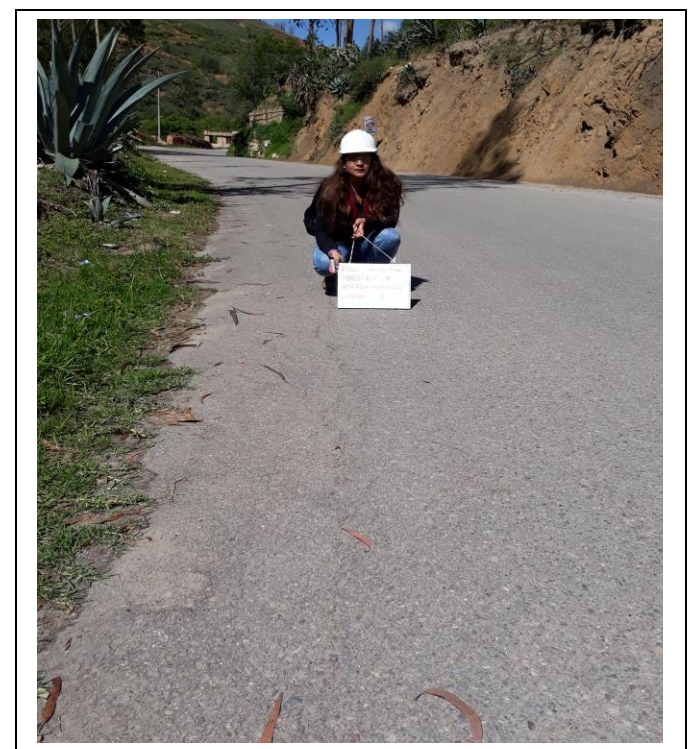
Foto N°68- MUESTRA N°96 FISURA LONGITUDINAL POR FATIGA- GRAVEDAD: 1 - ABCISA: 03+566.53
