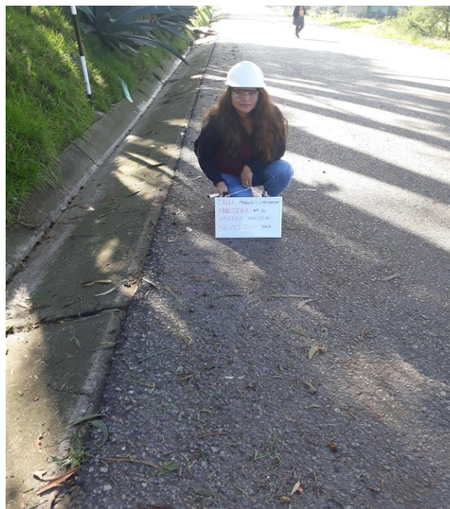
Foto N°26: MUESTRA N°36 PELADURA POR INTEMPERISMO Y DESPRENDIMIENTO DE AGREGADOS- SEVERIDAD: BAJA-ABCISA: 01+312.50
