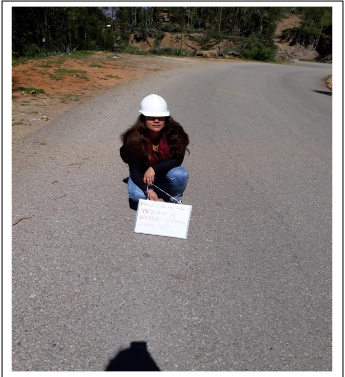
Foto N° 70: MUESTRA N°98 FISURA LONGITUDINAL POR FATIGA- GRAVEDAD: 1 - ABCISA 03+649.40
