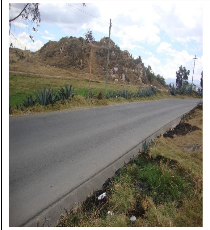
Foto N°17: MUESTRA N°16 EXUDACIÓN- SEVERIDAD: MEDIA-ABCISA: 00+044.40
