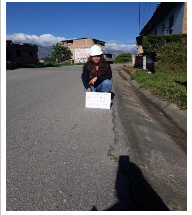
Foto N° 29: MUESTRA N°45 FISURA DE BORDE- SEVERIDAD: MEDIA-ABCISA: 01+665.95
