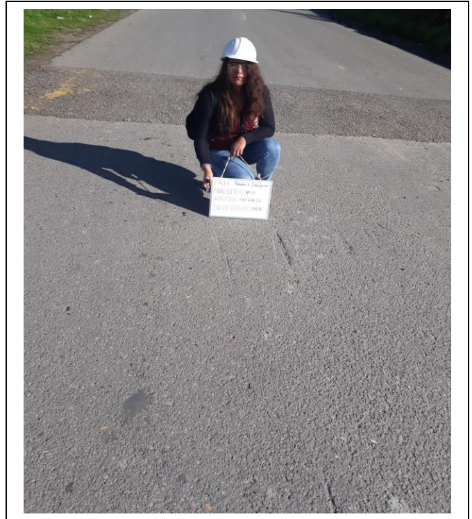
Foto N° 19: MUESTRA N°18 PELADURA POR INTEMPERISMO Y DESPRENDIMIENTO DE AGREGADOS- SEVERIDAD: BAJA-ABCISA: 00+670.20
