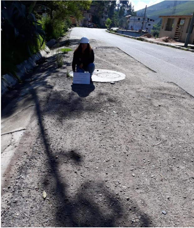
Foto N° 45: MUESTRA N°72 PÉRDIDA DE AGREGADOS DE AGREGADOS- GRAVEDAD: 3- ABCISA: 02+662.50
