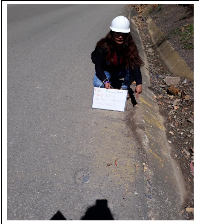
Foto N° 101: MUESTRA N°112 DESINTEGRACIÓN DE BORDES DEL PAVIMENTO- GRAVEDAD: 2 - ABCISA: 04+179.15
