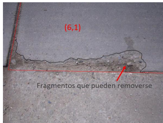
Fotografía 56: Descascaramiento de junta de severidad media en losa (6,1) de la unidad de muestra T1 – U11. Fecha: 11/05/2017.
