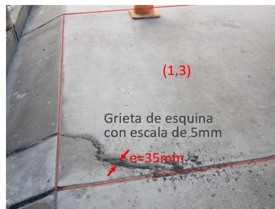
Fotografía 34: Grieta de esquina de severidad media en Losa (1,3) de la unidad de muestra T2 – U24. Fecha: 10/03/2017.
