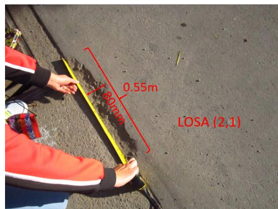
Fotografía 58: Descascaramiento de junta de severidad baja en losa (2,1) de la unidad de muestra T1 – U12. Fecha: 11/05/2017.
