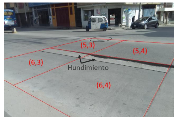
Fotografía 82: Losas (5,3)(6,3)(5,4)(6,4) de la unidad de muestra T1 – U27, observándose hundimiento y agrietamiento en las losas que fueron removidas para permitir la instalación de la línea de desagüe. Fecha: 22/09/2017.
