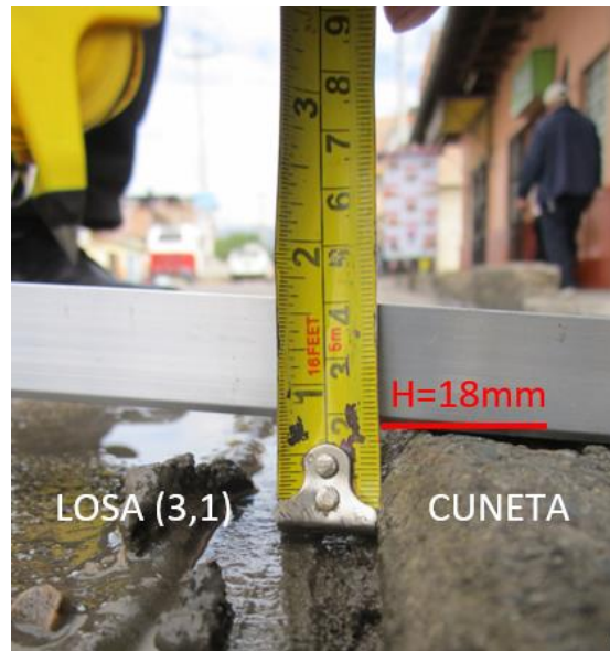
Fotografía 30: Diferencia de nivel o escala entre Losa (3,1) y cuneta de la unidad de muestra T2 – U20. Fecha: 10/03/2017.
