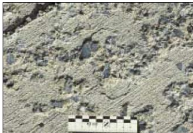
Figura 19: Descamación / Craquelado de severidad media.
