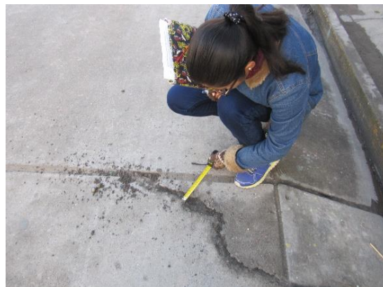
Fotografía 02: Inspección y registro del tipo de falla presente en una losa, tratándose de una grieta de esquina de severidad media. Fecha: 10/03/2017.
