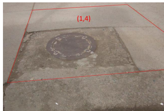
Fotografía 24: Parche grande deteriorado (tapa buzón) en Losa (1,4) de la unidad de muestra T2 – U16. Fecha: 10/03/2017.
