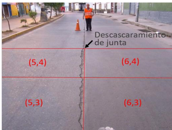
Fotografía 61: Descascaramiento de juntas de severidad media entre losas (5,3)(6,3) y (5,4)(6,4) de la unidad de muestra T1 – U12. Fecha: 11/05/2017.
