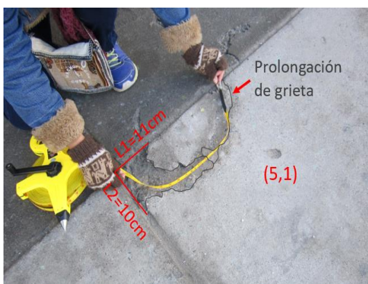
Fotografía 35: Descascaramiento de esquina de severidad baja en Losa (5,1) de la unidad de muestra T2 – U24. Fecha: 10/03/2017.
