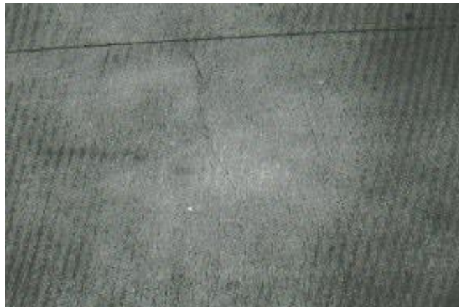
Figura 18: Fisuración por Retracción típica.
