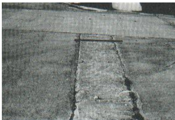
Figura 31: Parche grande de una acometida de servicios públicos de severidad media.
