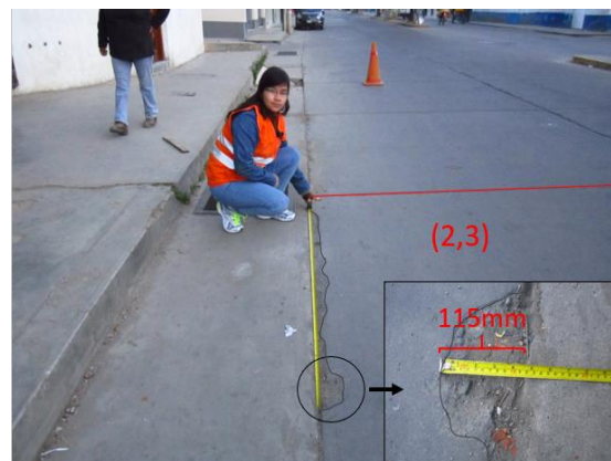
Fotografía 62: Descascaramiento de junta de severidad media en losa (2,3) de la unidad de muestra T1 – U13. Fecha: 11/05/2017.
