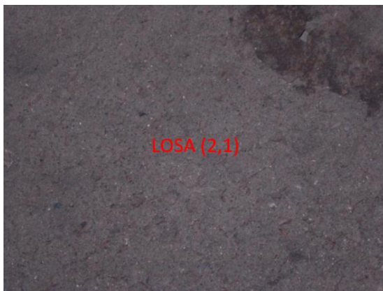
Fotografía 55: Falla por descamación con severidad baja de la losa (2,1) de la unidad de muestra T1 – U11. Fecha: 11/05/2017.
