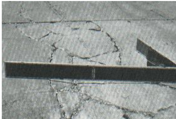
Figura 29: Punzonamiento de alta severidad.
