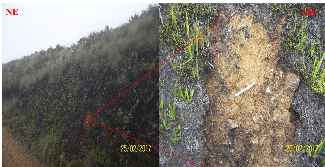
Foto 3.7: Depósitos coluviales asociados a masas inestables y están compuestos por fragmentos gruesos y angulares.
