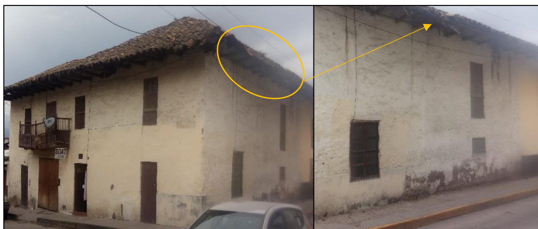
Figura 22: Cobertura de teja en malas condiciones.
