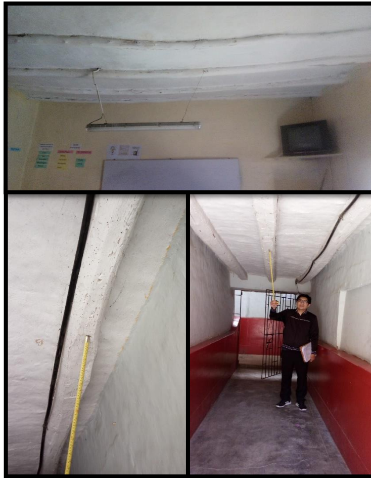
Vigas apolilladas y pandeadas
