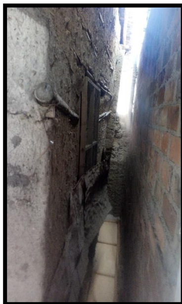
Muro posterior de la edificación en mal estado
