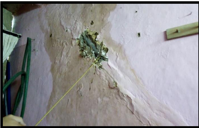
Filtración de agua en muros
