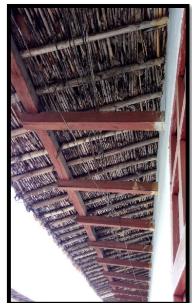
Parte inferior de la cobertura deteriorada
