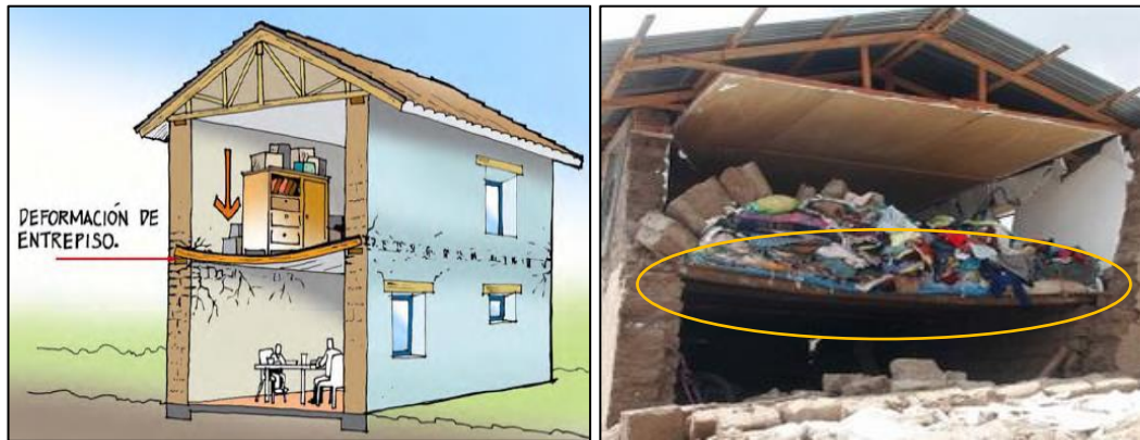
Figura 20: Deformación de entrepiso en viviendas de adobe
