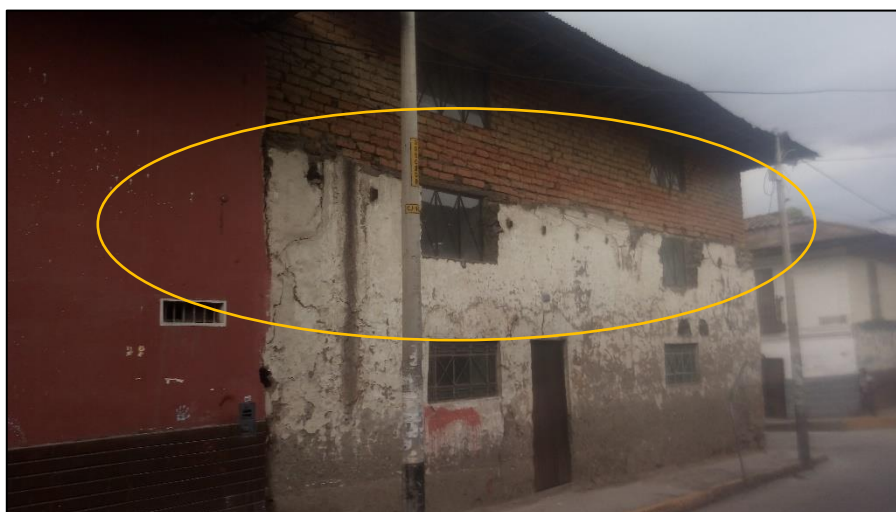
Figura 17: Fallas en entrepiso en las edificaciones de adobe.
