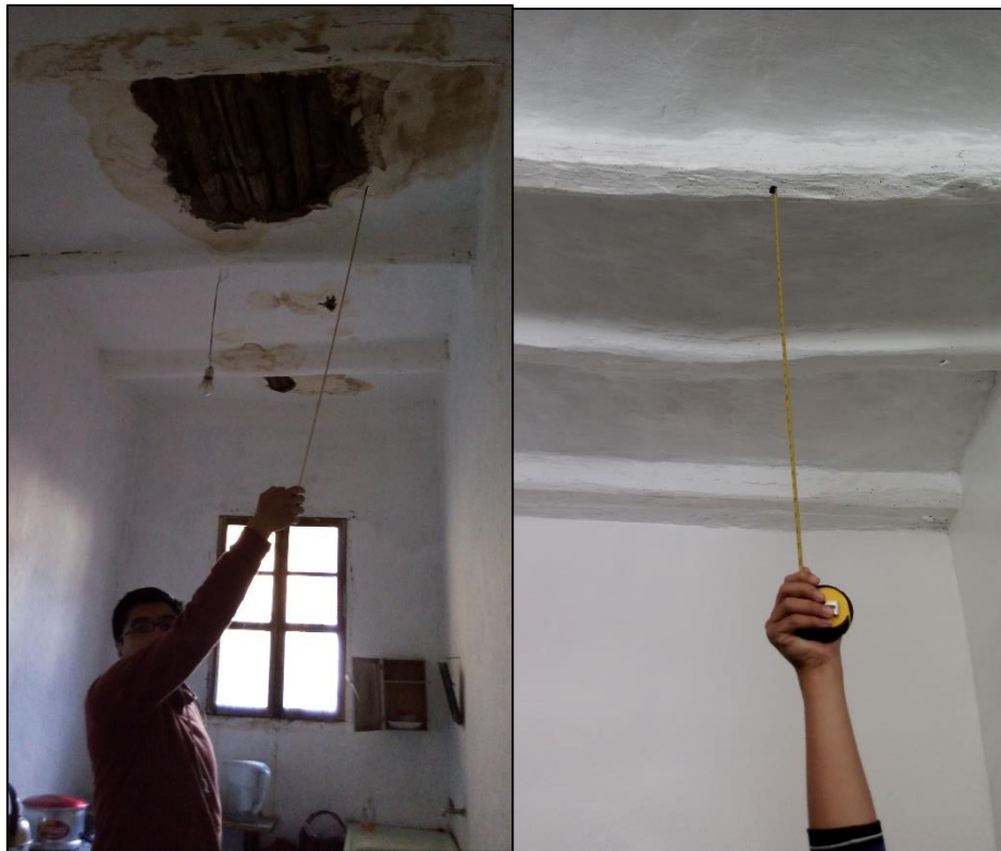
Figura 30: (a) Humedad y desprendimiento en techo de la edificación, (b) Vigas apolilladas e gran parte del colegio La merced.
