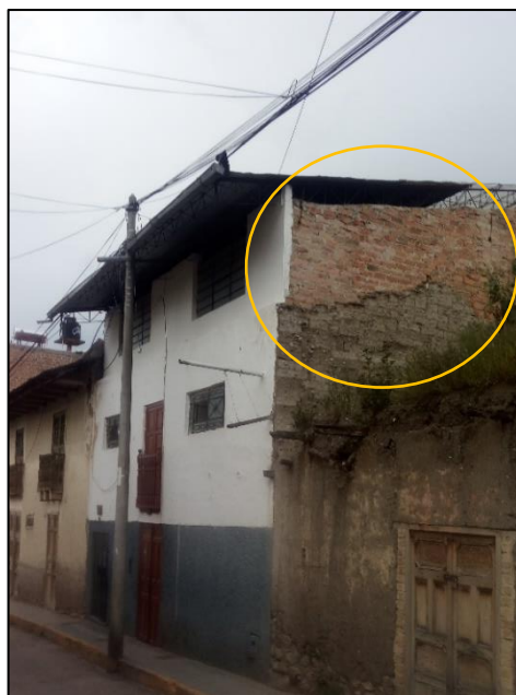
Figura 19: Falta de criterio técnico en la combinación de materiales de construcción.
