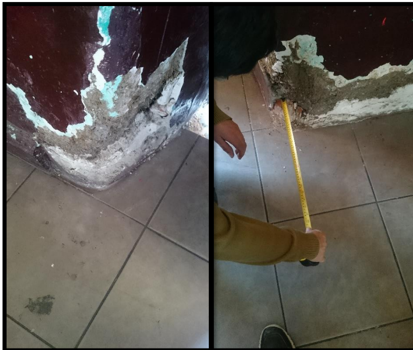
Desprendimiento en base de muros
