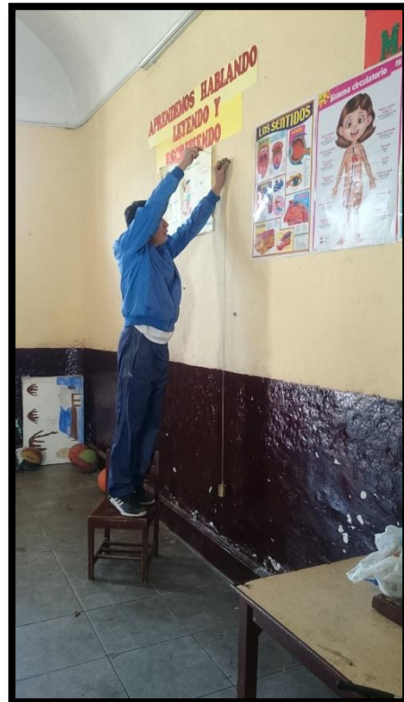
Ligera falta de verticalidad en algunos muros
