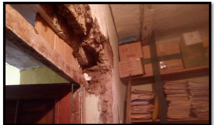
Desprendimiento sobre dinteles
