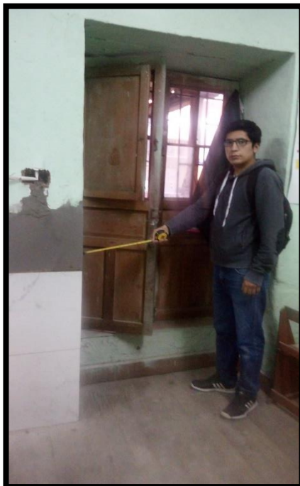
Material no compatible con muros de adobe
