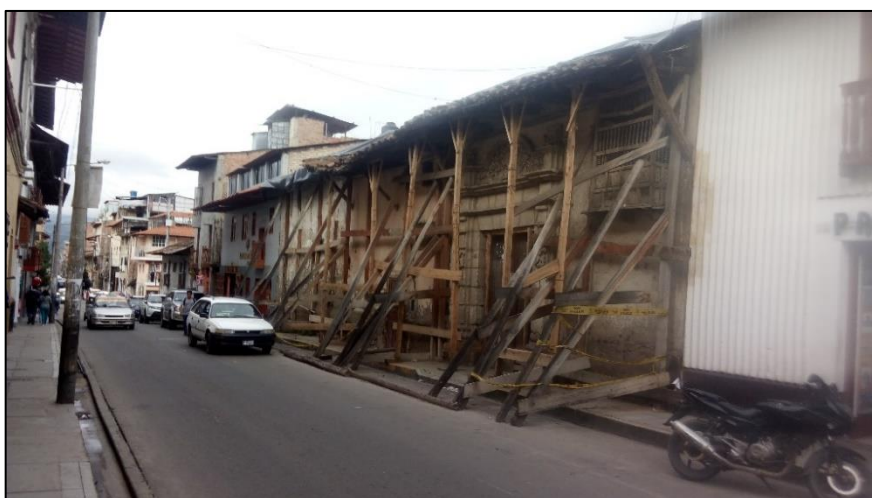
Figura 24: Inminente colapso de una edificación de adobe en el centro Histórico de Cajamarca.
