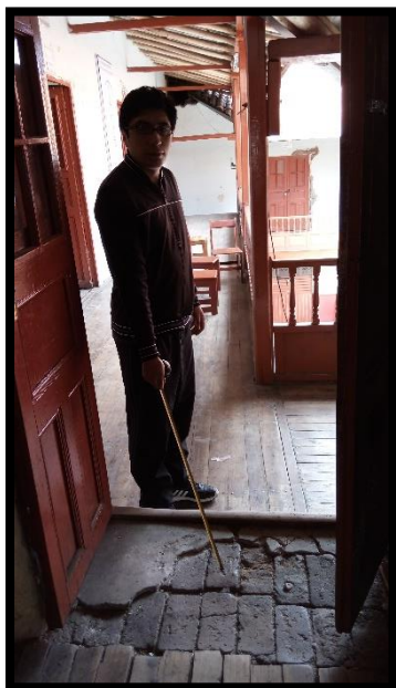
Deterioro de algunos ambientes de la Edificación
