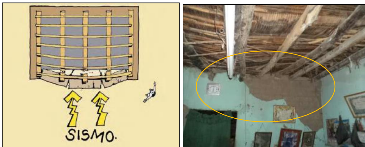
Figura 16: (a) Entrepisos en edificaciones de adobe. (b) Fallas en entrepiso vivienda de adobe, Ica 2007.
