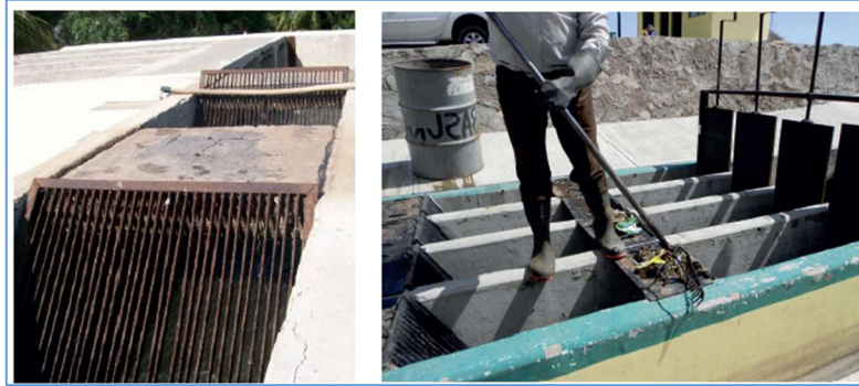
Figura 9: Rejas y rejillas de limpieza manual y su operación, respectivamente
