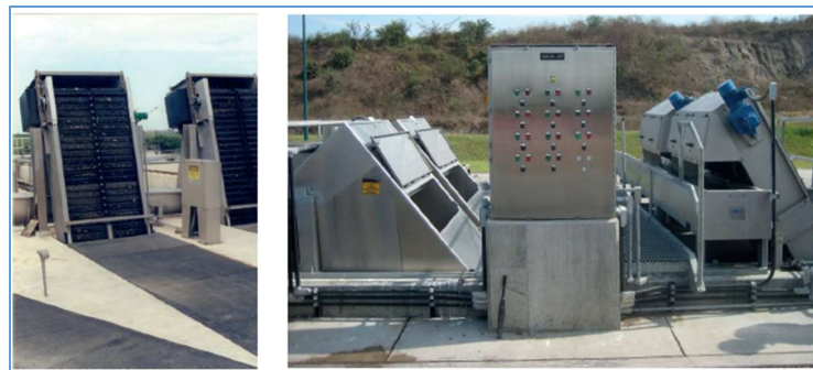
Figura 10: Rejas y rejillas de limpieza automáticas
