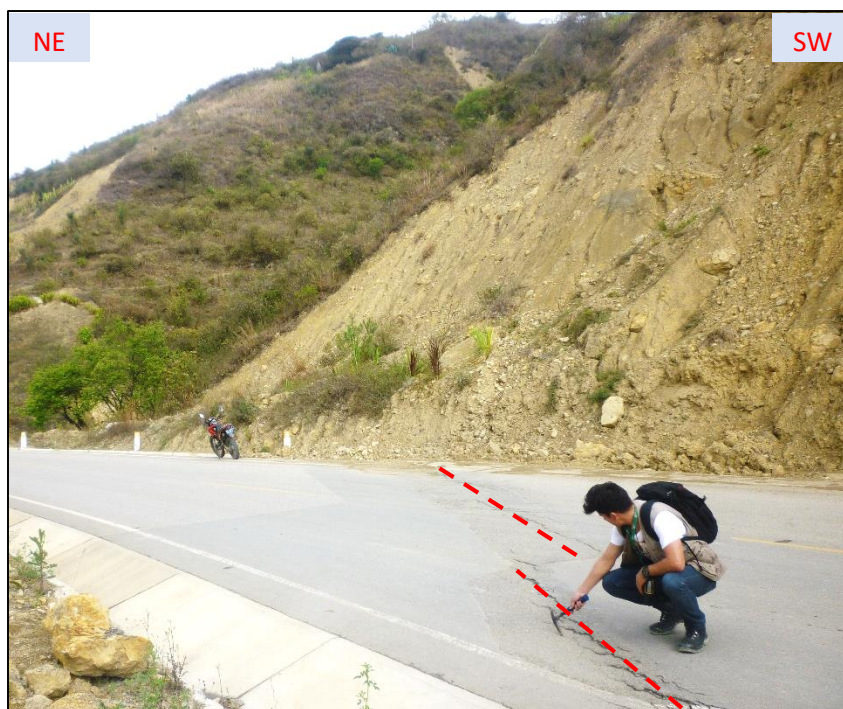
Foto 3.20: Falla de rumbo en el área de investigación. Coordenadas: E 744989, N 9276403, Cota 2050 m.s.n.m.
