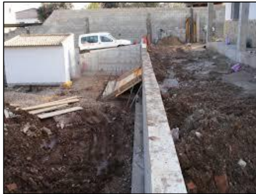
Figura 2.14 Ejecución incorrecta de muro enterrado (Jiménez Luis, 2005)
