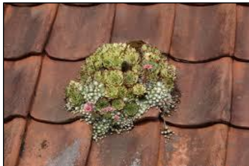
Figura 2.19 Falta de limpieza de una cubierta (Jiménez Luis, 2005)
