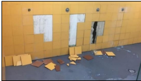
Figura 2.18 Rotura por vandalismo de una evacuación (Jiménez Luis, 2005)
