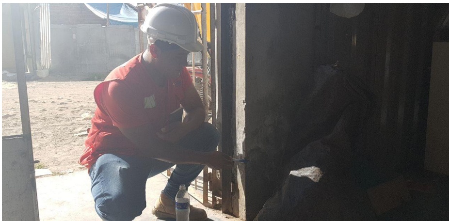
Foto 14: Humedades en interiores de viviendas.
