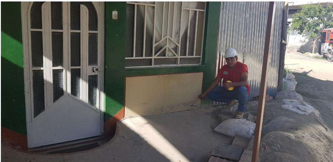
Foto 06: Eflorescencias en muros bajos de viviendas.
