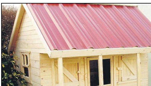
Figura 2.16 Utilización inadecuada de los materiales (disponible en: http://www.lavoz.com.ar/casa-diseno/pura-chapa )
