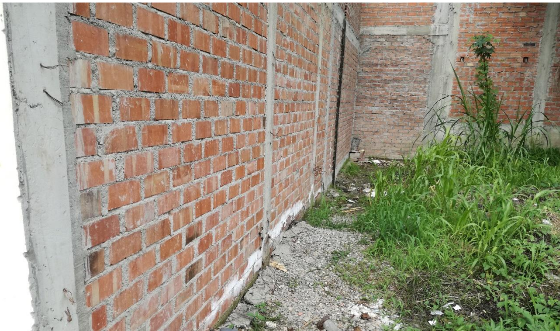
Foto 16: Se aprecia eflorescencias en la parte inferior de la vivienda.
