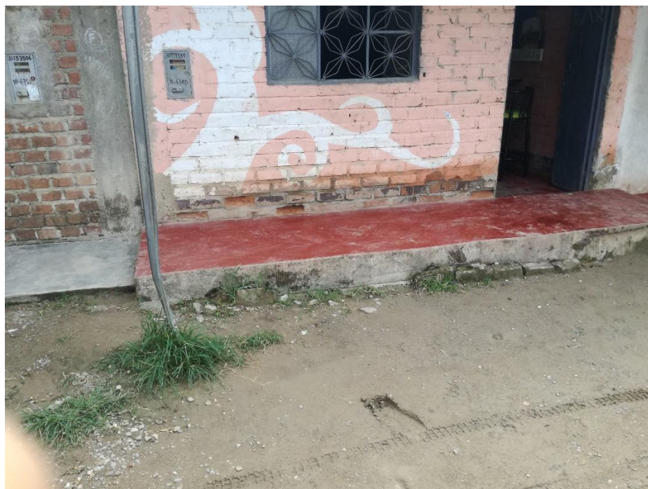
Foto 08: Erosión en ladrillos debido a humedades agresivas.
