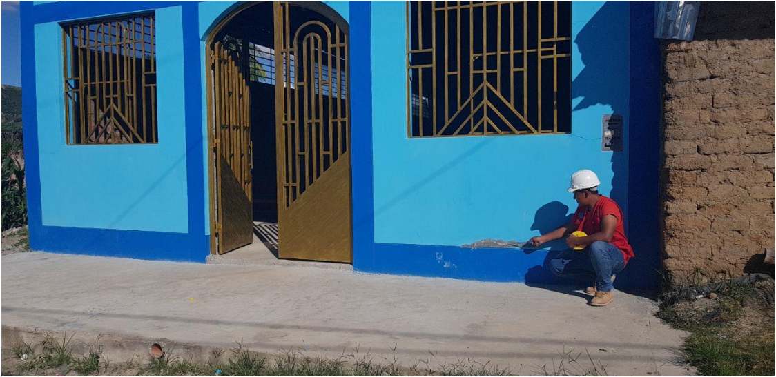
Foto 15: Humedad a una distancia de 0.40 m sobre el nivel del suelo.
