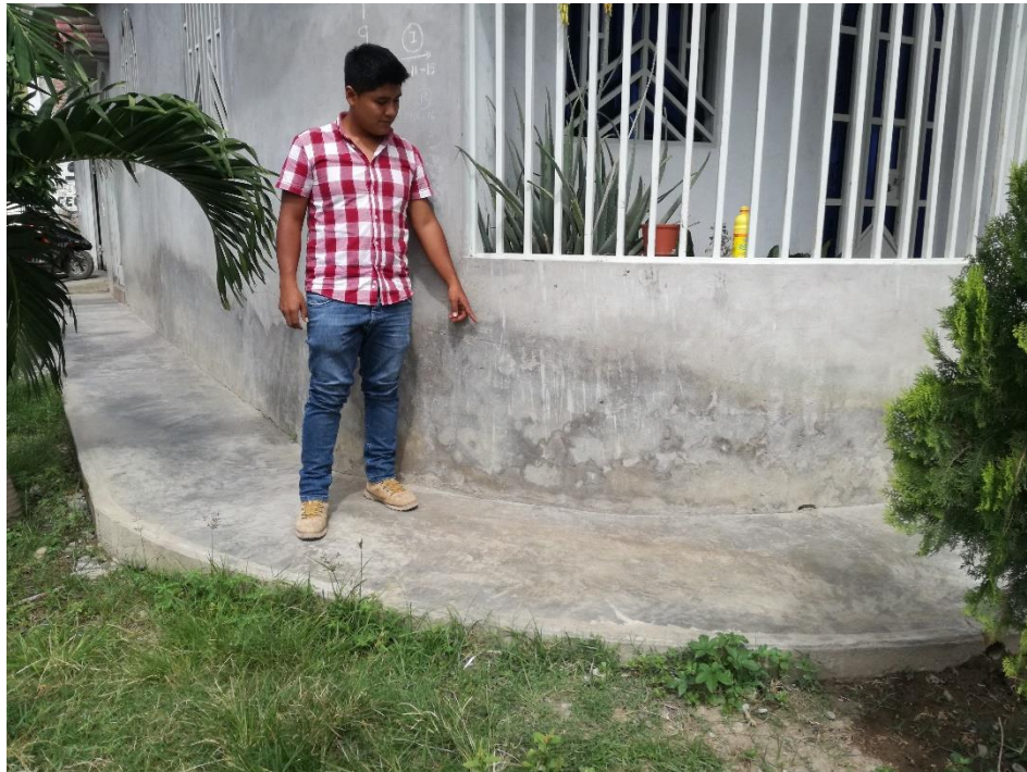
Foto 09: Se aprecia humedades en la mampostería inferior de la vivienda.
