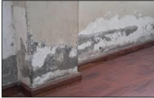
Figura 2.5 Eflorescencias (disponible en: http://elmaestrodecasas.blogspot.com/2011/06/las-eflorescencias.html )
