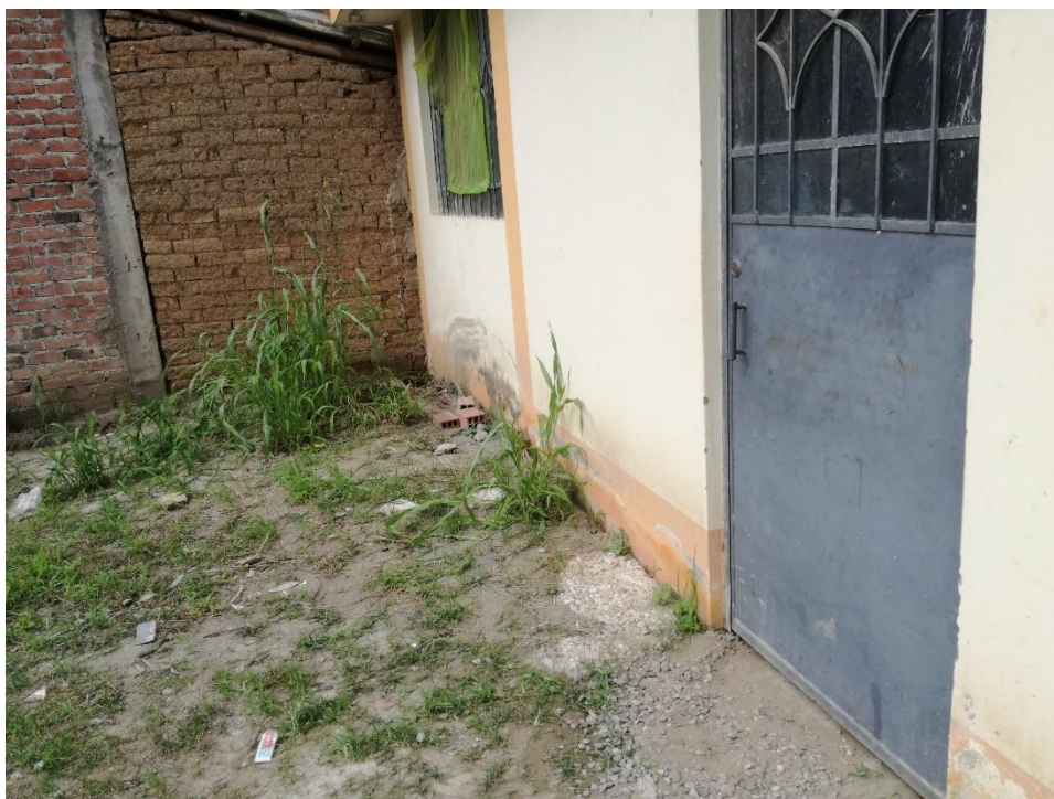
Foto 07: Desprendimiento de pintura a causa de la humedad.
