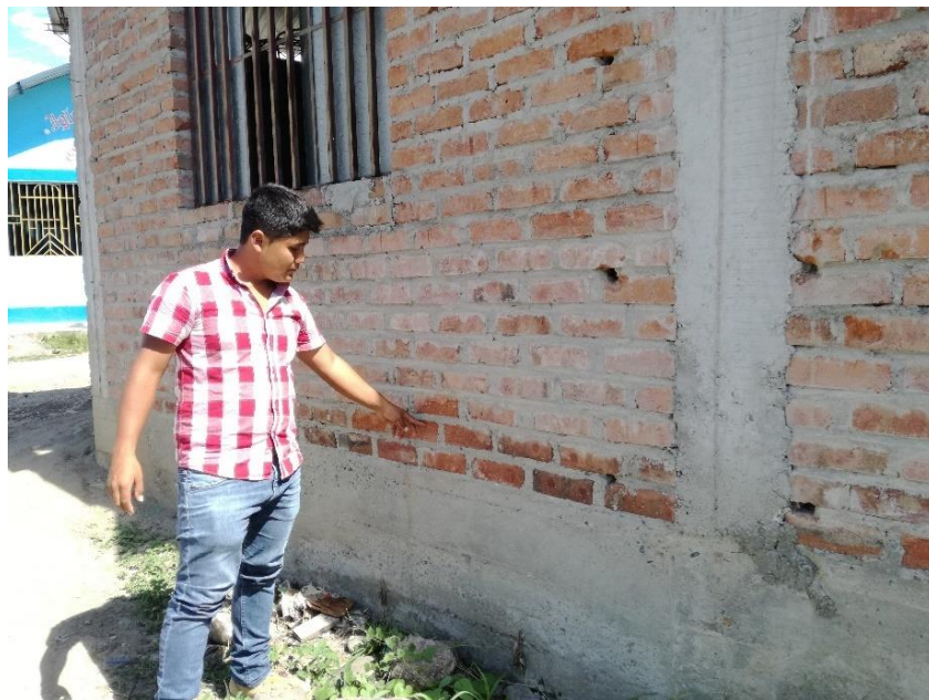
Foto 04: Erosión en muro de ladrillo y concreto.
