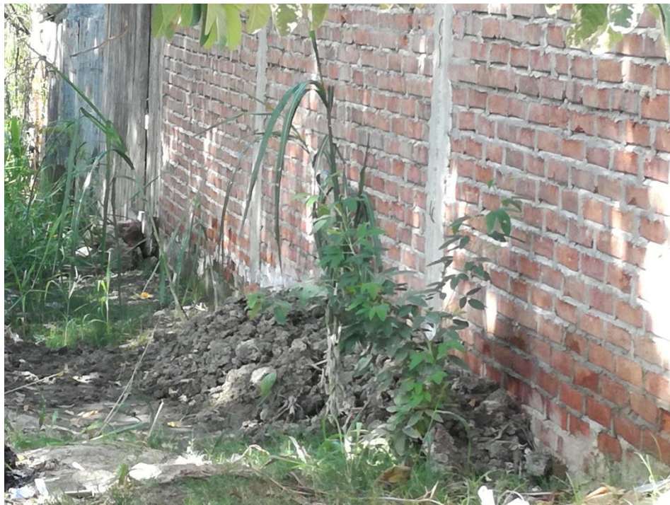
Foto 10: Se aprecia erosión y humedad en ladrillos.
