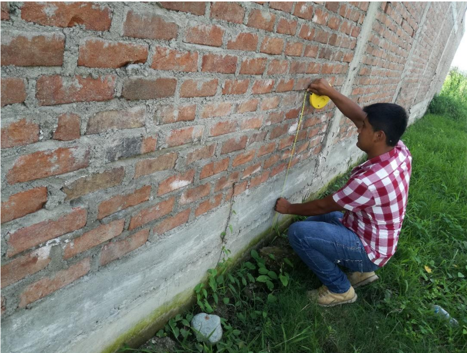
Foto 12: Medición de la altura alcanzada por humedad proveniente del suelo.
