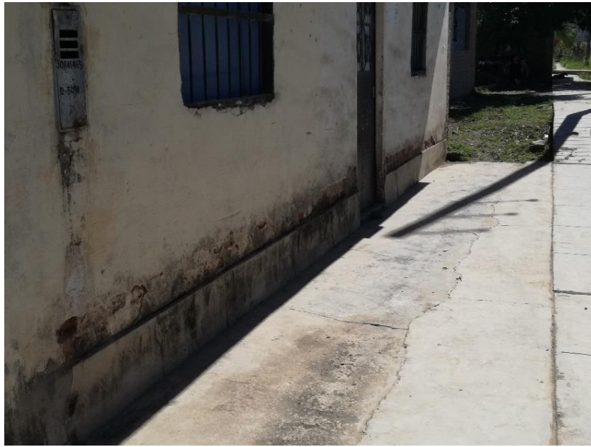
Foto 03: Desprendimiento de ladrillos y mampostería en parte baja de muros.
