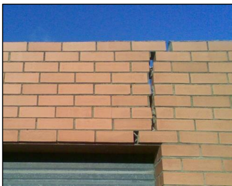
Figura 2.13 Grietas debido a dilataciones (Jiménez Luis, 2005)
