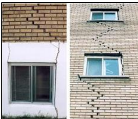
Figura 2.12 Fisuras por asentamiento diferencial (Jiménez Luis, 2005)
