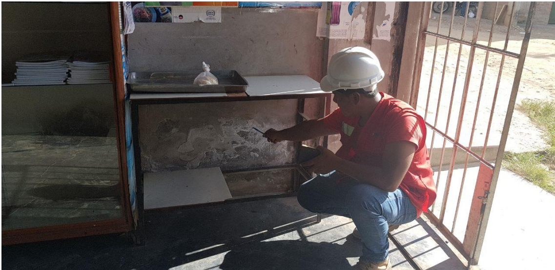
Foto 05: Eflorescencias en muros y columnas de vivienda afectada por la humedad.
