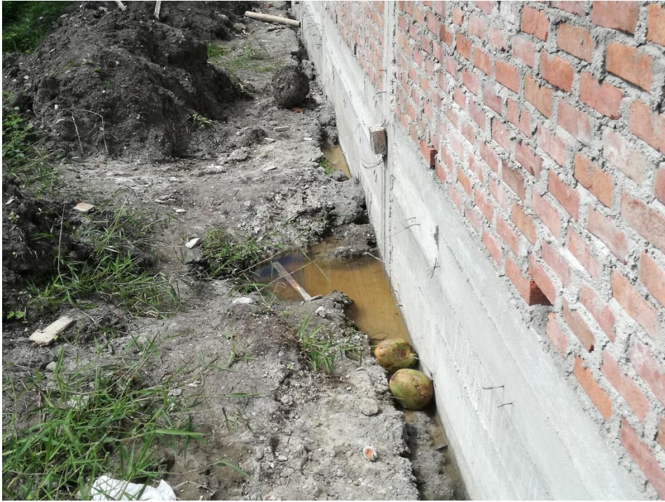
Foto 11: Cimentación afectada por el alto nivel freático en la urbanización Villa María.
