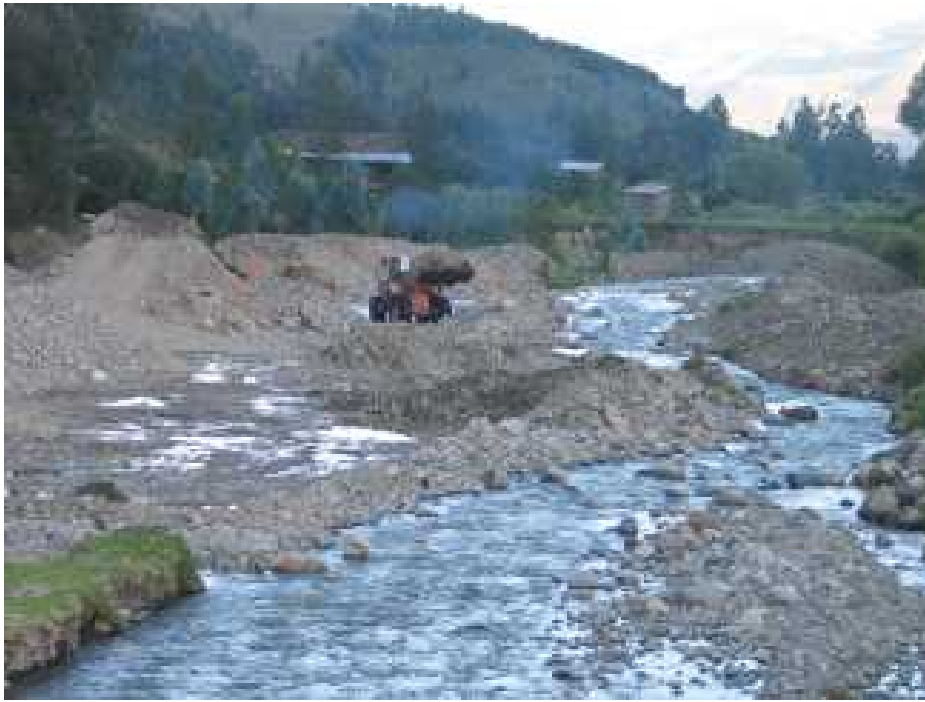
Foto 6. Río Mashcón, modificación y destrucción de su lecho y orillas
