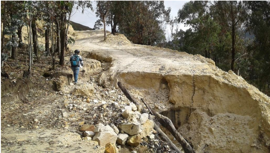
Figura 38. Vía de acceso a la PTAP La Quesera en malas condiciones
