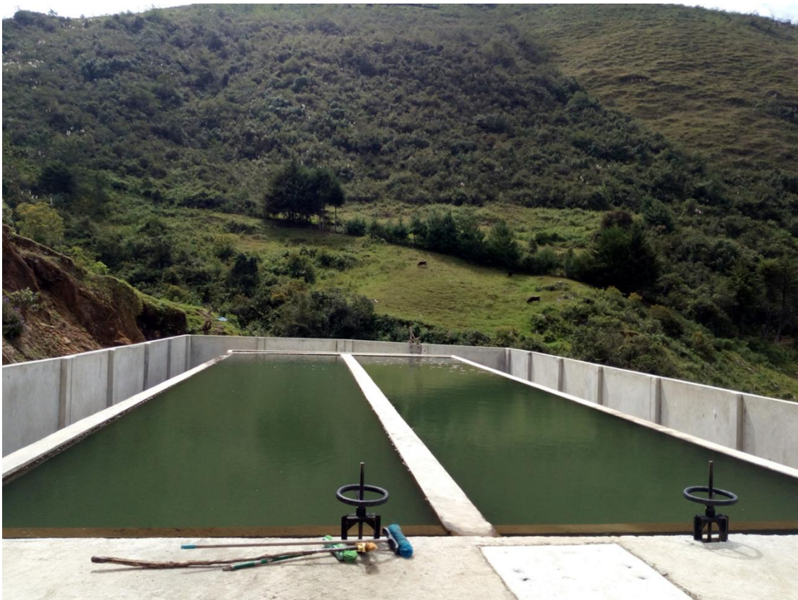
Figura 29. Presedimentador después de la captación manantial La Quesera
