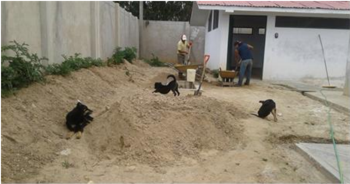
Figura 34. Lavado de arena luego del raspado. Trabajadores sin EPP
