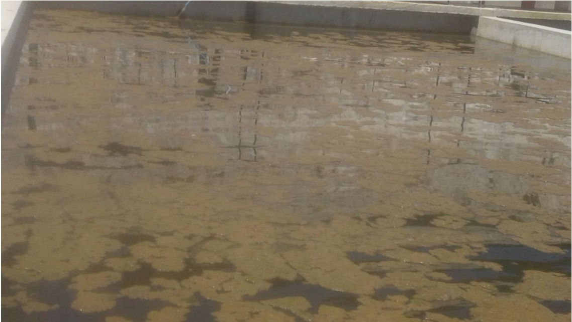
Figura 32. FLA PTAP La Quesera filtros colmatados
