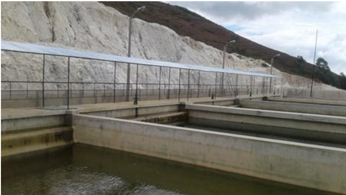
Figura 31. FLA PTAP La Quesera en funcionamiento
