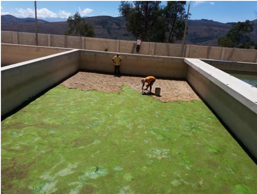
Figura 16. Vista del raspado de la piel de filtro en la PTAP La Quesera
