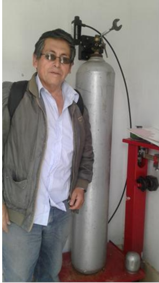
Figura 41. Equipo de cloración de la PTAP La Quesera
