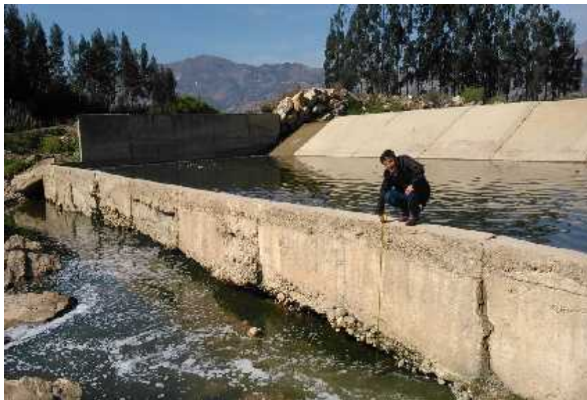
Figura 7. Socavación en estructura de captación Huayrapongo, en río Cajamarquino.
