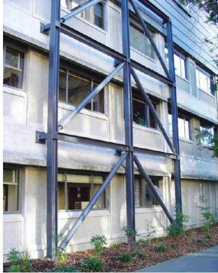
Figura 3: Vista de un pórtico arriostrado de acero utilizado para la rehabilitación de una estructura existente de concreto armado. (Crisafulli 2014: 45)
