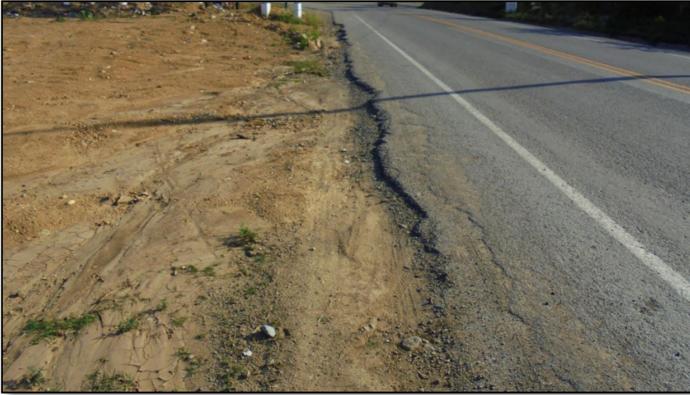
Figura 6 : Falla por grieta de borde
