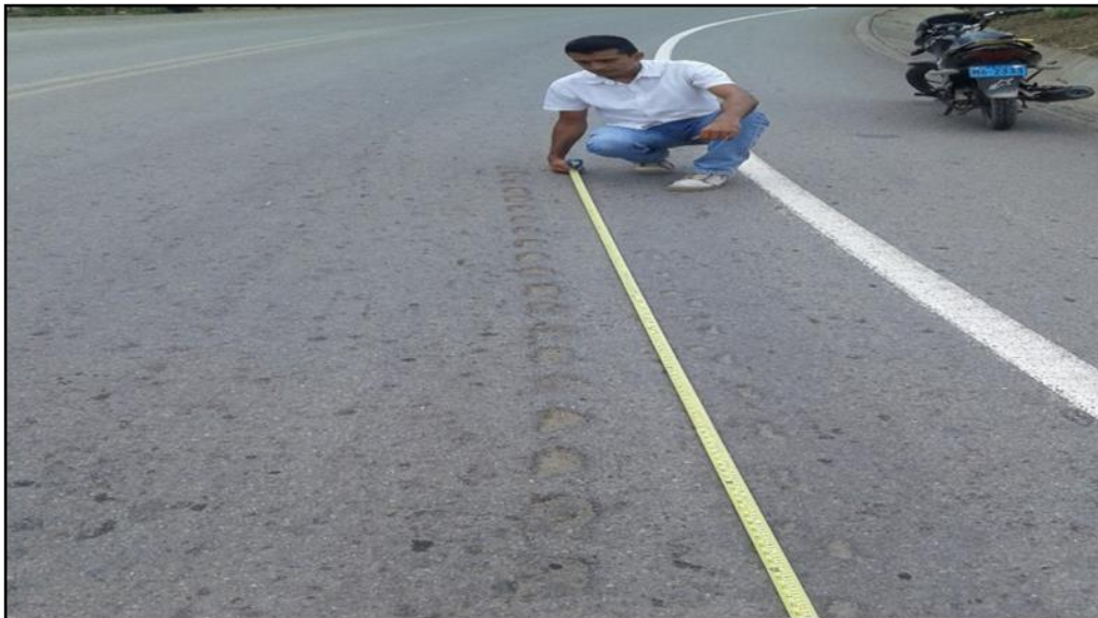
Figura 7: Falla por meteorización
