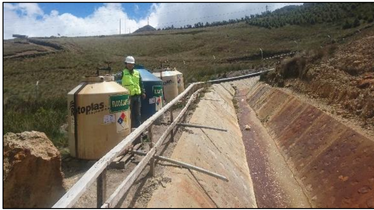
Figura 58: vista general de los tanques de dosificación.
