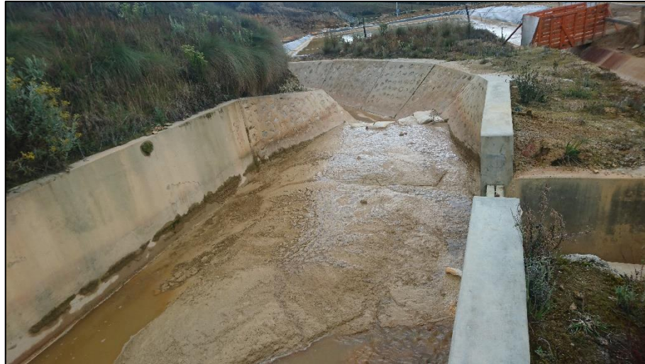
Figura 61: material sedimentado en el desarenador.
