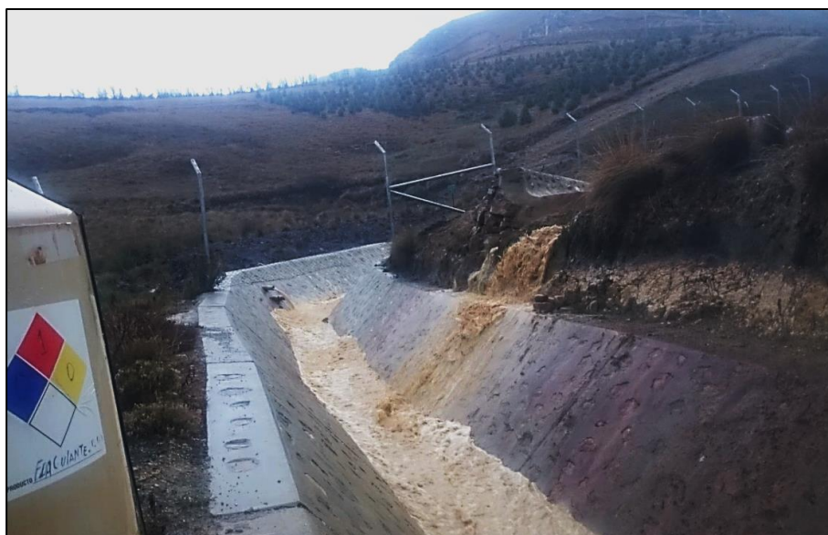
Figura 59: agua de escorrentía que circula por el canal.
