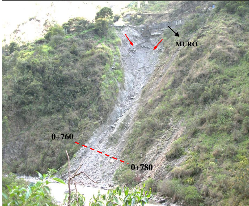
Foto 3.5: Avance de cárcava por deslizamiento de materiales en los taludes naturales de pendiente alta. La línea punteada negra indica el sector que será atravesado por el acceso (Km. 0+760 – Km. 0+780).
