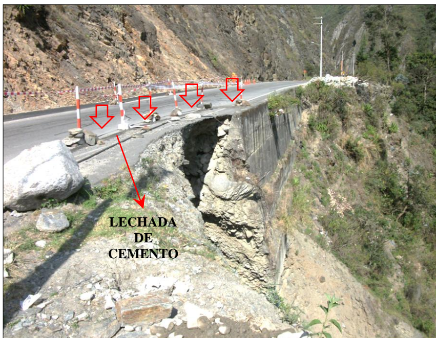
Foto 3.6: Grieta de tracción semicircular en la cabecera del talud inferior de la carretera Tarma – La Merced. Obsérvese, que ésta ha sido rellenada con lechada de cemento para prevenir los efectos del agua.
