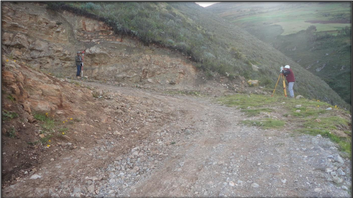
Foto A.6. Curva n° 49 ubicada en la progresiva 2 + 100.67, donde se observa una pendiente fuerte, poco sobreebancho, no hay cunetas ni señalización.
