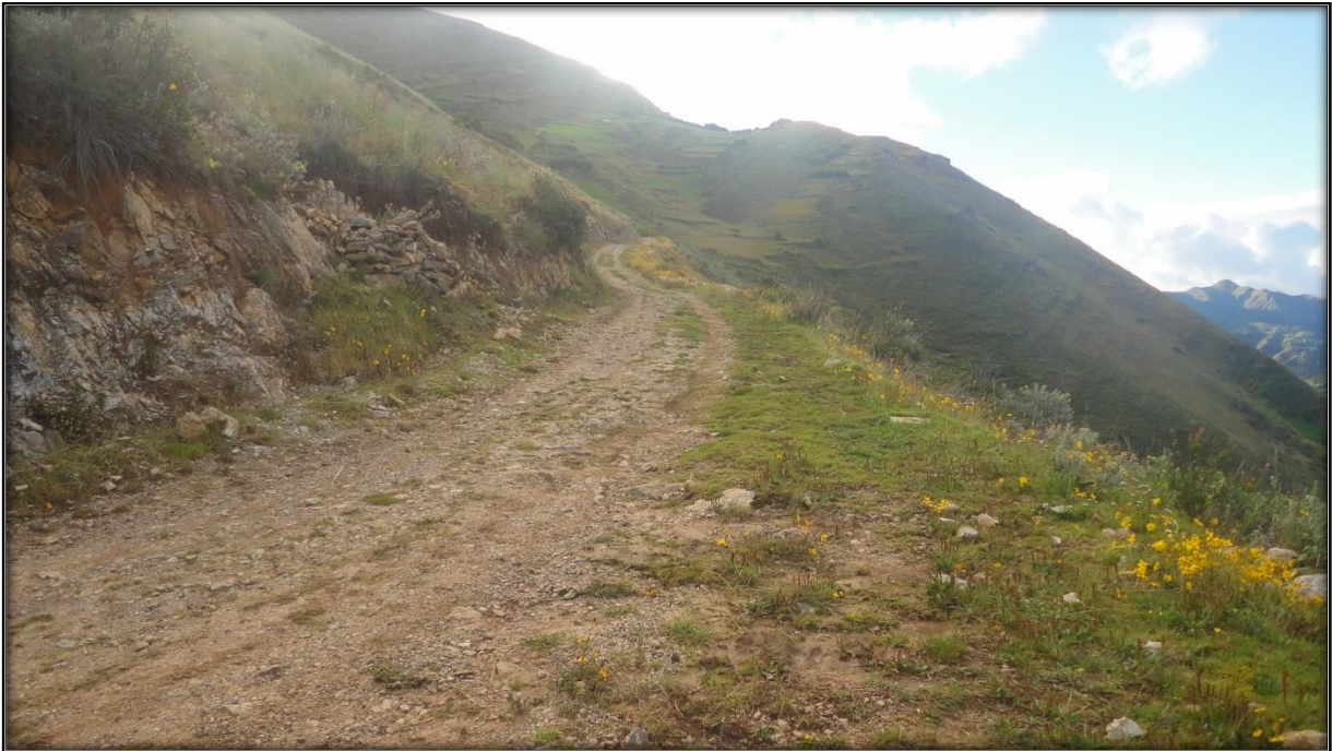
Foto A.10. En la fotografía se puede observar la falta de cunetas.
