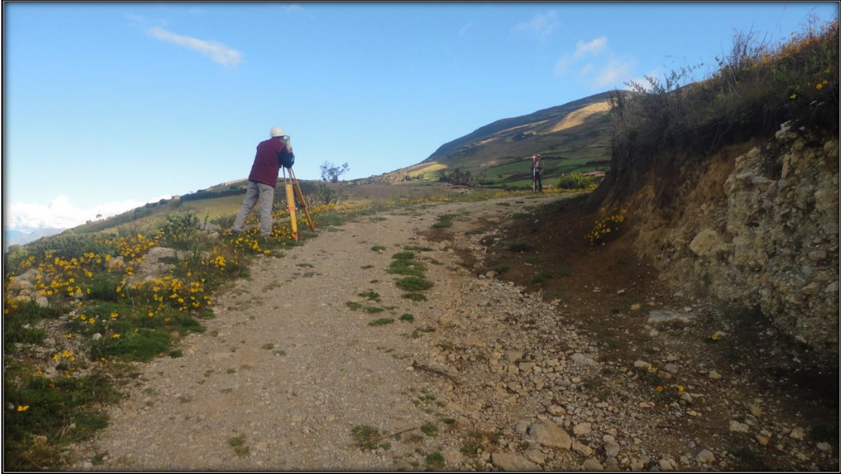
Foto A.7. Curva n° 85 ubicada en la progresiva 3 + 644.93, no hay obras de arte como es las cunetas.
