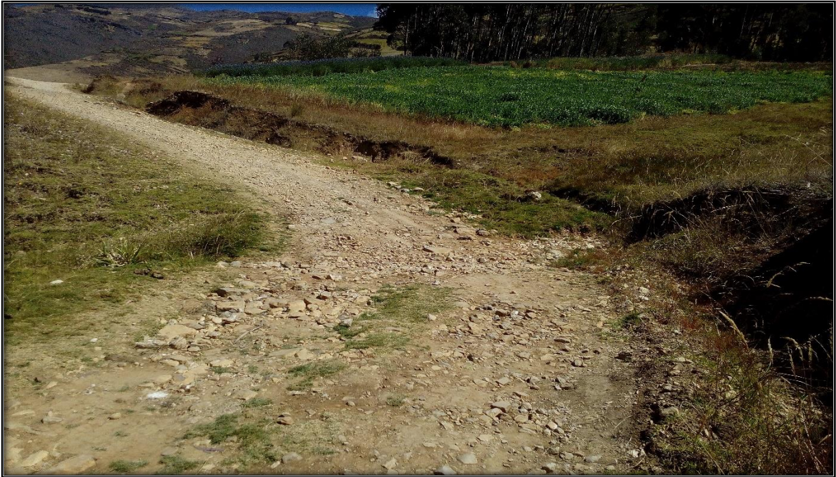
Foto A.9. Se observa que necesita una alcantarilla, no existe obras de arte en toda la vía, solo hay escasos tramos con cunetas como este que en inicio de la carretera km 00 + 062.00.
