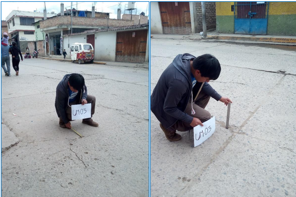
Tipo de fallas: Grietas en bloque y grieta longitudinal.
