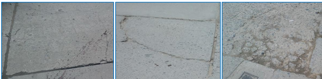
Figura N° 0 12: De izquierda a derecha, fisura de esquina de baja, media y alta severidad.
