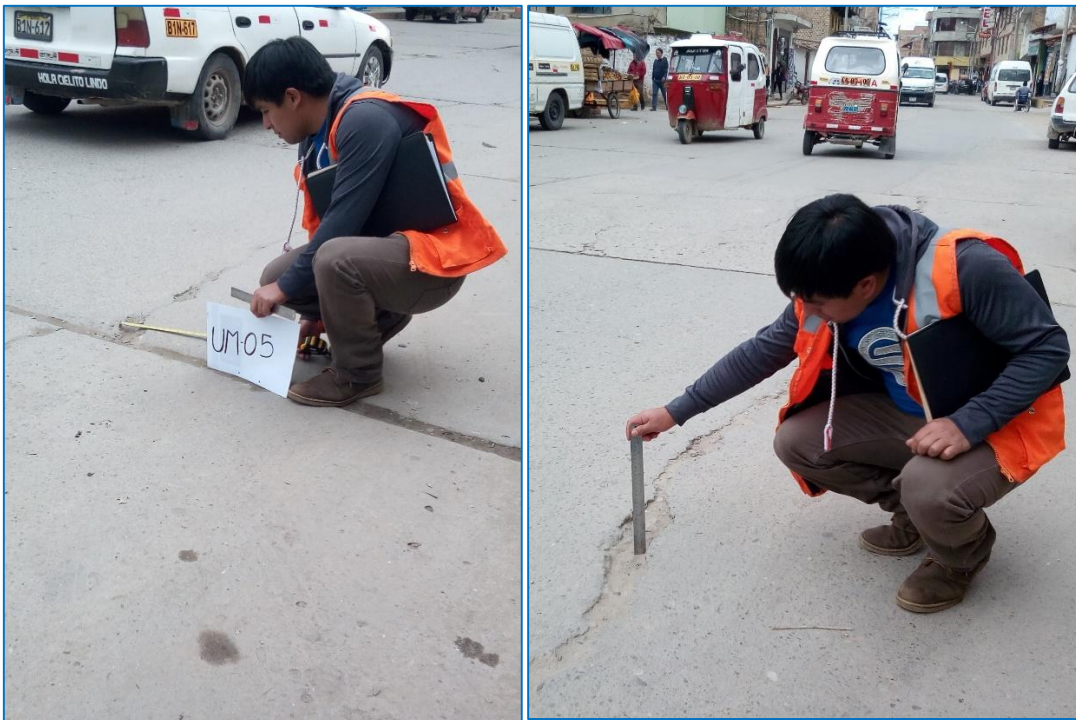
Tipo de fallas: Grietas longitudinal.
