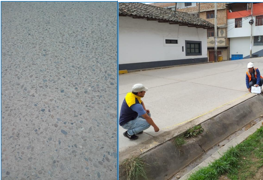
Tipo de fallas: Pulimiento de agregados y medida de paño.
