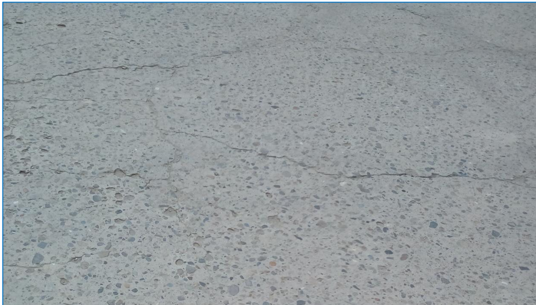
Figura N° 0 27: Fisuras de contracción.
