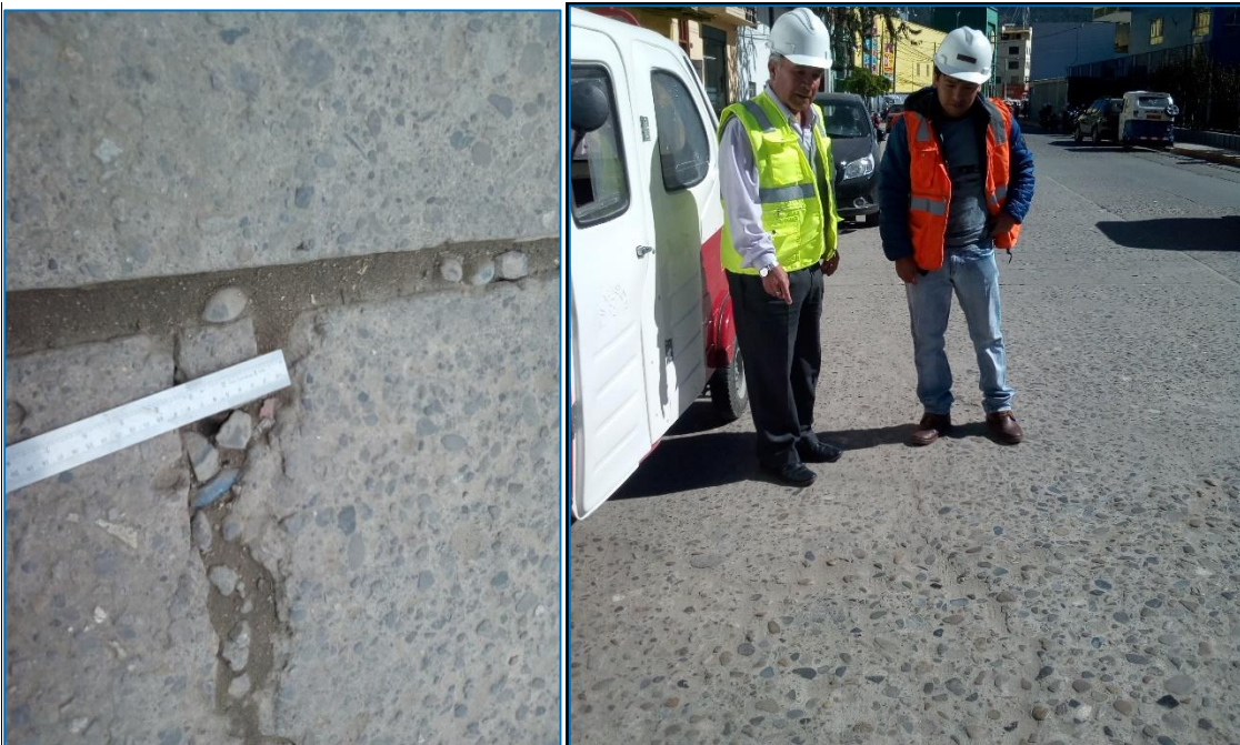
Tipo de fallas: Grieta longitudinal y pulimiento de agregados.
