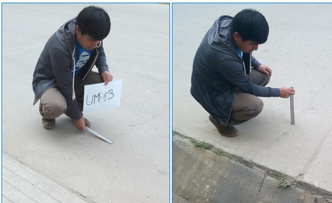
Tipo de fallas: Grieta transversal y grietas de retracción.
