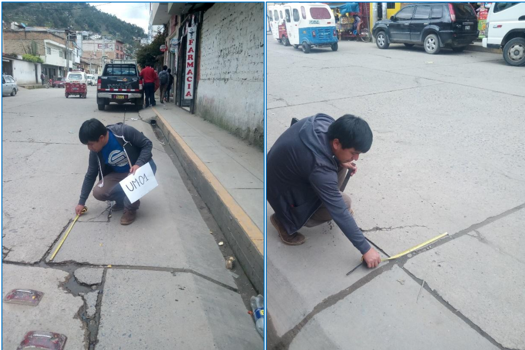
Tipo de fallas: Parche grande y grieta de esquina.
