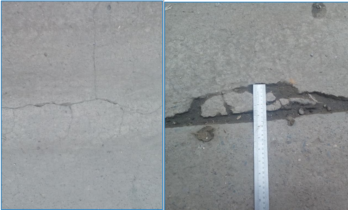
Tipo de fallas: Grieta retracción y descascaramiento de junta.
