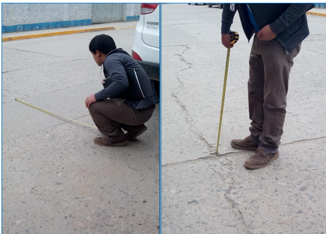
Tipo de fallas: Parche grande y grieta longitudinal.
