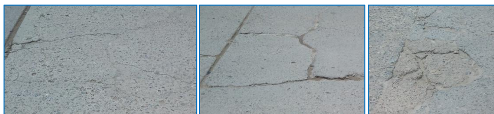
Figura N° 0 13: De izquierda a derecha, falla por losa dividida de baja, media y alta severidad.
