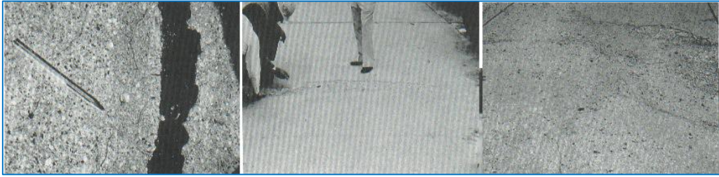
Figura N° 0 14: De izquierda a derecha, falla de grieta de durabilidad de baja, media y alta severidad.
