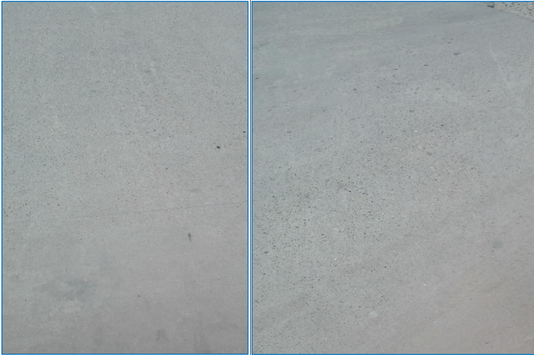
Tipo de fallas: Grietas de retracción.
