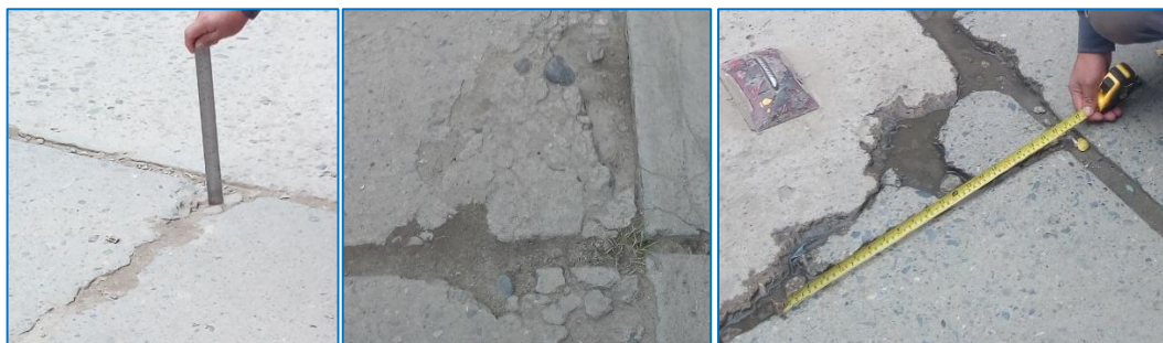
Figura N° 0 28: De izquierda a derecha, descascamiento de esquina de baja, media y alta severidad.
