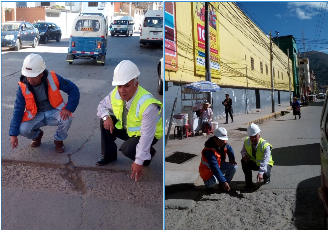
Descripción: Parche grade deteriorado en UM -07. Pulimiento de agregados en UM-13.
