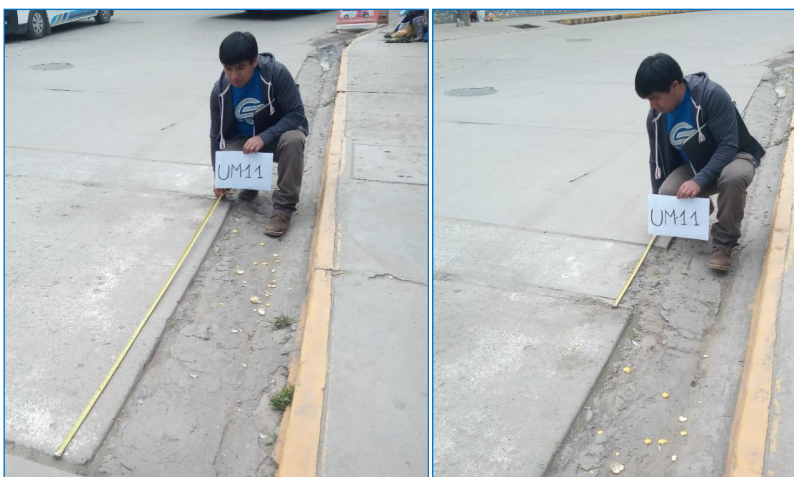
Tipo de fallas: Parche grande y descascamiento de junta.
