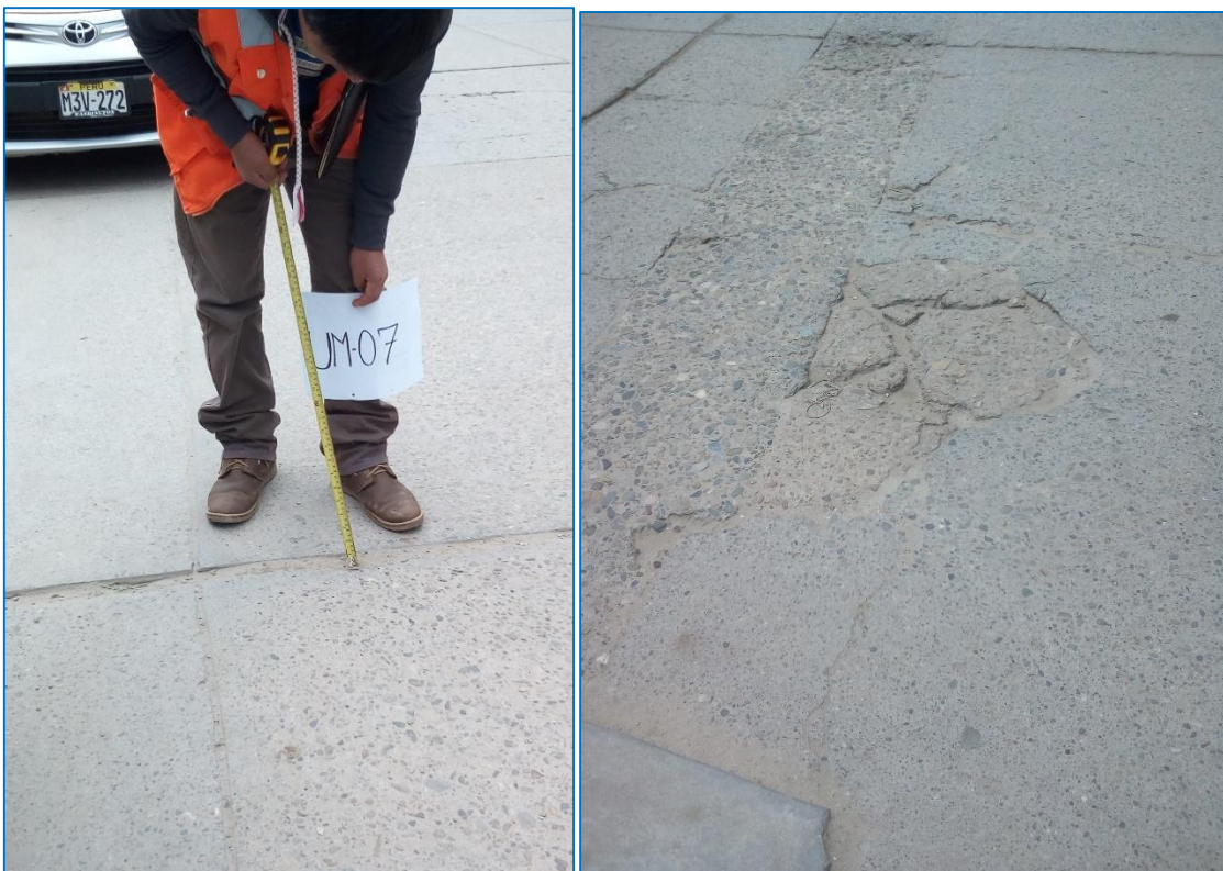
Tipo de fallas: Grietas longitudinal y grietas en bloque.
