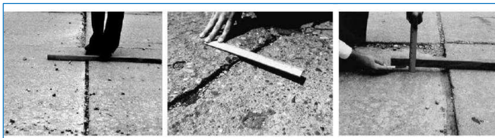
Figura N° 0 15: De izquierda a derecha, falla por escalonamiento de baja, media y alta severidad.
