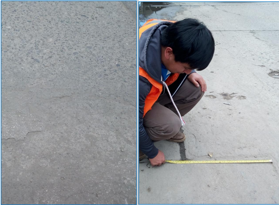
Tipo de fallas: Pulimiento de agregados y parche grande.
