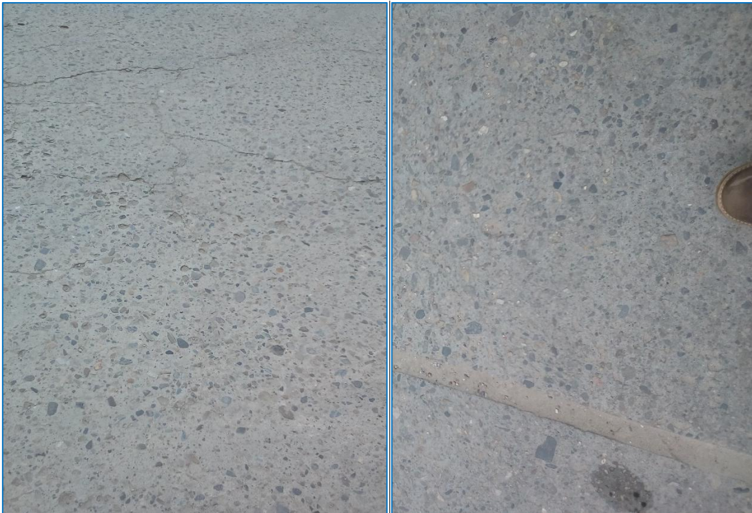
Tipo de fallas: Grietas de retracción y pulimiento de agregados.
