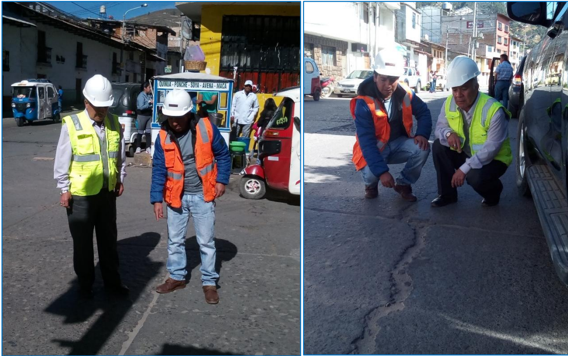
Descripción: Punto de inicio del pavimento de estudio. Grieta longitudinal en UM 03 severidad alta.
