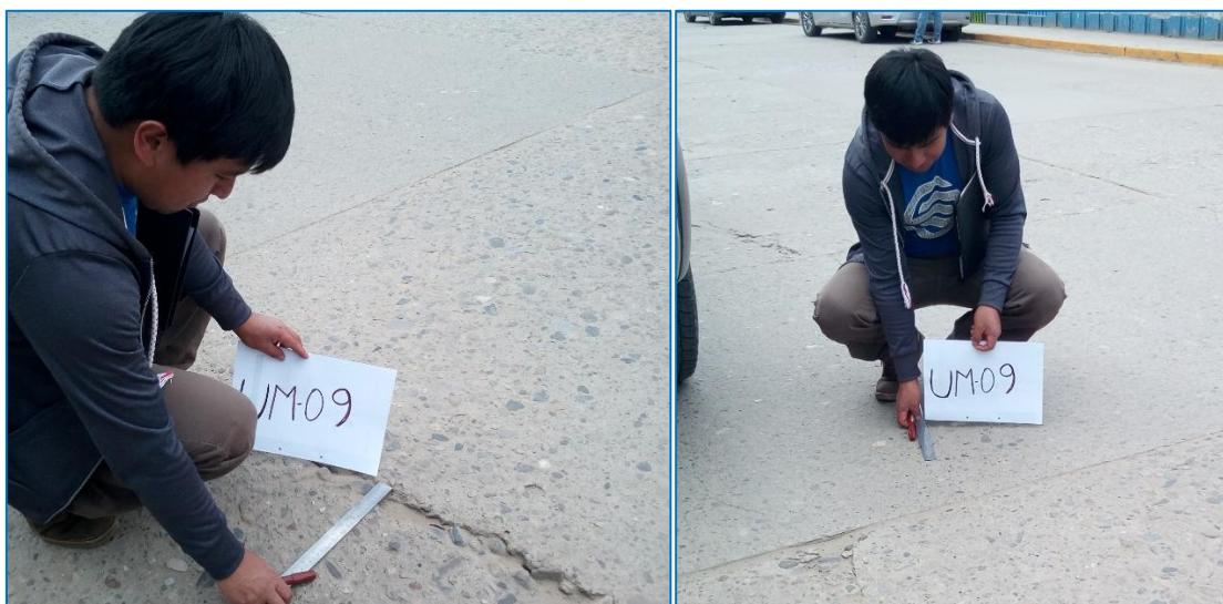
Tipo de fallas: Grietas longitudinal y grietas de retracción.
