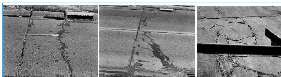
Figura N° 0 24: De izquierda a derecha, falla por punzonamiento, de baja, media y alta severidad respectivamente.
