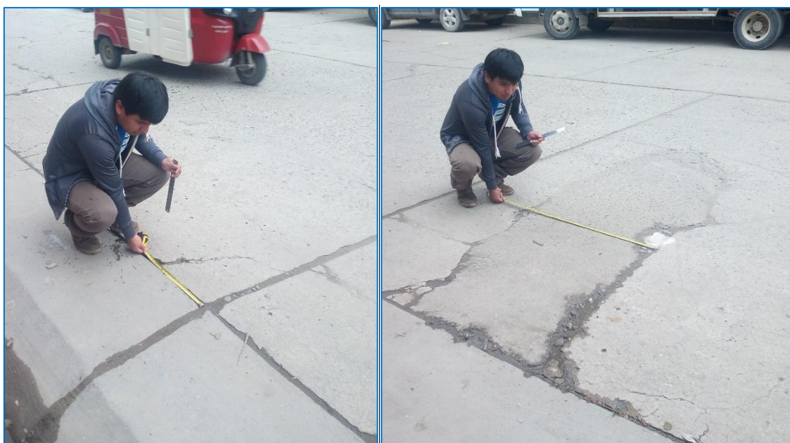
Tipo de fallas: Grieta esquina y parche grande.
