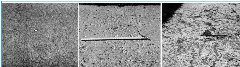
Figura N° 0 26: De izquierda a derecha, mapa de grietas de baja, media y alta severidad.
