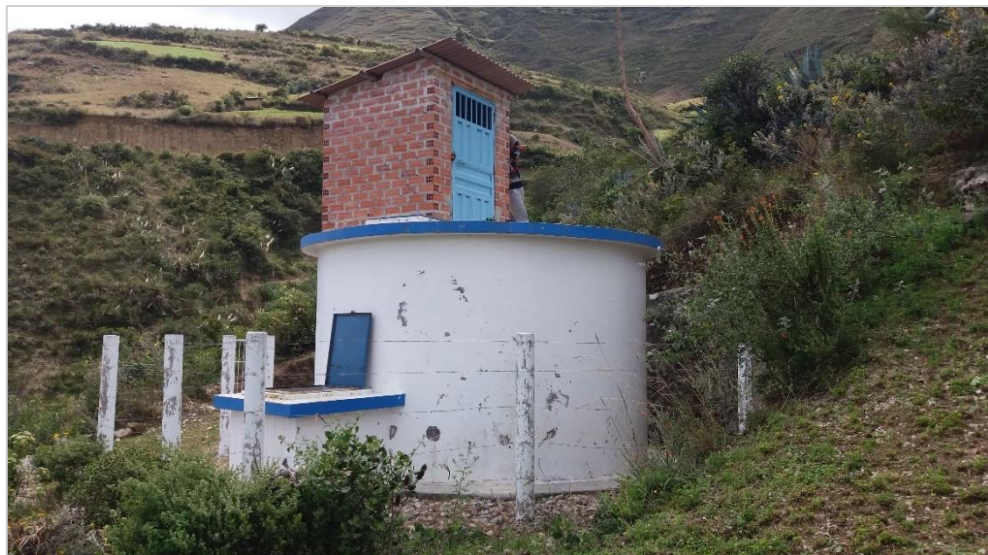
Figura 8. Reservorio Sistema de Agua Potable Bellavista.
