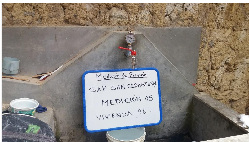
Figura 15. Medición de presiones en el sistema de agua potable San Sebastián.
