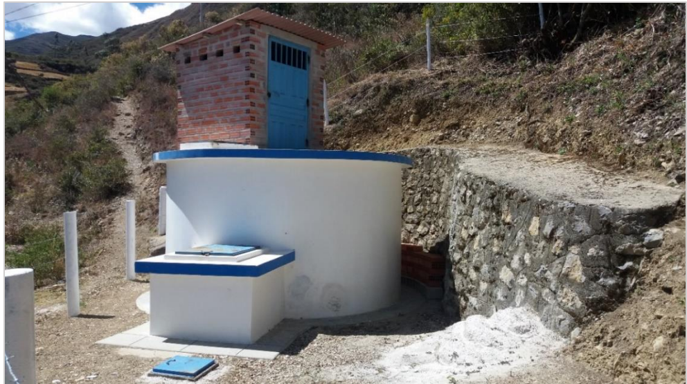
Figura 23. Vista de la caseta de cloración en el reservorio San Sebastián.
