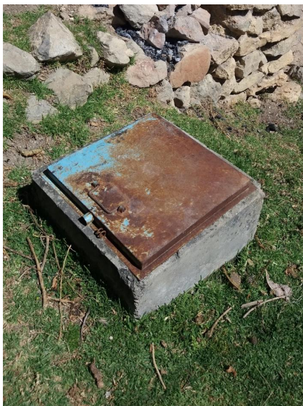
Figura 24 Válvula de purga en mal estado.
