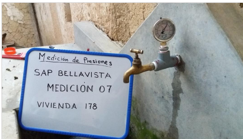
Figura 14. Medición de presiones en el sistema de agua potable Bellavista
