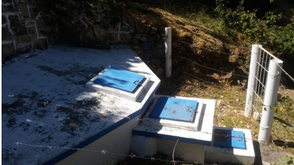
Figura 6. Captación El Pulchac, Sistema de Agua Potable Bellavista
