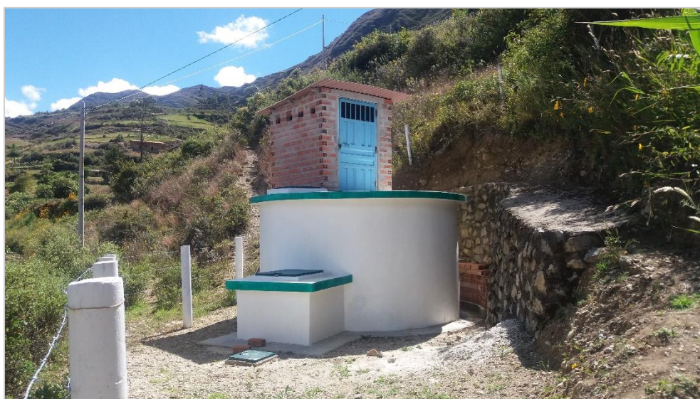
Figura 9. Reservoirio Sistema de Agua Potable San Sebastián.
