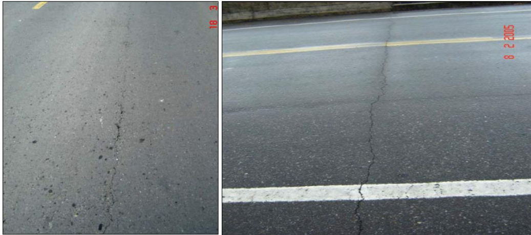
Figura 9: Fisuras Longitudinales y transversales.
