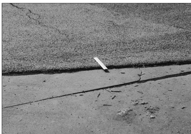
Figura 19: Desplazamiento en calzada
