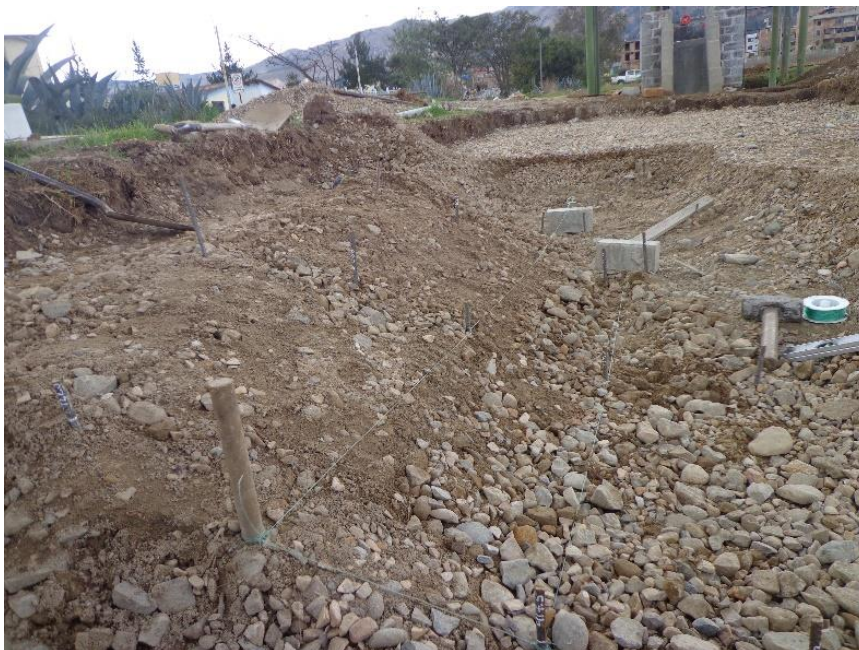
Figura 38. Unimos cada punto con la misma descripción de altura y unimos utilizando nylon y procedemos a nivelar con un nivel de carpintero de tal manera que queden a la misma altura.
