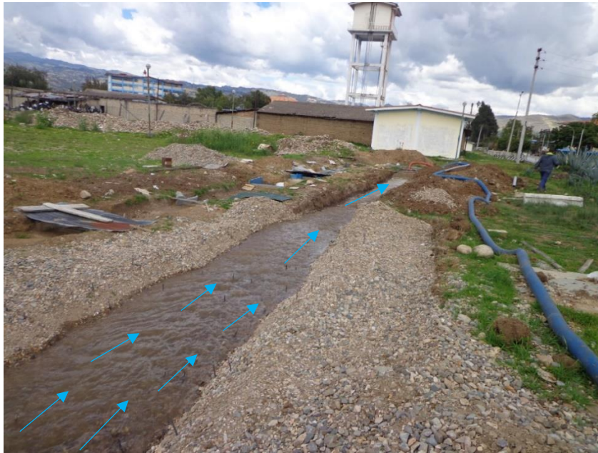
Figura 41. Sistema de recirculación (Cisterna, manguera HDPE 4", motobomba)
