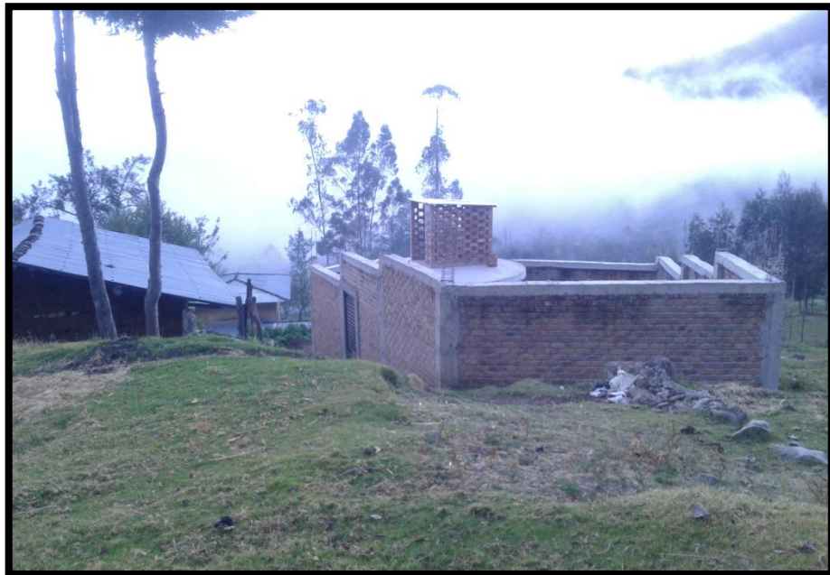
Figura 16. Tanque de almacenamiento y tratamiento del agua de manantial El Ojo de Agua-San Pedro
