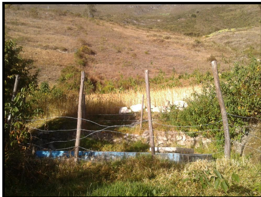
Figura 12. Punto de captación del Manantial El Ojo de Agua-San Pedro
