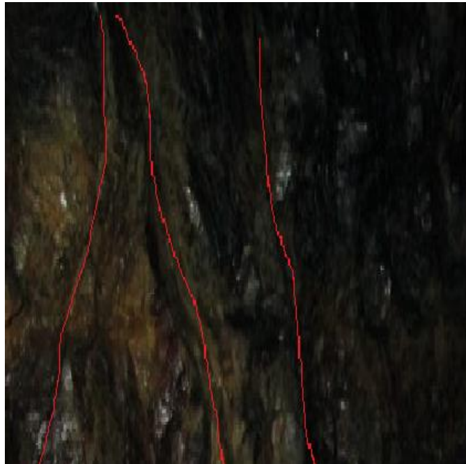
Foto 20: Ventana 6 presenta 3 discontinuidades
