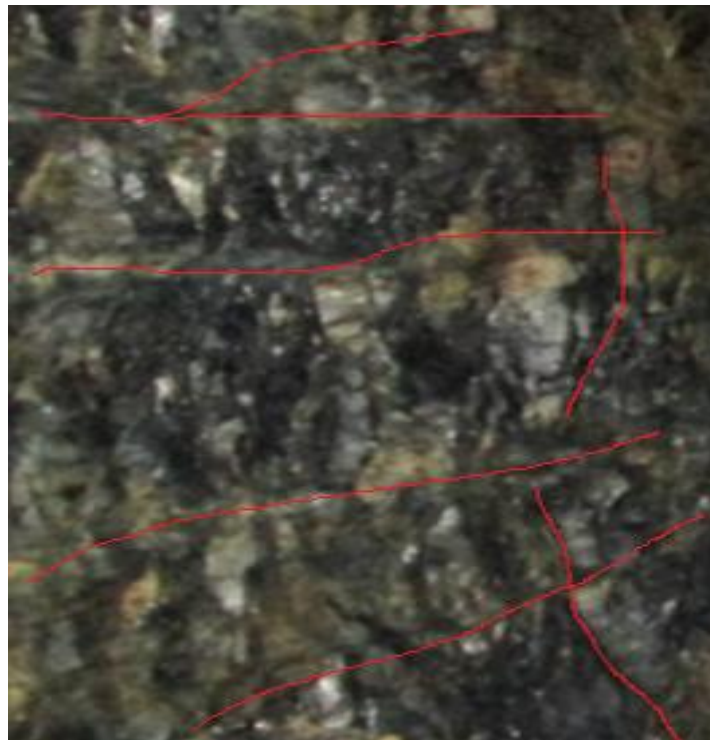
Foto 17: Ventana 3 , presenta 7 discontinuidades
