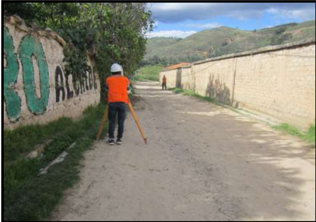
Fotografía N° 4: Levantamiento del borde del camino vecinal km 09+500 al km 10+000.
