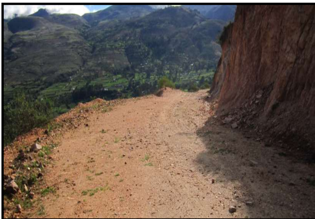
Fotografía N° 24: Distancia de visibilidad inadecuada.
