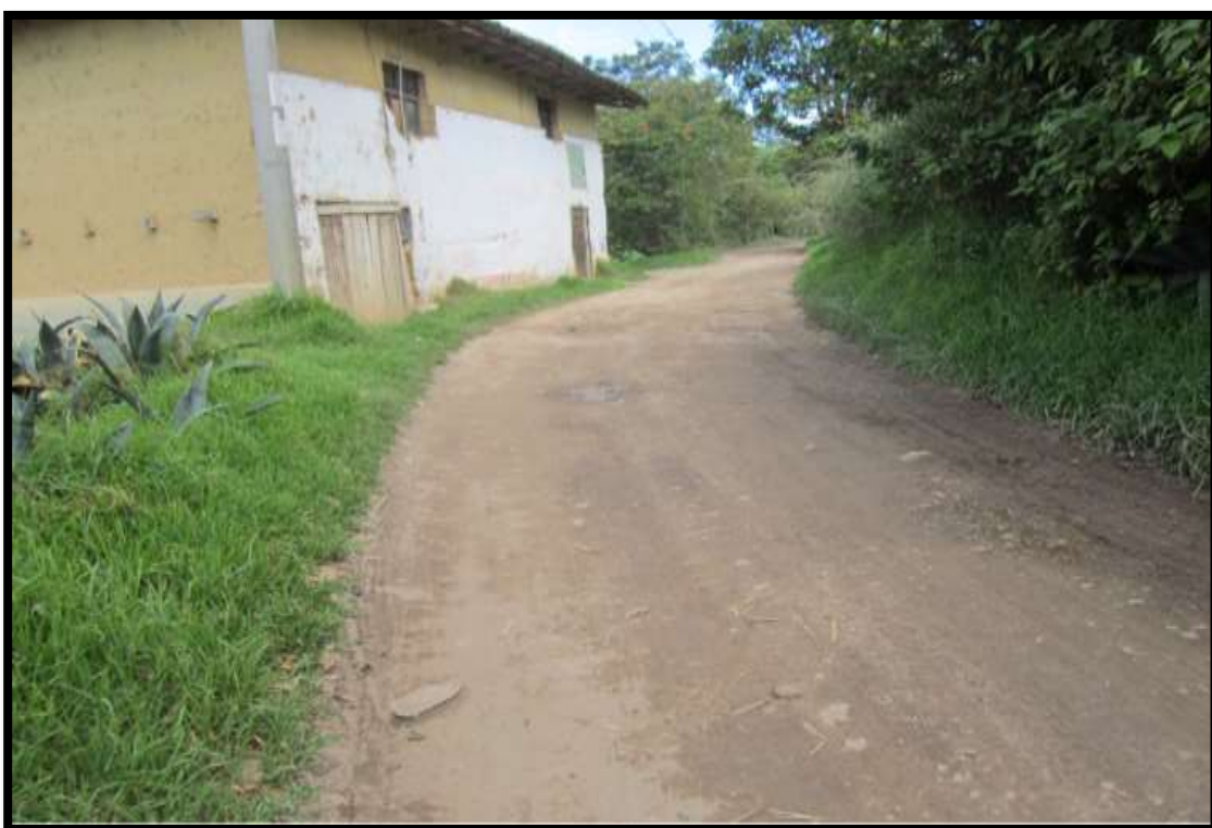
Fotografía N° 12: Cunetas cubiertas totalmente por vegetación.
