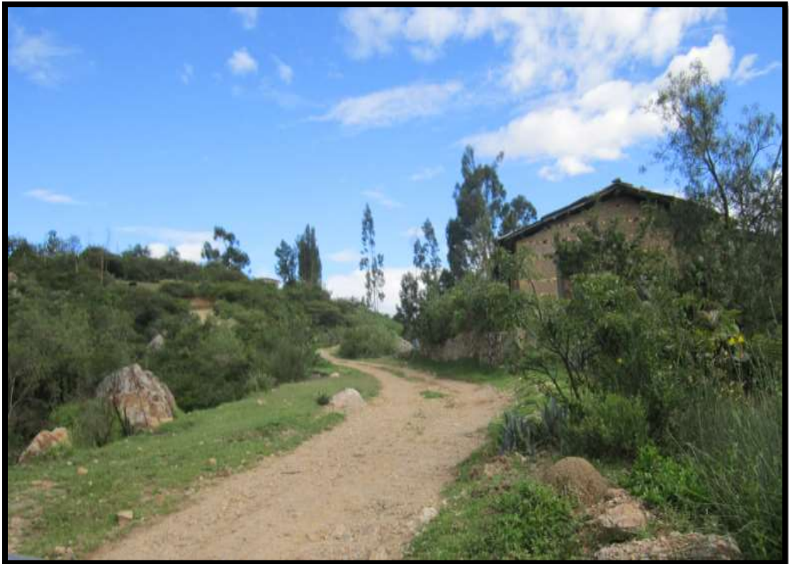
Fotografía N° 20: Inexistencia de cunetas.
