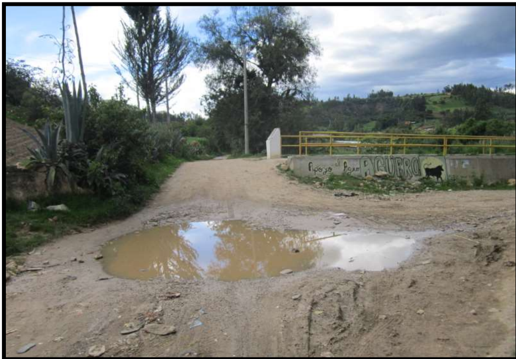
Fotografía N° 10: Mal estado de la calzada debido a que no se cuenta con el bombeo adecuado y la inexistencia de cunetas.
