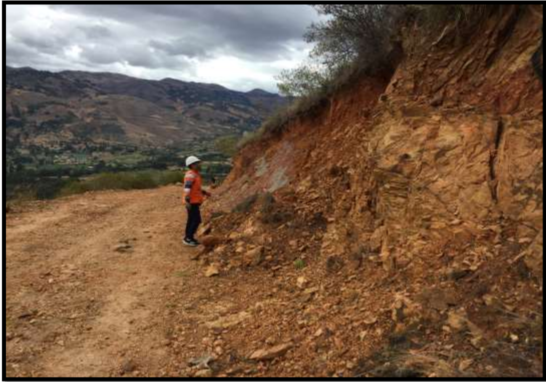
Fotografía N° 21: Talud inestable y cuneta colmatada.
