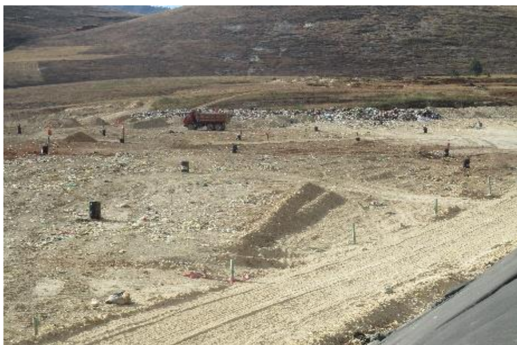
Figura 7. Chimeneas y filtros
