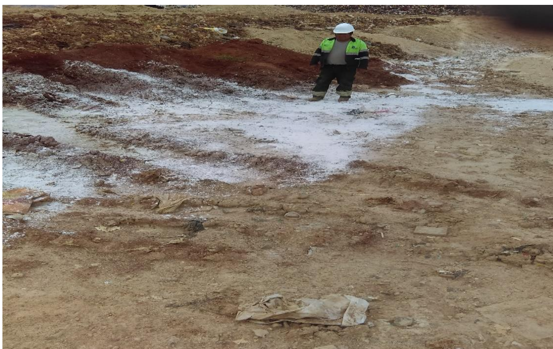
Figura 9. Monitoreo y mitigación ambiental en la Planta de tratamiento de RR.SS.
