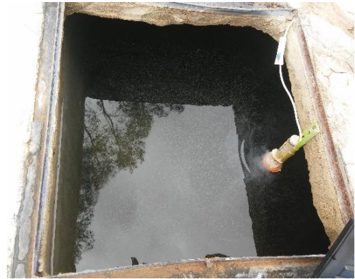
Figura N° 13. Control del nivel estático del reservorio
