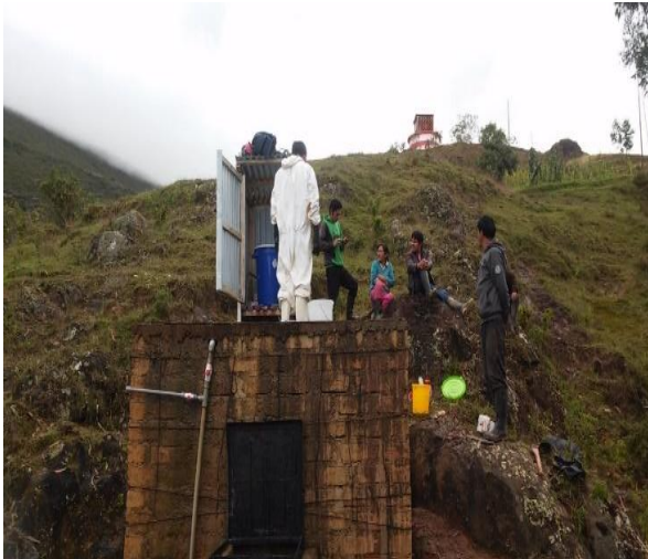
Figura N° 14. En coordinación con la JASS se coordinó para realizar la limpieza del reservorio
