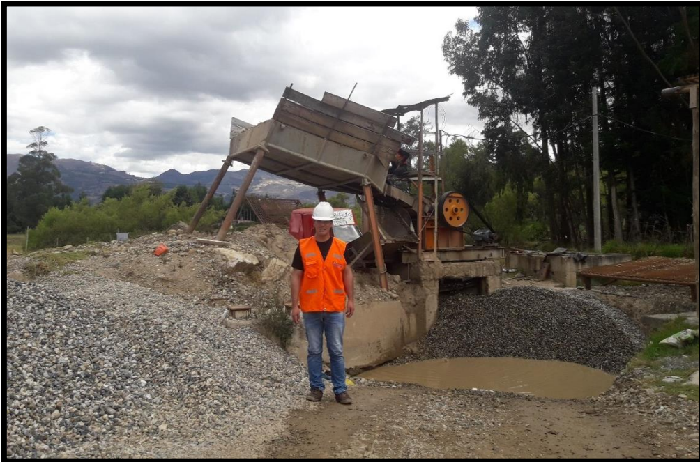
Figura 17: Chancadora de la cantera Tartar Chico, Ubicado a orilla del Río Chonta, Distrito de Baños Del Inca.
