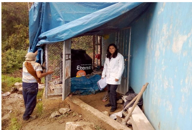
Figura19. Sistema de cloración
