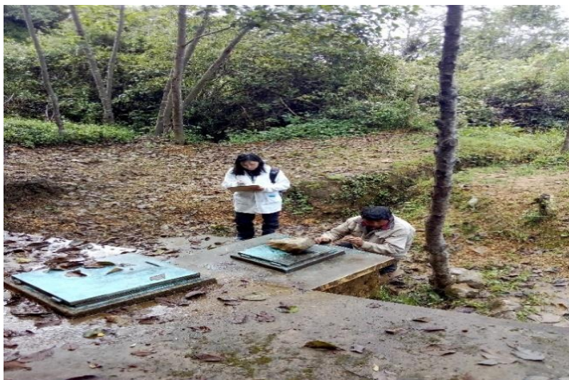
Figura 15. Captación de agua
