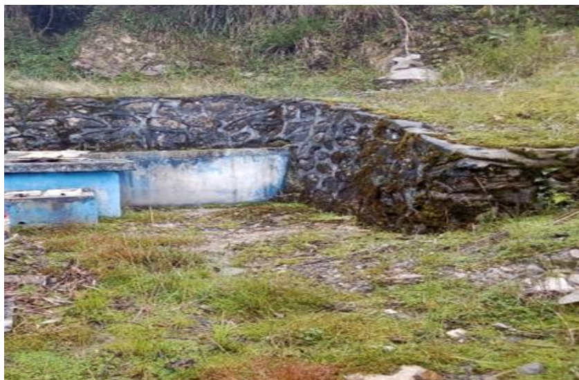
Figura 24. Captación de agua
