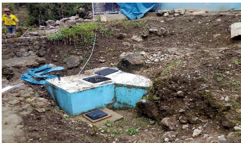
Figura 18. Captación y reservorio del sistema
