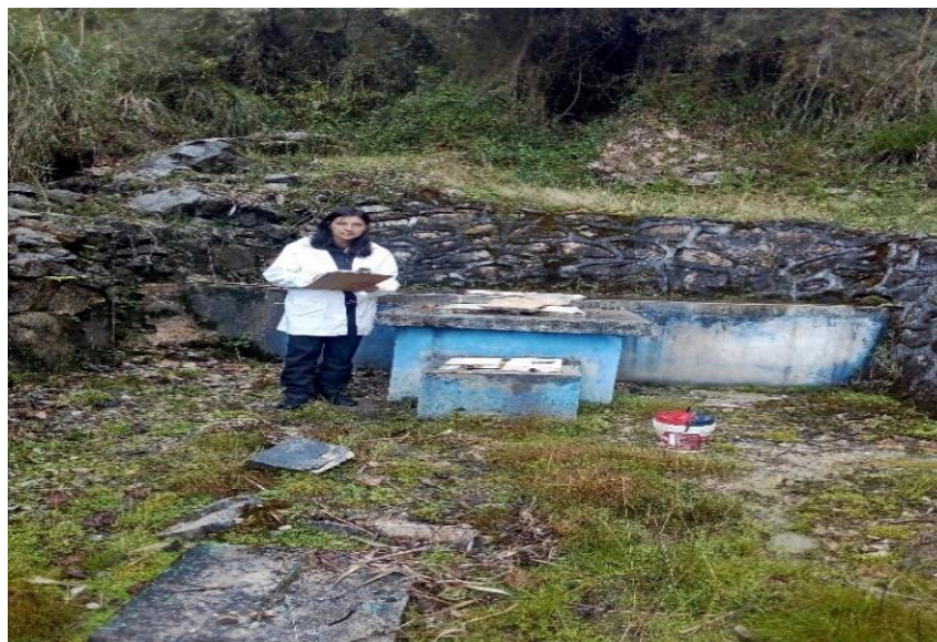
Figura 21. Captación de agua
