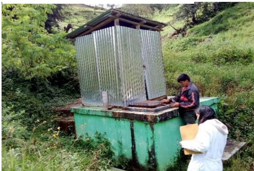
Figura 28. Captación 02 del sistema
