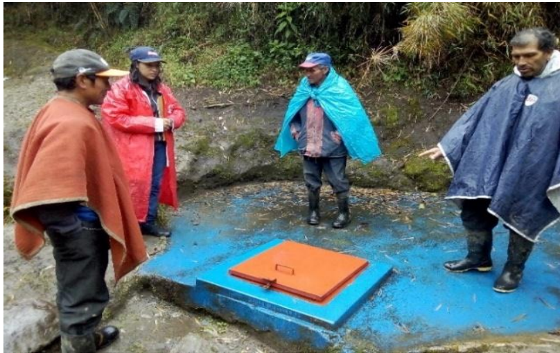
Figura 12. Captación del sistema
