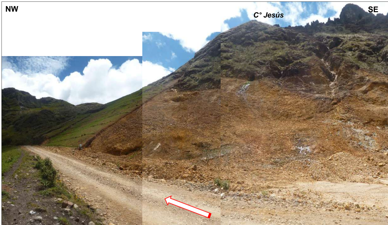
Figura 67. C° Jesús lado NW. Acceso principal a la Qda. Mesa de Plata.
