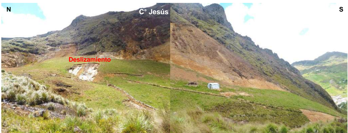
Figura 65. Pasivo Ambiental (sólido) generador de aguas ácidas, constituidos por bloques de cantos, gravas, arena, limos y arcillas en las laderas lado NW, ubicado en la Qda. del C o Jesús.
