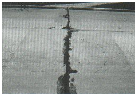
Figura 18: Daño del sello de junta de baja severidad.
