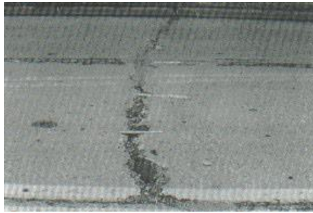
Figura 26: Grietas lineales de alta severidad en losa de concreto simple.
