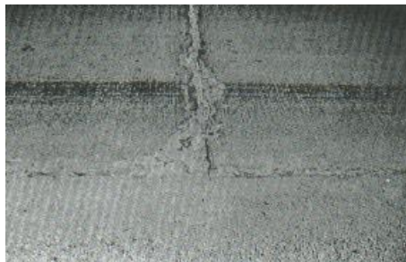
Figura 47: Descascaramiento de esquina de severidad media.
