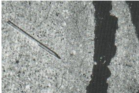
Figura 12: Grieta de durabilidad de baja severidad.
