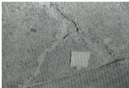
Figura 8: Grieta de esquina de alta severidad.
