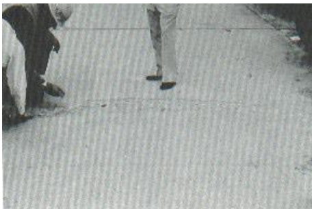
Figura 13: Grieta de durabilidad de severidad media.
