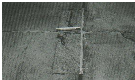
Figura 32: Parche pequeño de alta severidad.
