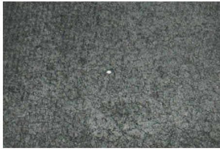
Figura 42: Desconchamiento / Mapa de grietas / Craquelado de baja severidad.
