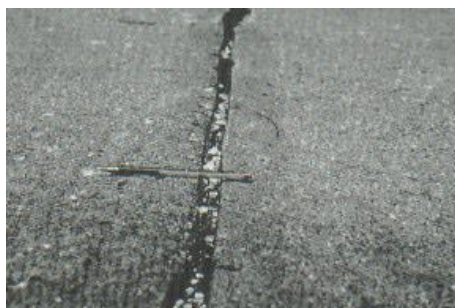
Figura 20: Daño del sello de junta de alta severidad.
