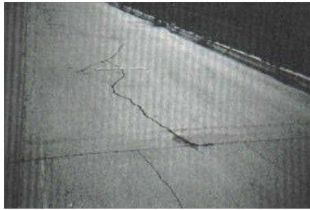
Figura 10: Losa dividida de severidad media.
