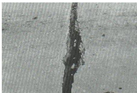
Figura 19: Daño del sello de junta de severidad media.
