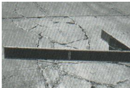
Figura 38: Punzonamiento de alta severidad.
