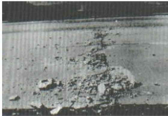
Figura 4: Blowup / Buckling de severidad media.
