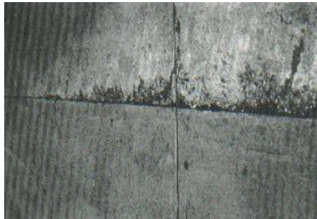
Figura 50: Descascaramiento de junta de severidad media.
