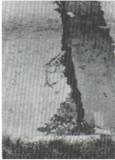
Figura 3: Blowup / Buckling de baja severidad.
