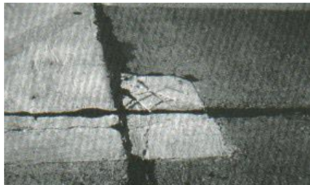
Figura 31: Parche pequeño de severidad media.
