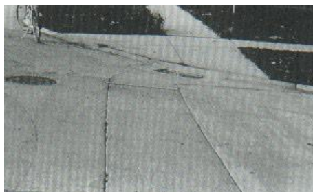
Figura 27: Parche grande y acometidas de servicios públicos de baja severidad.
