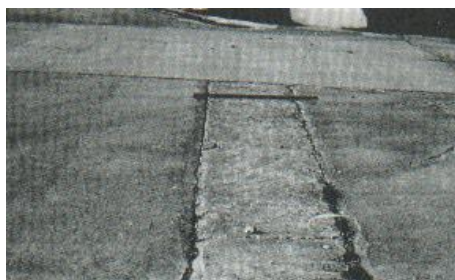
Figura 28: Parche grande y acometida de servicios públicos de severidad media.
