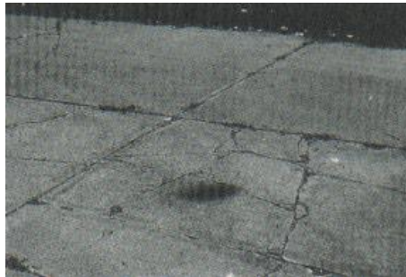
Figura 11: Losa dividida de alta severidad.
