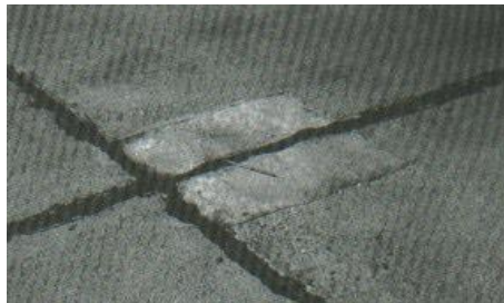
Figura 30: Parche pequeño de baja severidad.
