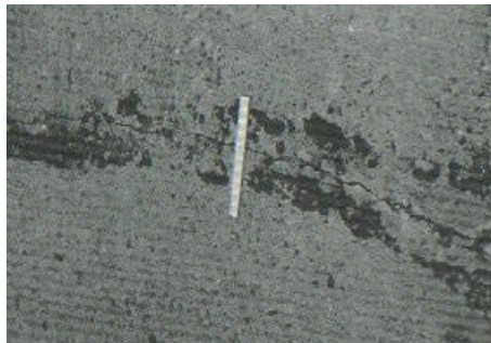
Figura 24: Grietas lineales de baja severidad en losa de concreto simple.
