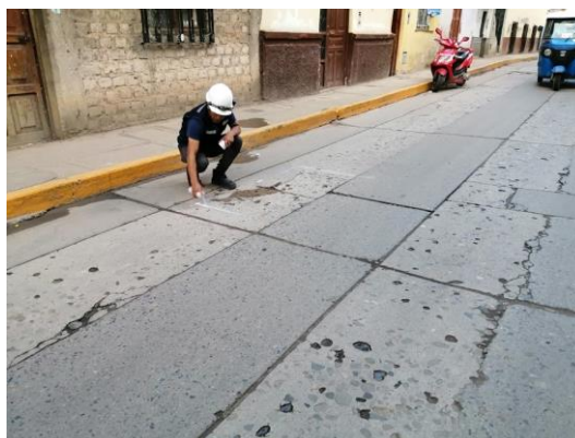
Foto N° 50: En la fotografía se aprecia una grieta longitudinal alta además de las fallas tipo popouts.
