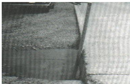
Figura 23: Desnivel carril / berma de alta severidad.
