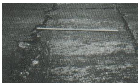
Figura 29: Parche grande y acometidas de servicios públicos de alta severidad.
