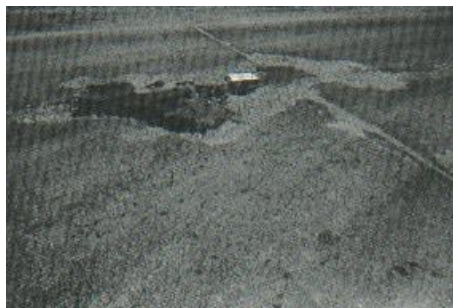
Figura 44: Desconchamiento / Mapa de grietas / Craquelado de alta severidad.
