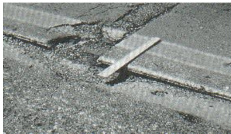
Figura 21: Desnivel carril / berma de baja severidad.
