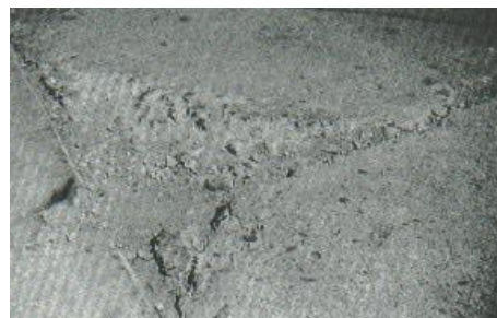
Figura 48: Descascaramiento de esquina de alta severidad.
