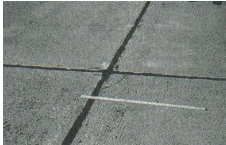
Figura 46: Descascaramiento de esquina de baja severidad.
