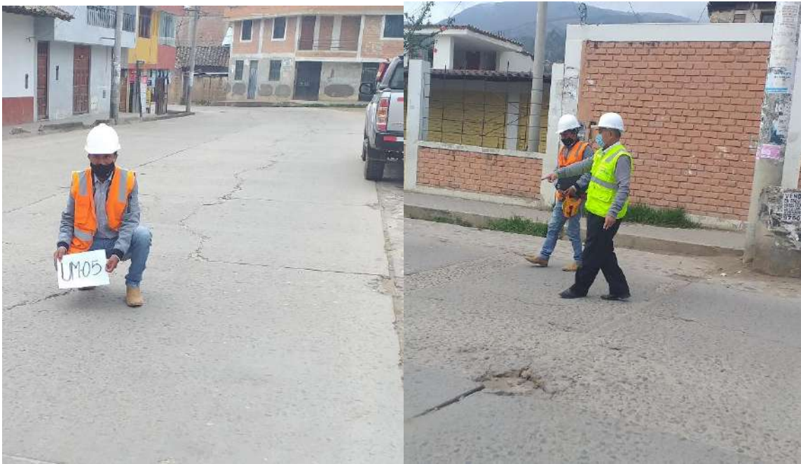
Fallas: Grieta longitudinal y pulimiento de agregados.
