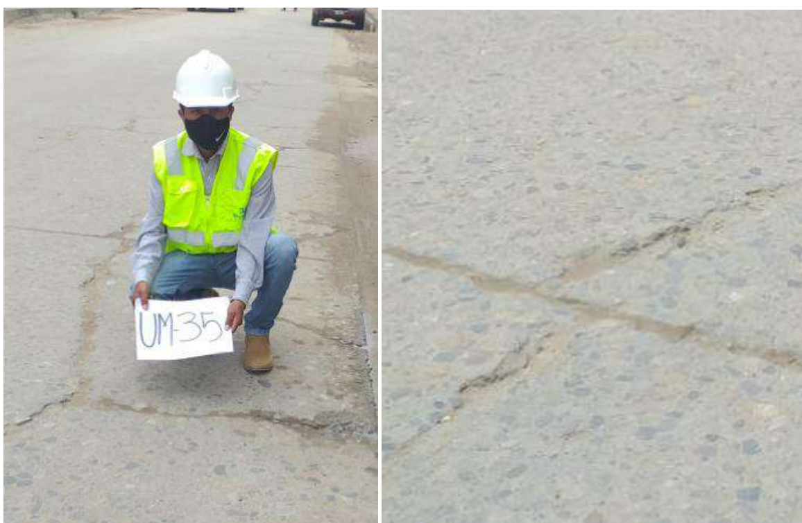
Fallas: Losa dividida y grieta transversal.
