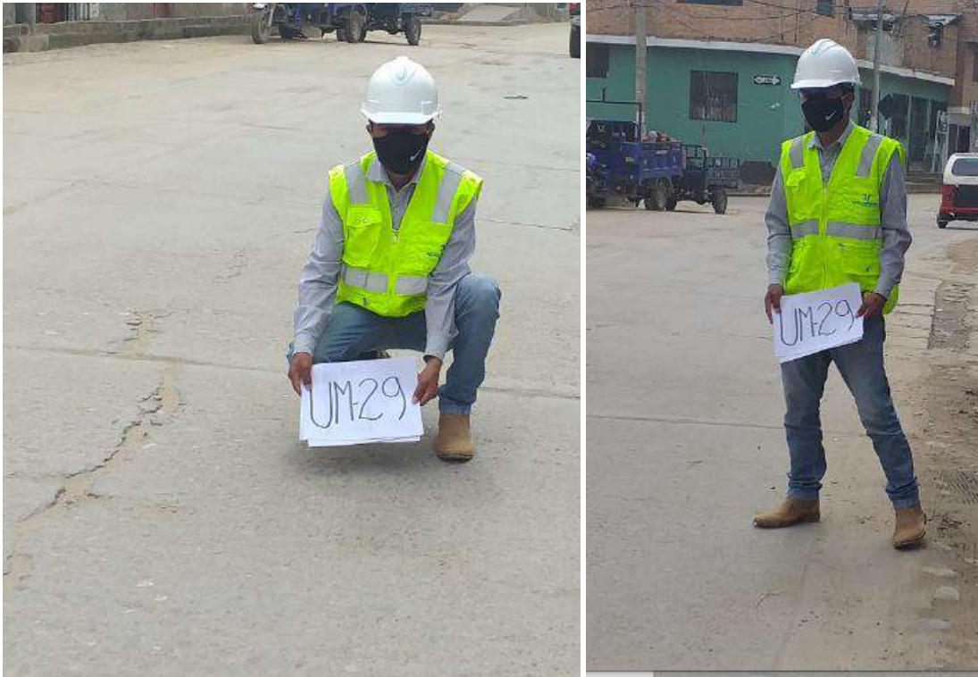
Fallas: Grieta longitudinal y parche grande.
