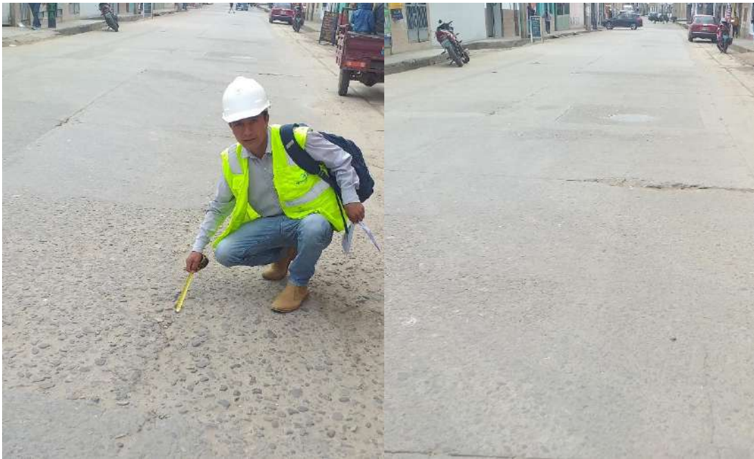
Fallas: Pulimiento de agregados y grietas de retracción.
