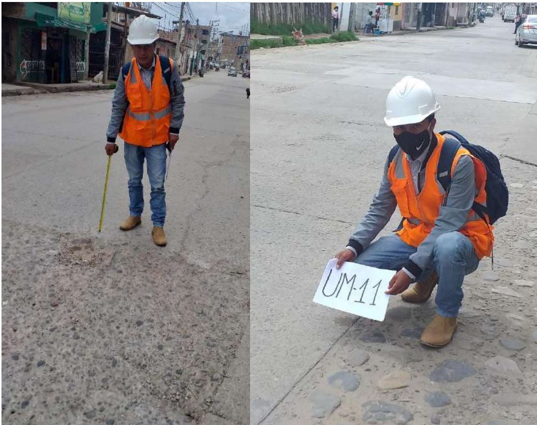
Fallas: Parche grande y pulimiento de agregados.
