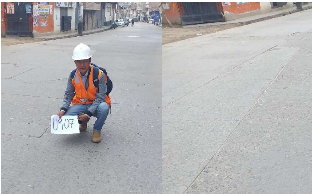
Fallas: Pulimiento de agregados y parche grande.
