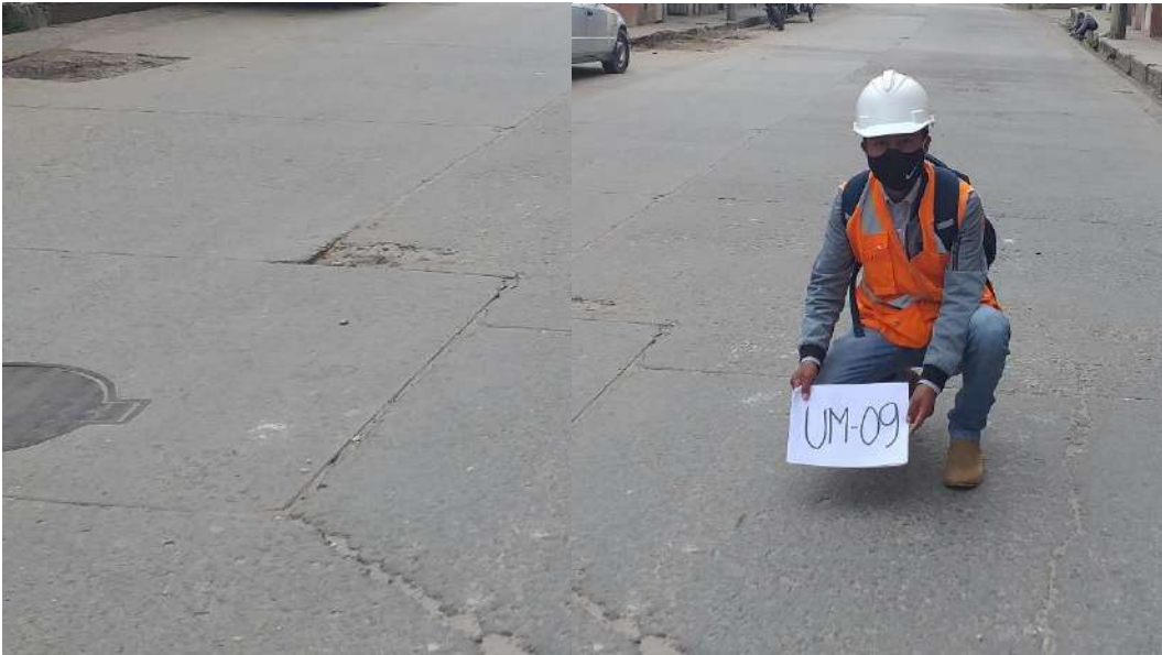
Fallas: Pulimiento de agregados y descascaramiento de esquina.
