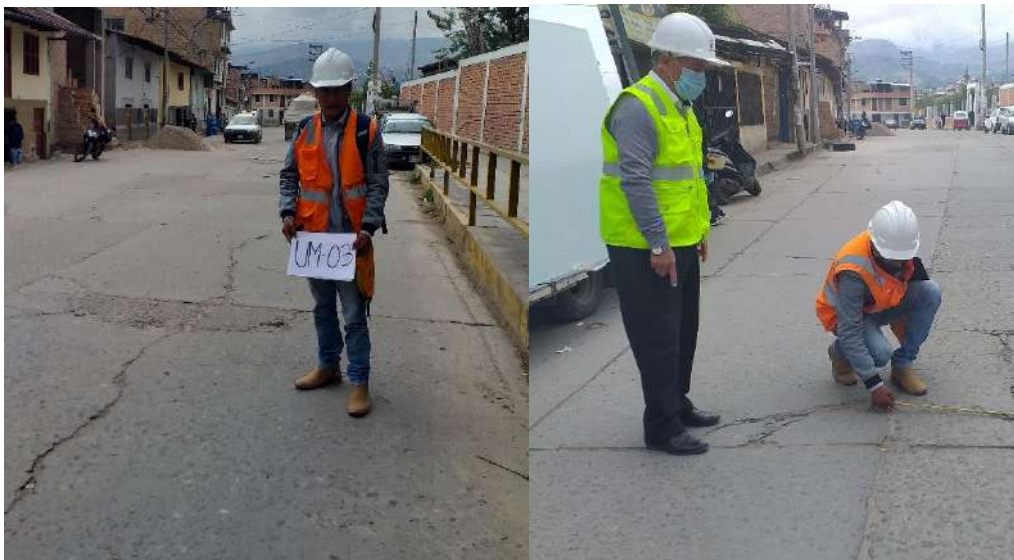
Fallas: Grieta longitudinal y grieta de esquina.
