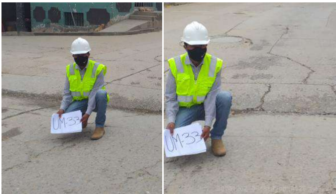
Fallas: Grieta longitudinal y losa dividida.
