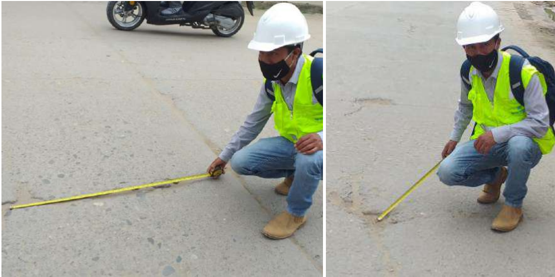
Fallas: Descascaramiento de junta y grieta longitudinal.
