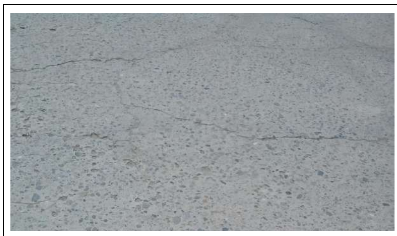
Figura N° 25: Fisuras de contracción.
