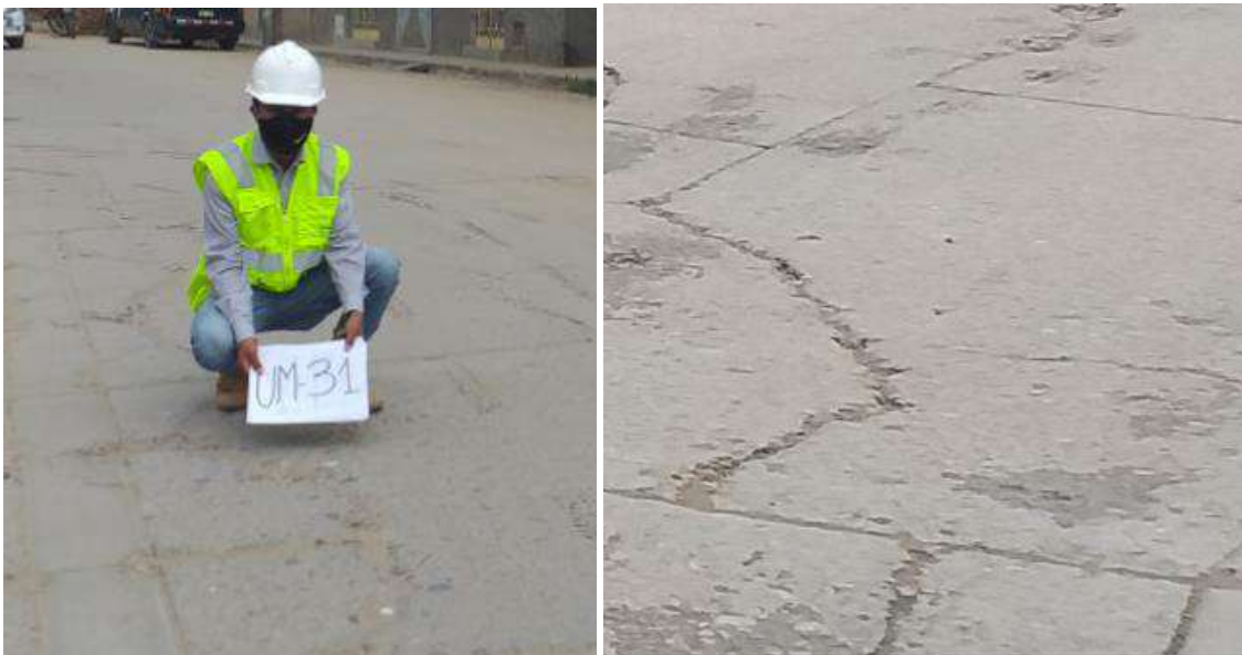
Fallas: Grieta longitudinal y grieta de esquina.
