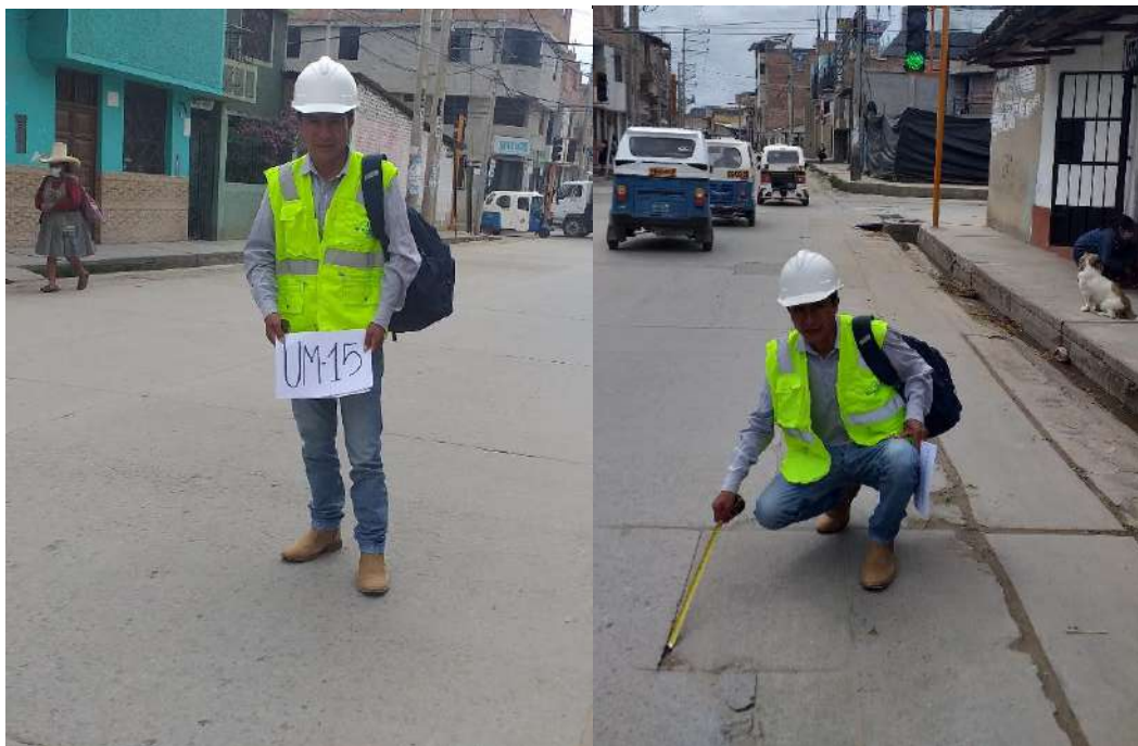
Fallas: Grietas de retracción y parche grande.
