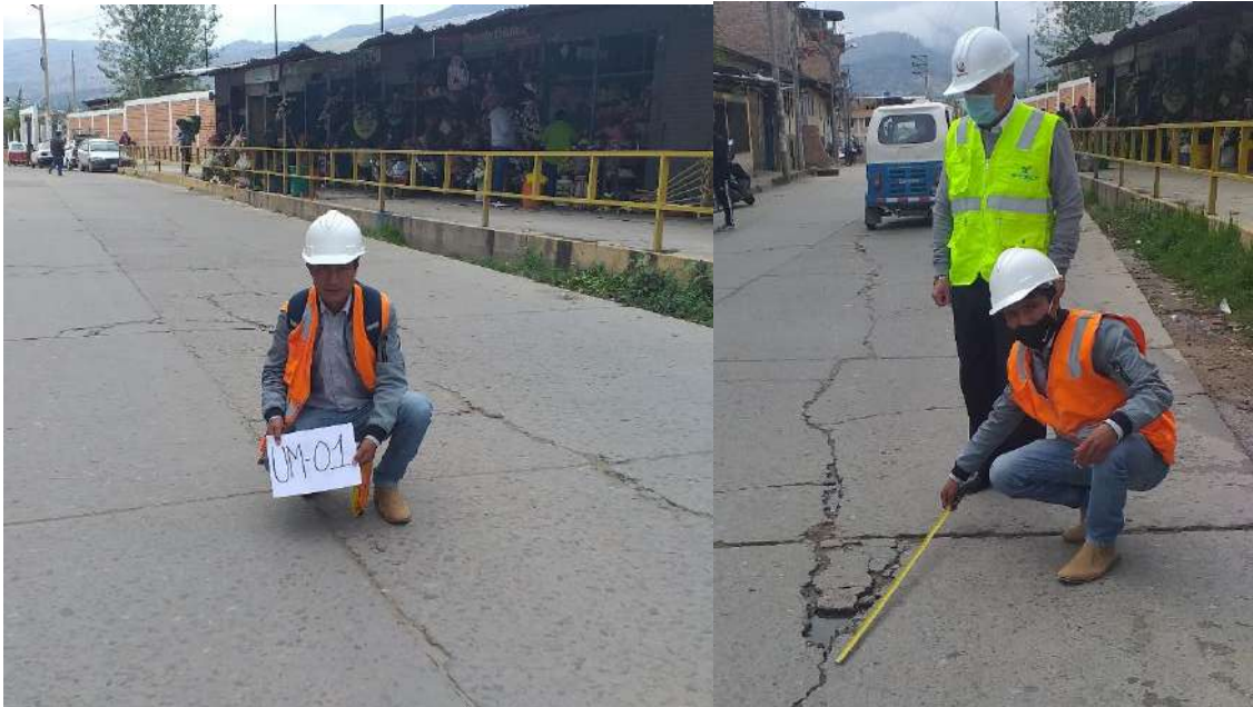
Fallas: Pulimiento de agregados y grieta longitudinal.
