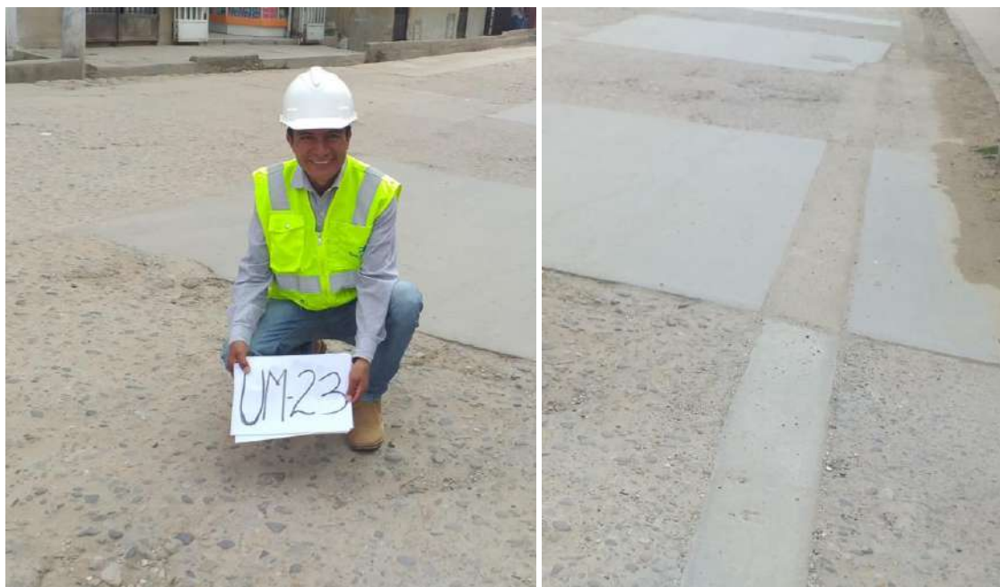
Fallas: Pulimiento de agregados y parche grande.
