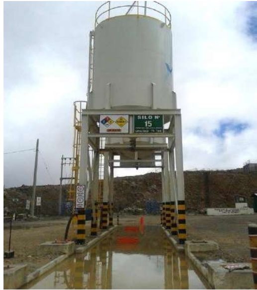
Figura 30: Silo de emulsión matriz, Minera Yanacocha
