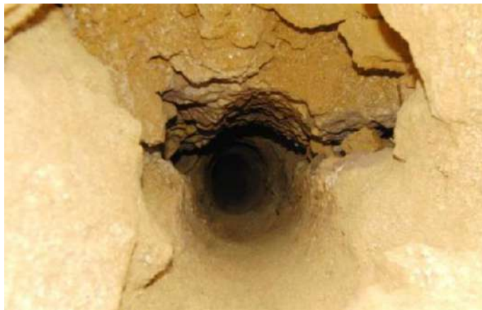
Figura 23: Plano de falla producido por los taladros de pre corte. (Yanacocha, 2015)
