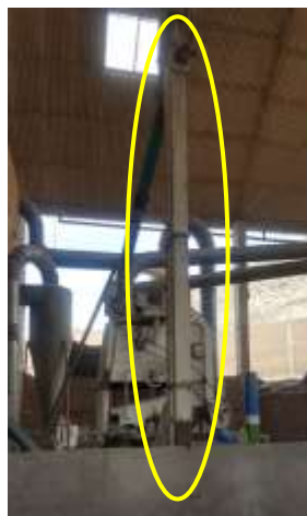
Elevador del arroz en cáscara a la máquina de limpieza (Molino San Francisco).
