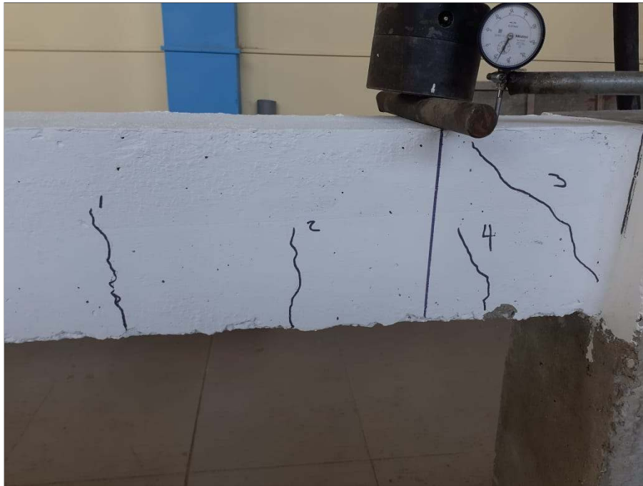
Fotografía N°14. Falla al Corte de Viga de Concreto Armado.
