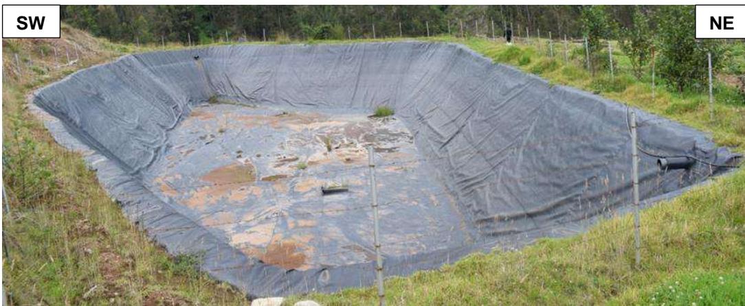
Foto 18. En la parte alta del terreno afectado existe un reservorio que se utilizaba para almacenar agua en época de lluvia. El peso del agua acumulado en este reservorio, más la infiltración producida por la rotura de la geomembrana han sido factores detonante en la generación del deslizamiento Huambocancha.
