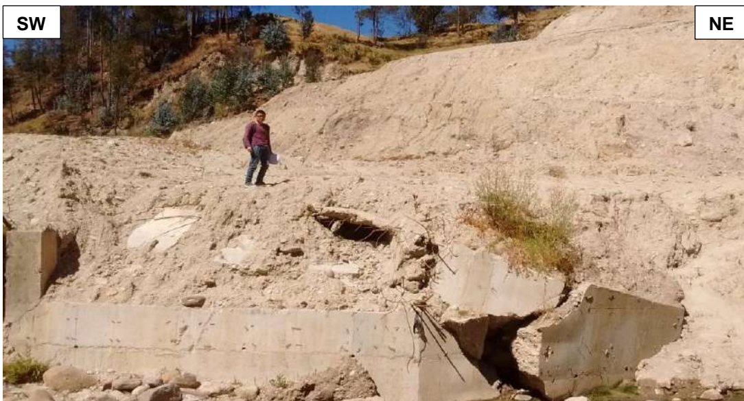
Foto 22. La gran cantidad de energía del deslizamiento ha destruido parte de los muros de sostenimiento de concreto
