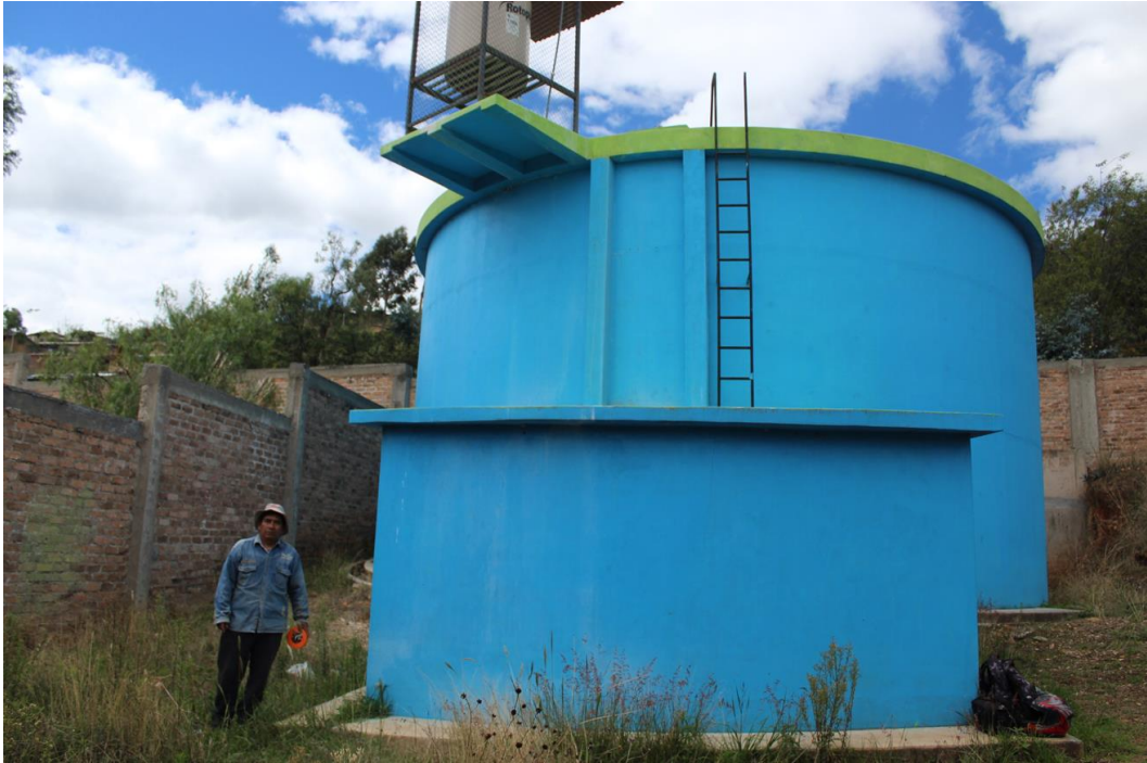
Foto N° 16: Vista del Reservorio Circular de 750 m3 que abastece al Sector 1
