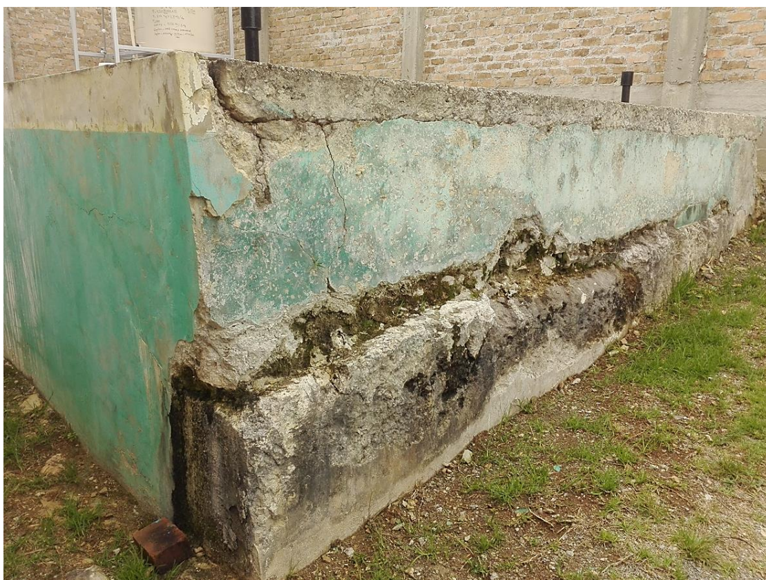
Foto N° 07: Vista del mal estado del Reservorio 2-A
