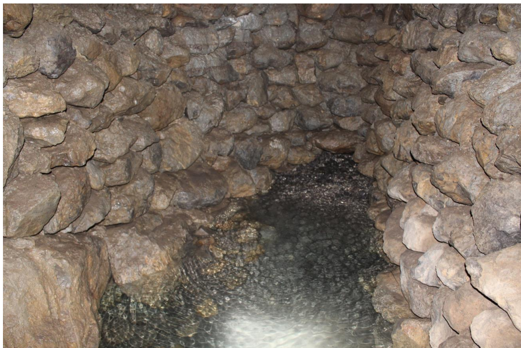
Foto N° 11: Vista interior de la captación de manantial “La Huanga Negra”
