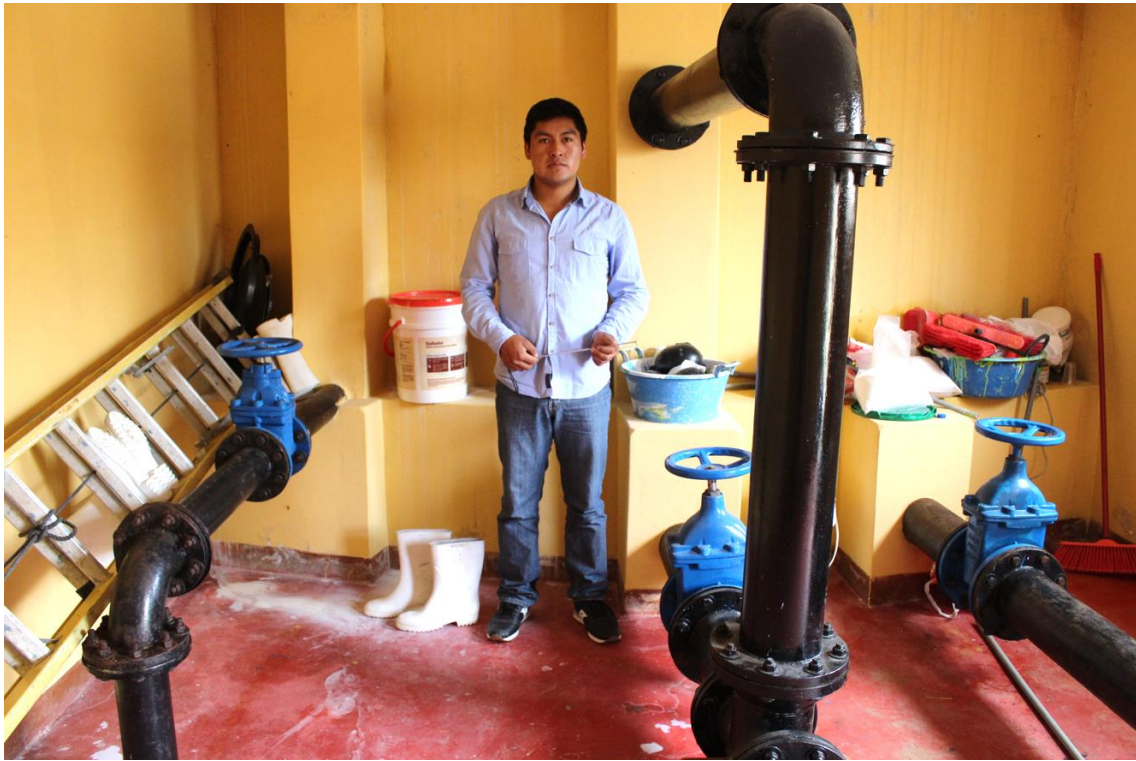
Foto N° 20: Llaves de control de los reservorios de la localidad de Jesús
