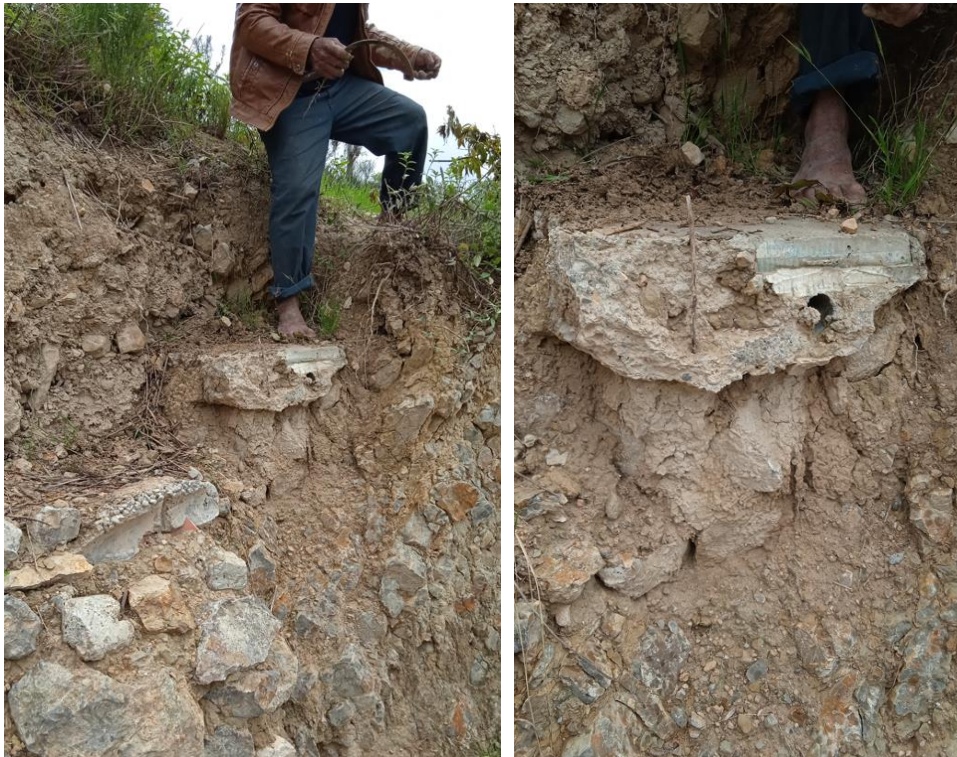
Foto N° 15: Vista de la válvula de aire en la progresiva < 00+974 >
