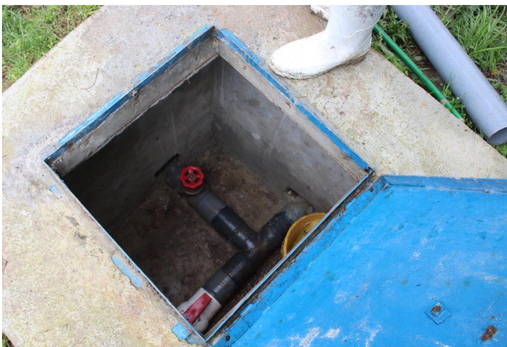
Foto N° 04: Caja de llaves, al inicio de la línea de conducción.
