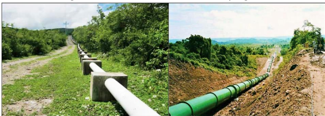
Figura 07: Tuberías en línea de conducción por gravedad.
