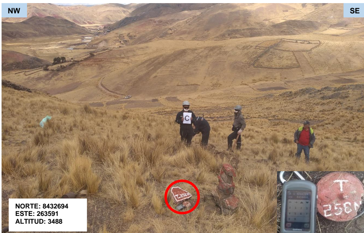
Foto 18: Ubicación de la T – 256N, el círculo rojo viene a hacer el centro donde se cimentará la estructura de la Torre.
