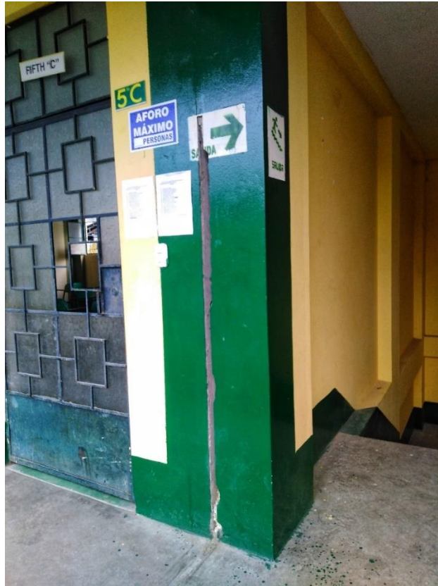
Fotografía 11. Fisura en tarrajeo de junta sísmica.
